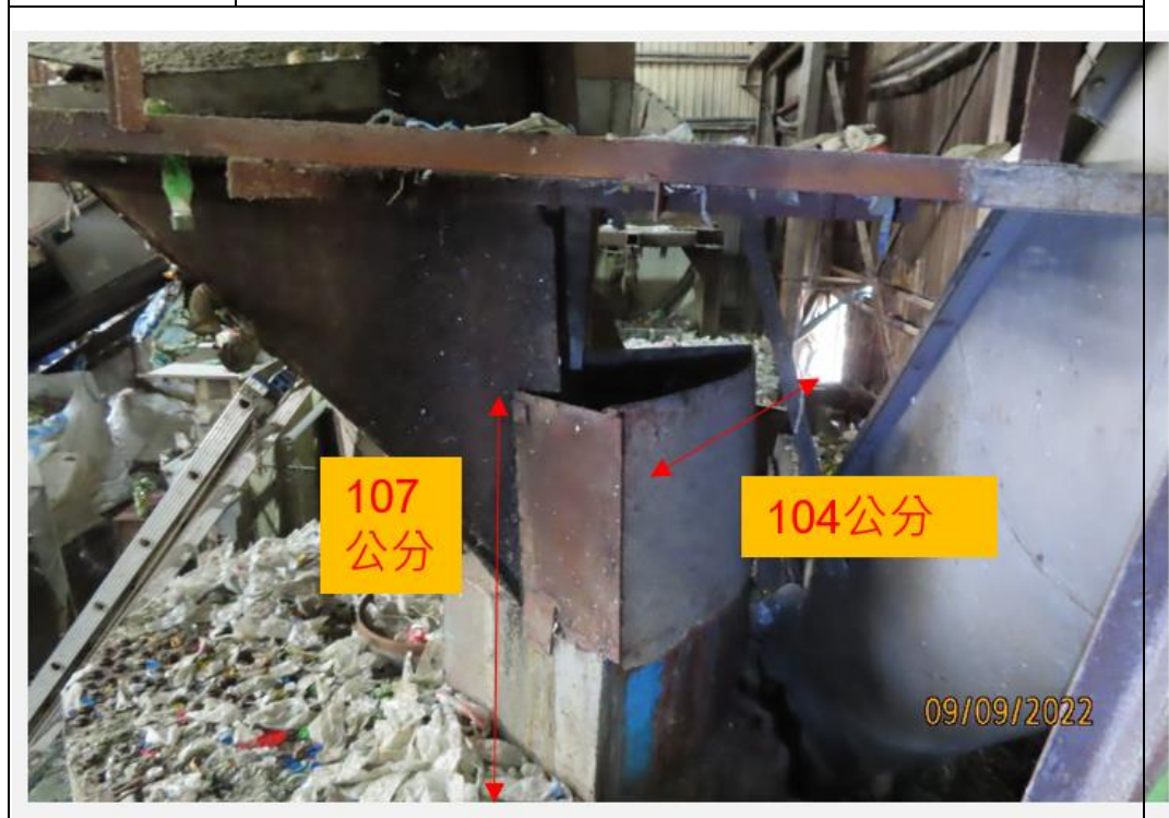
照片 6 肇災脫標機入料口四周設有護圍(具高度約 107 公分、寬度約 104 公分)
