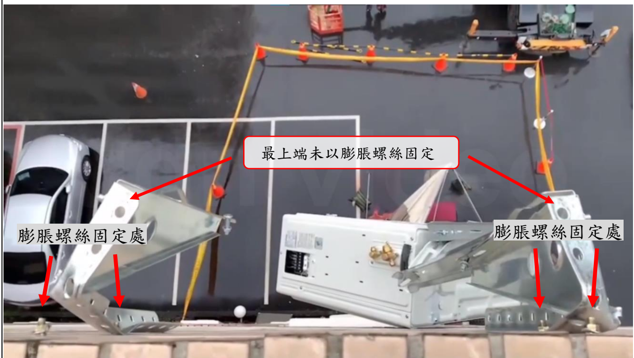
冷氣機支撐架尺寸規格 50 公分 x55 公分，支撐架僅以 2 根膨脹螺絲 照片 2 固定於牆面（支撐架最上端未以膨脹螺絲固定），支撐架因無法承受重量而變形彎曲。
