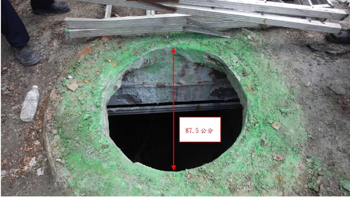
照片 1 災害現場照片，因原料槽移除後造成地面有一直徑 87.5 公分之開口。
