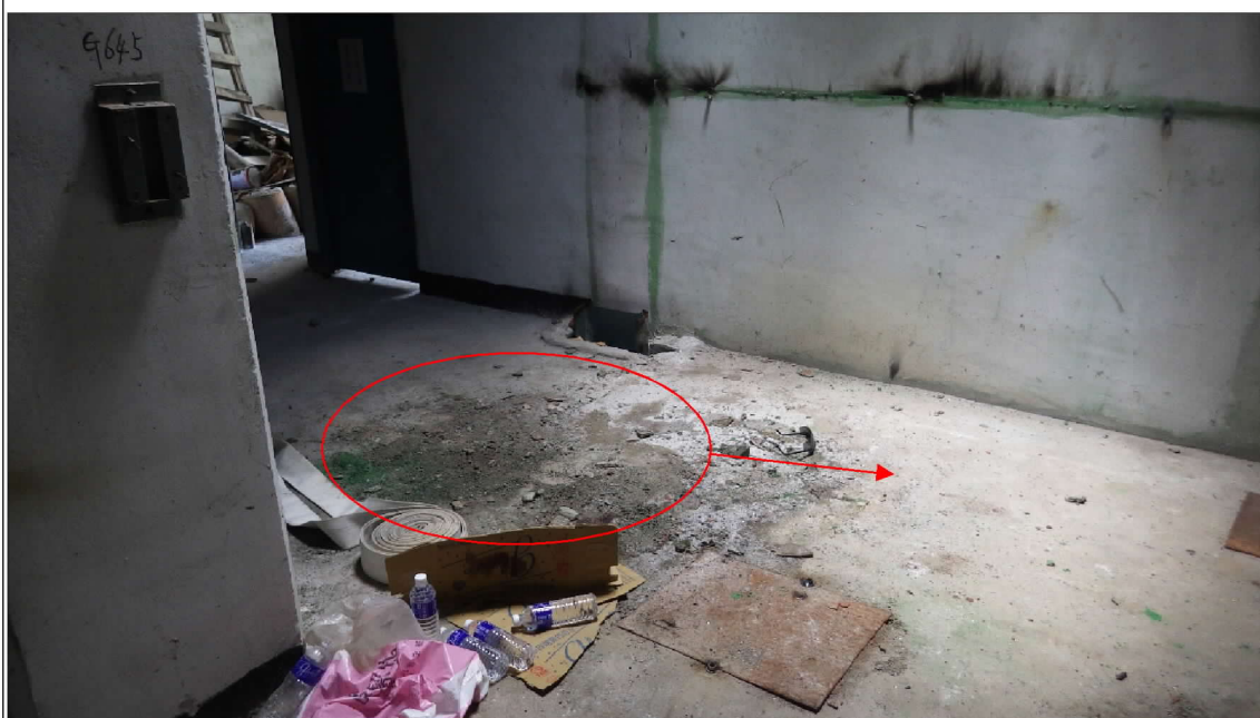
照片 2 災害現場照片，罹災者自 4 樓地面之開口墜落至 3 樓地板，墜落高度約 4.37 公尺。
