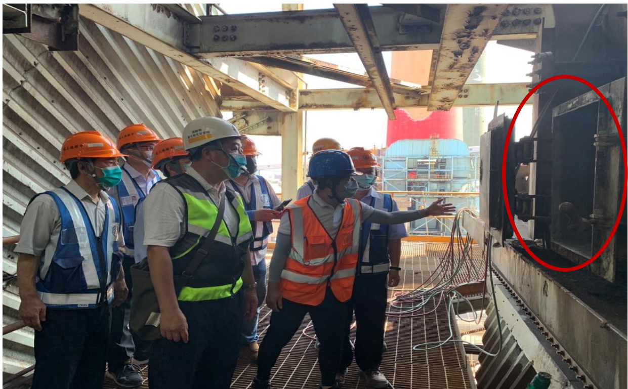
台中電廠工程 Reheater 區局限空間作業場所入口無禁止進入標示，未採取上鎖或阻隔人員進入等管制措施。
