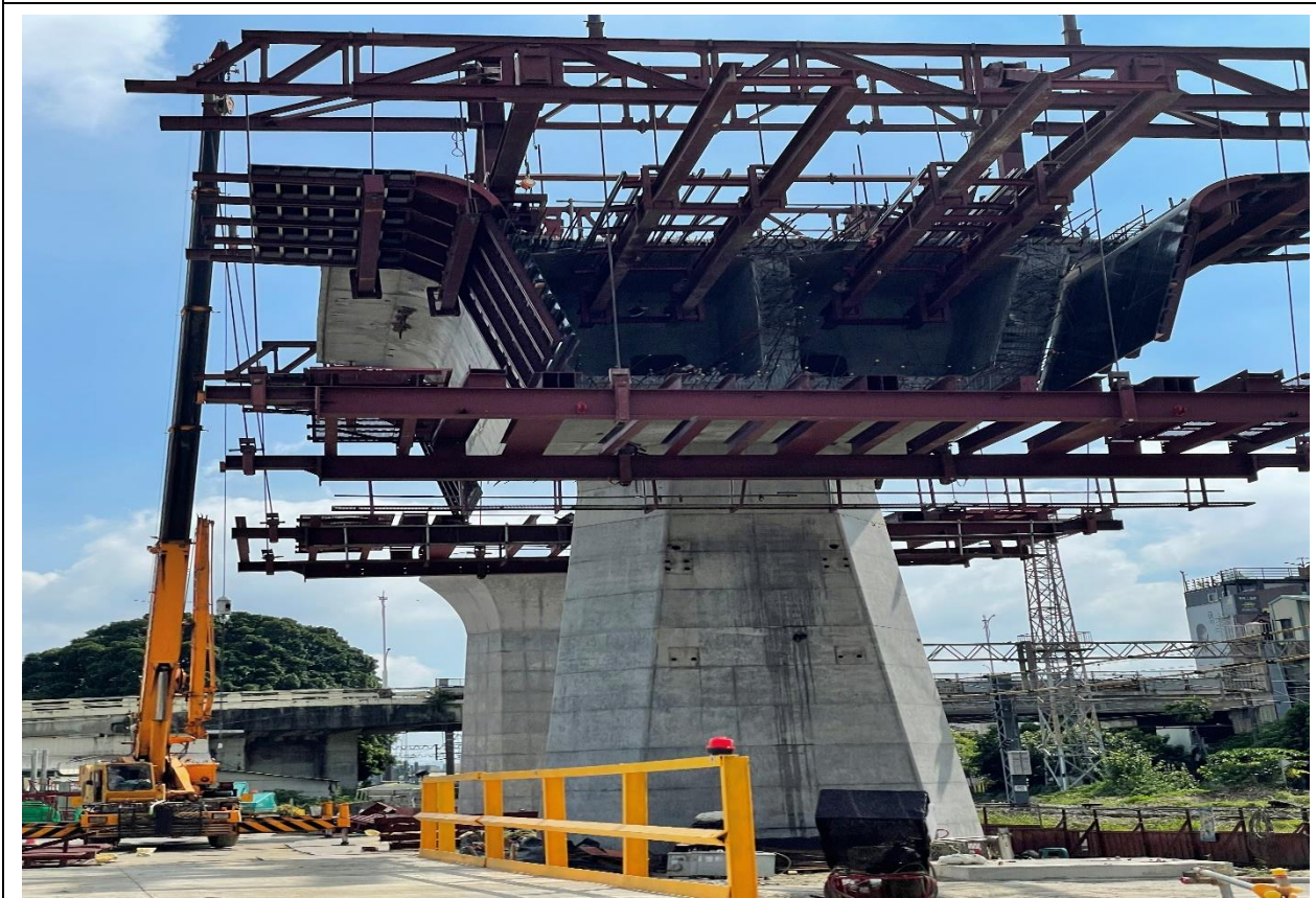
嘉義鐵路高架工程之開口部分未有防墜設施。
