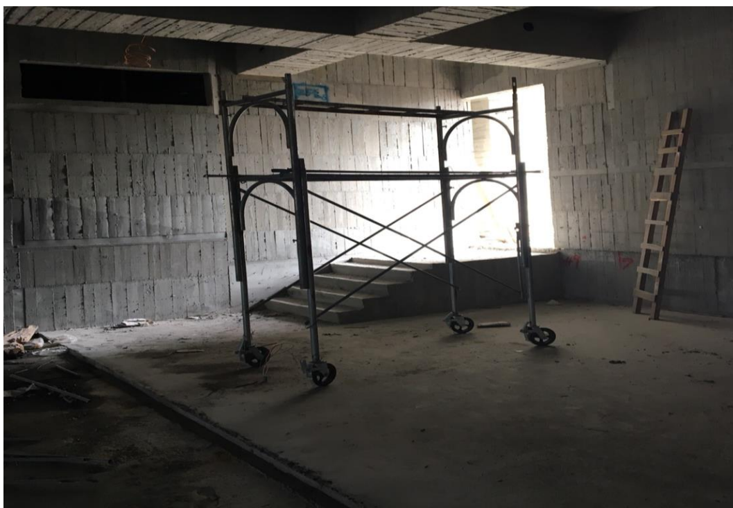
照片 5：移動式施工架無上下設備
