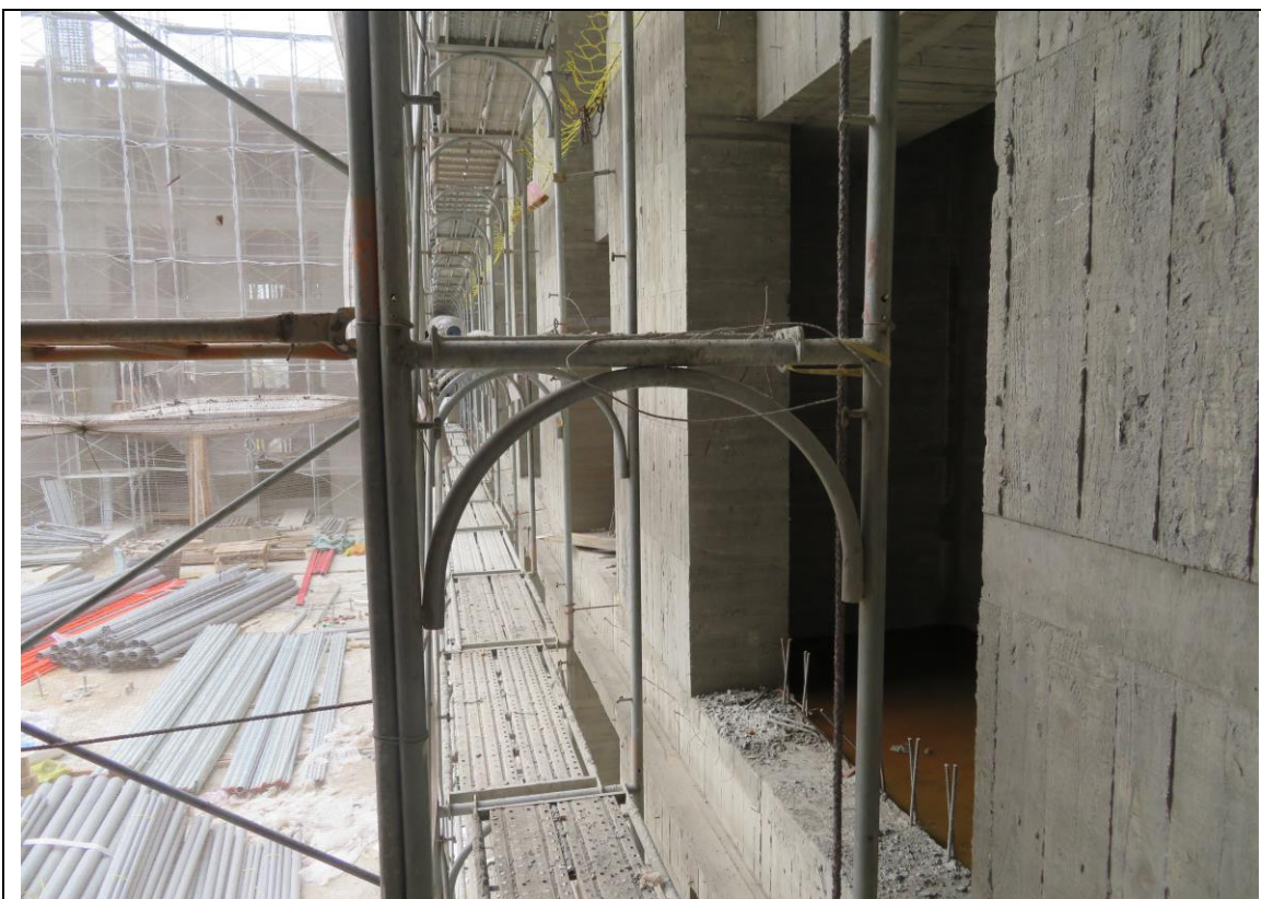
照片 1：架未設置內側交叉拉桿及內外側交叉拉桿
