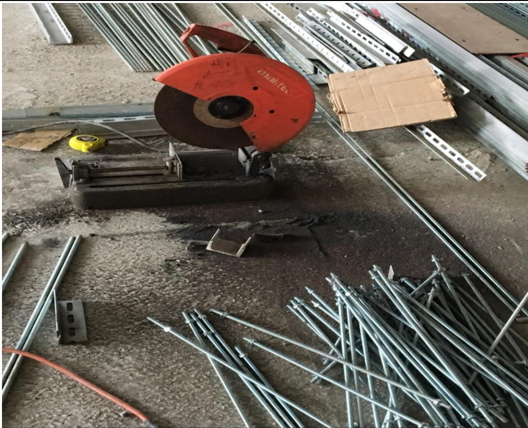
照片 3：圓盤鋸無安全設備
