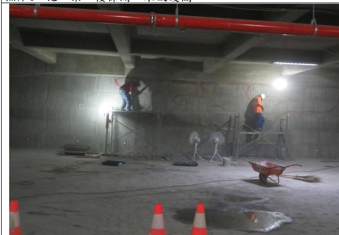
照片 2：地下室打石作業未設上下設備
