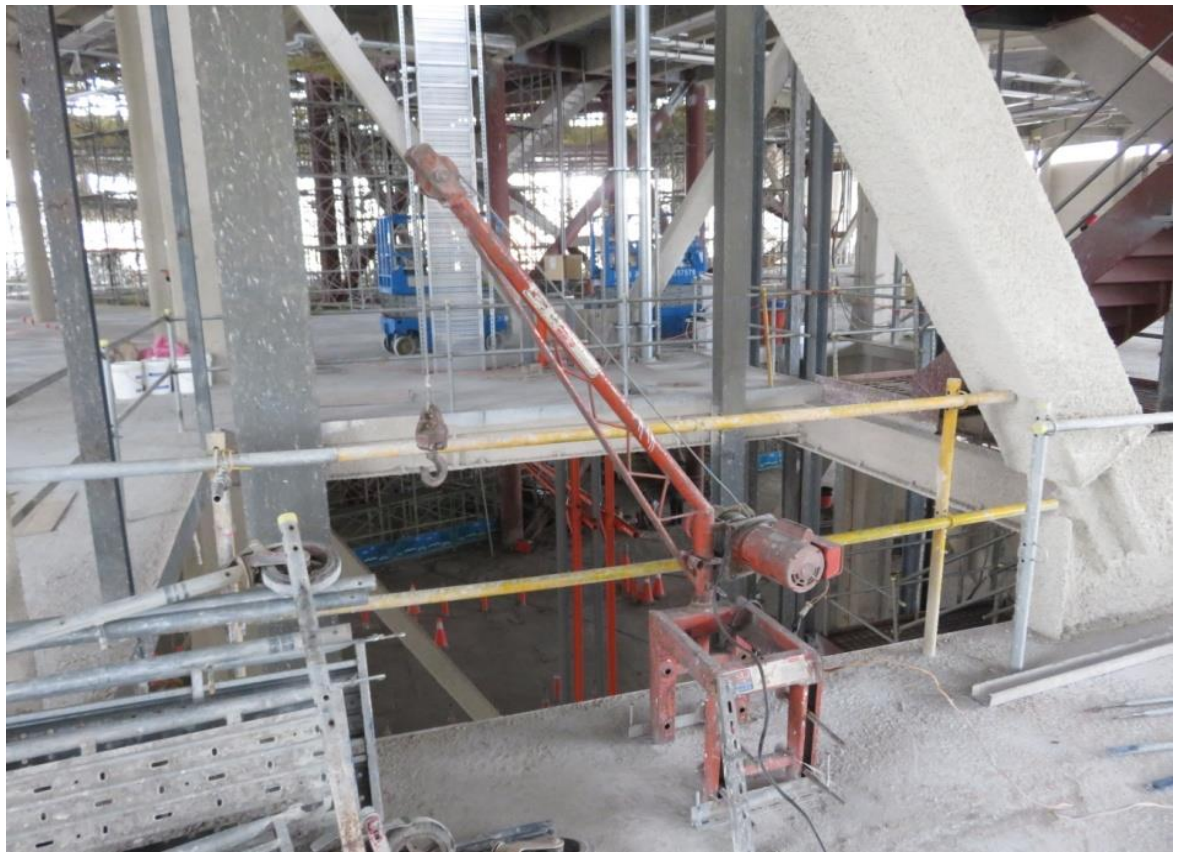
照片 5：吊料捲揚機未有防滑舌片及過捲揚裝置。
