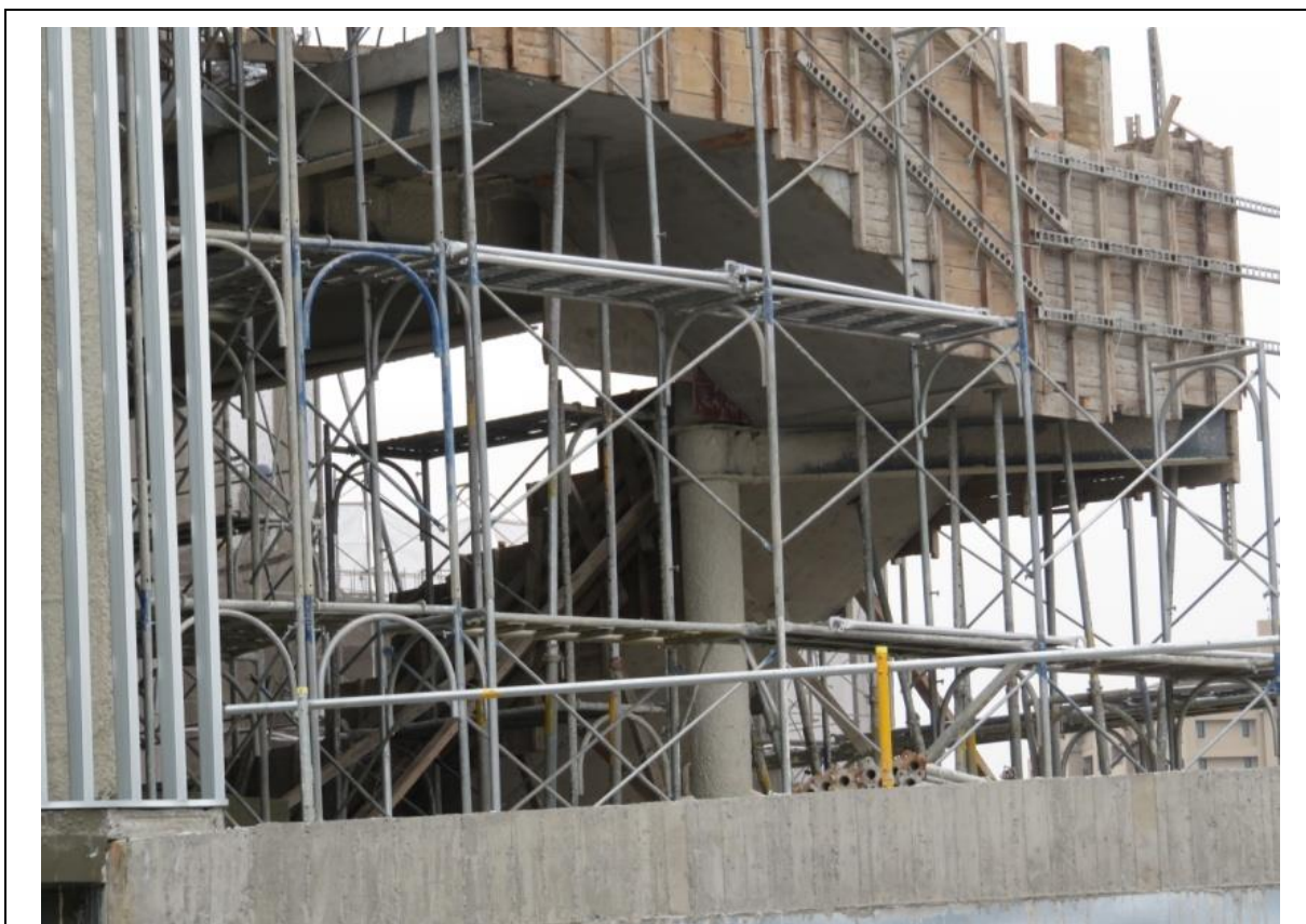
照片 1：施工架、樓梯開口未設護欄
