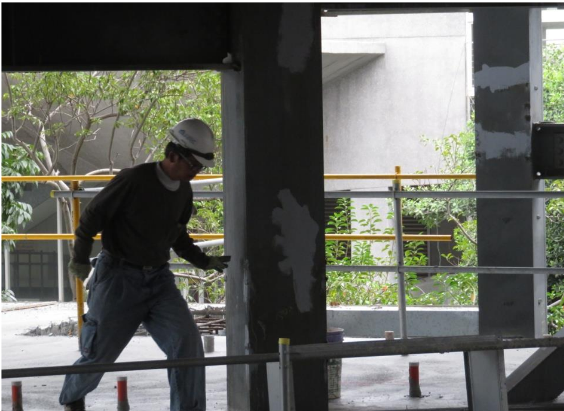
照片 8：作業人員安全帽未使用頤帶。
