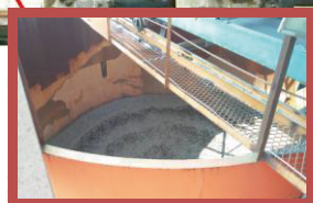
儲存槽 掩埋、墜落
