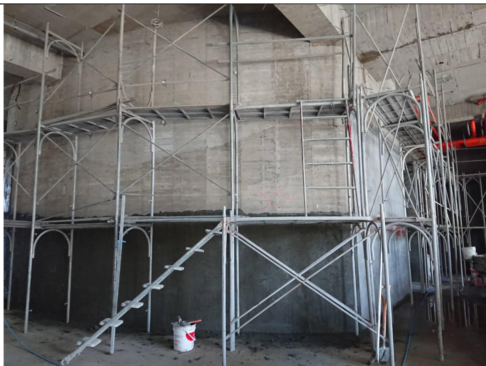
發現工地高度 2 公尺以上之施工架工作臺未設置護欄之缺失
