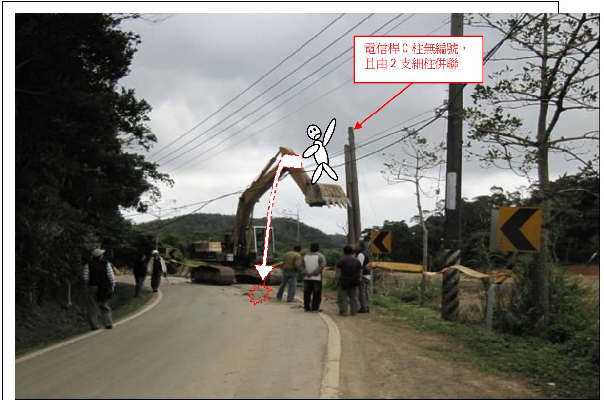
照片一 | 本災害發生於本工程之工程編號 OK+007 之電信桿 C 柱旁。
