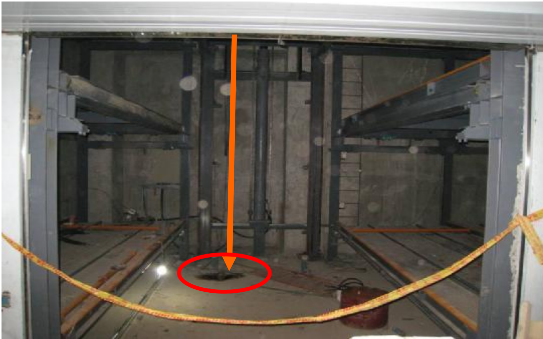
罹災者被發現躺在 B2 停車設備機坑地面上
