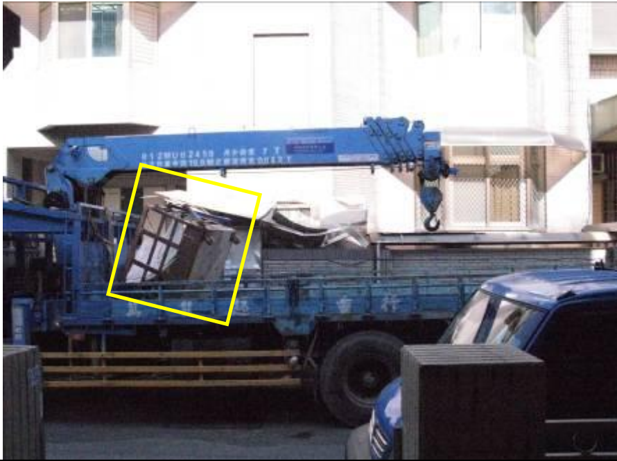
說明 1 吊籃支桿斷裂掉下來，先砸中 1 樓採光罩後掉至吊卡之車斗前端。
