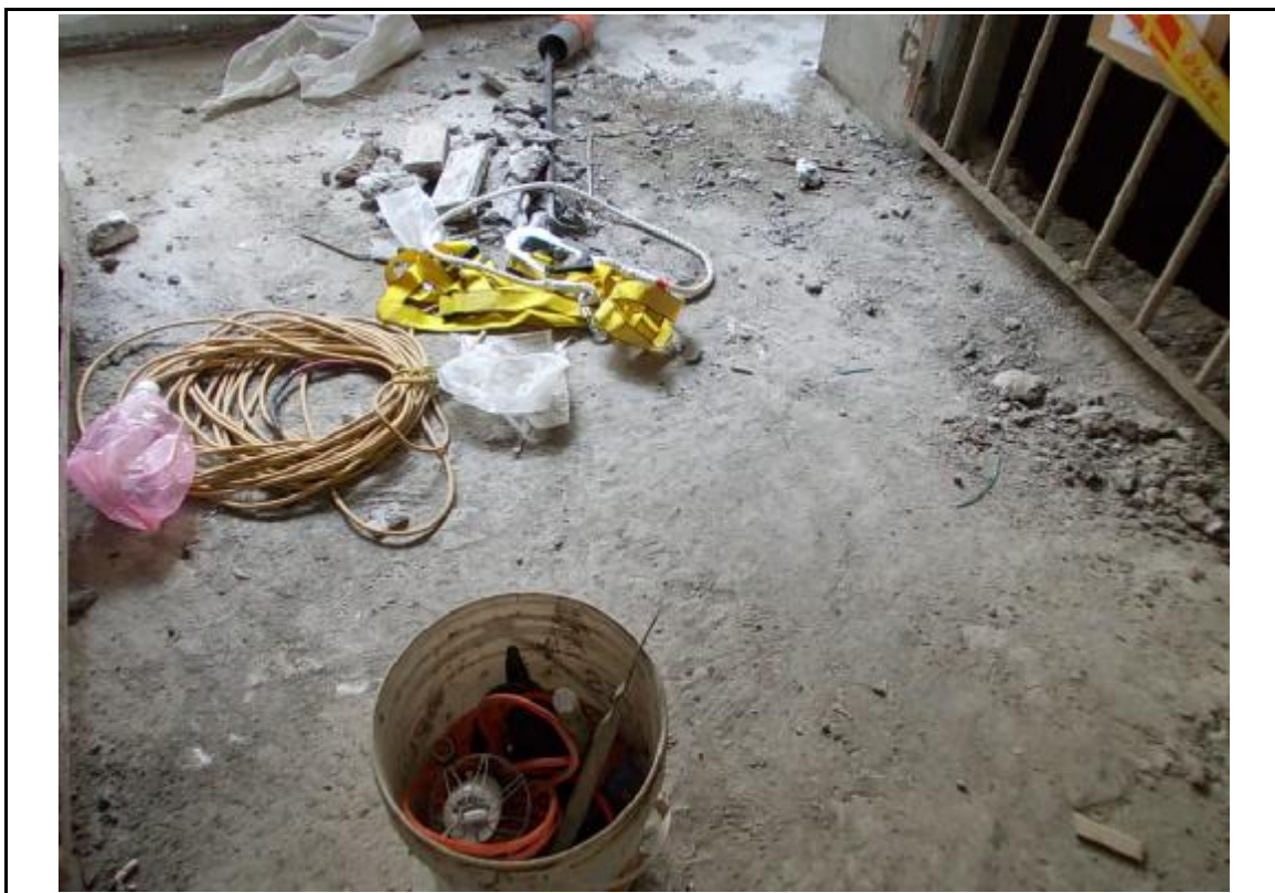
說明 14樓樓板開口旁電梯間，可看到被打除之混凝土渣及工具，另有1條未使用之安全帶。
