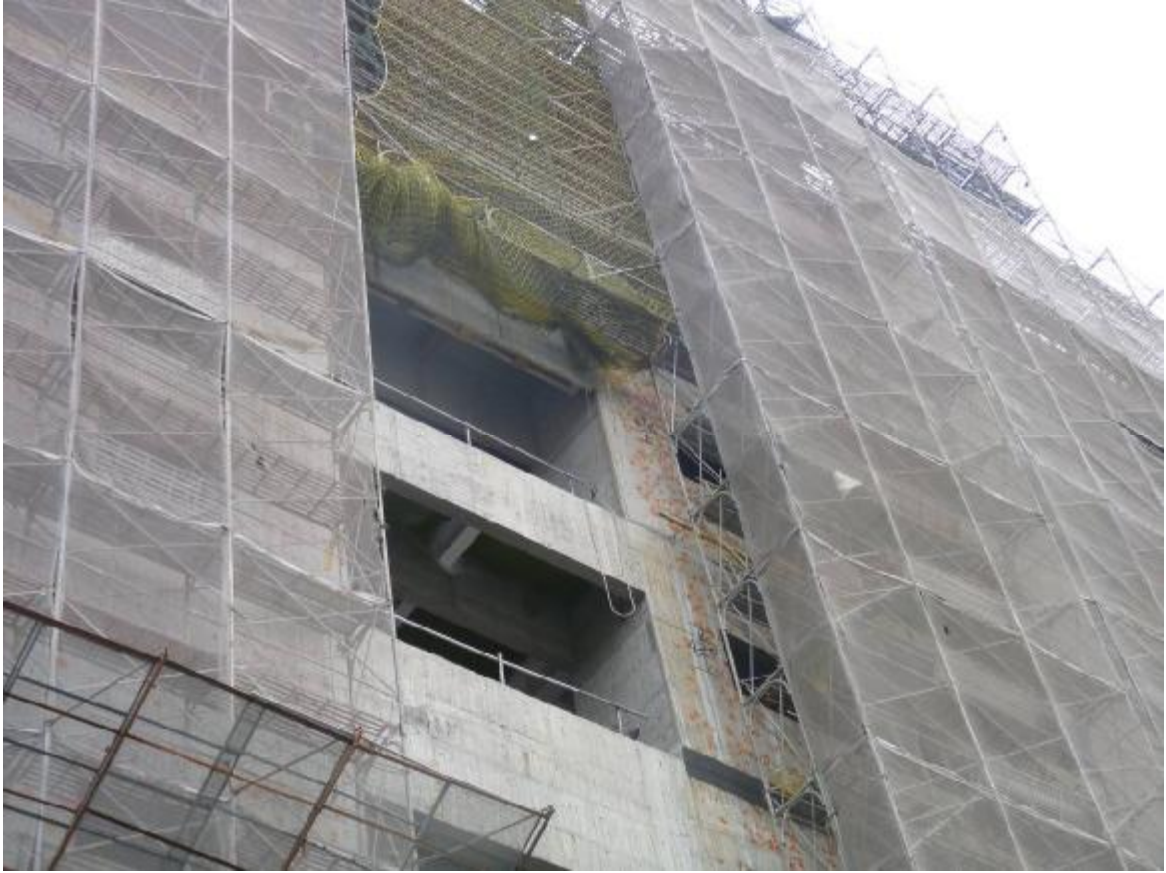
照片 1 罹災者墜落高度約 22 公尺，罹災者墜落前位於 5 樓高處
