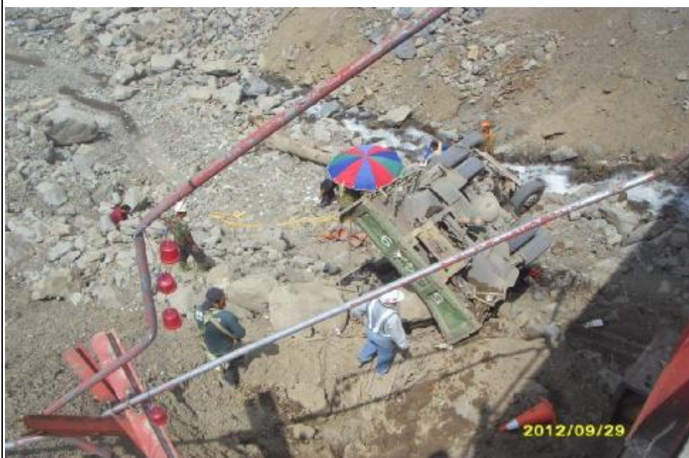
吊卡車翻落鋼棧橋下約 10 公尺處之溪底
