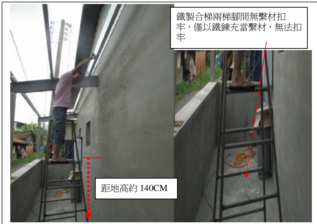
照片 模擬罹災者吳○○站立於鐵製合梯移動變換位置之當時作業情形
