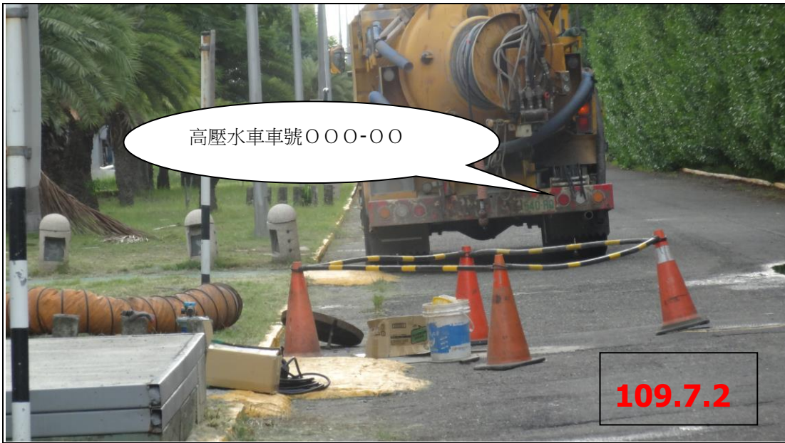
說明 照片 4：肇災時作業之高壓水車(三〇〇〇公司所有)。
