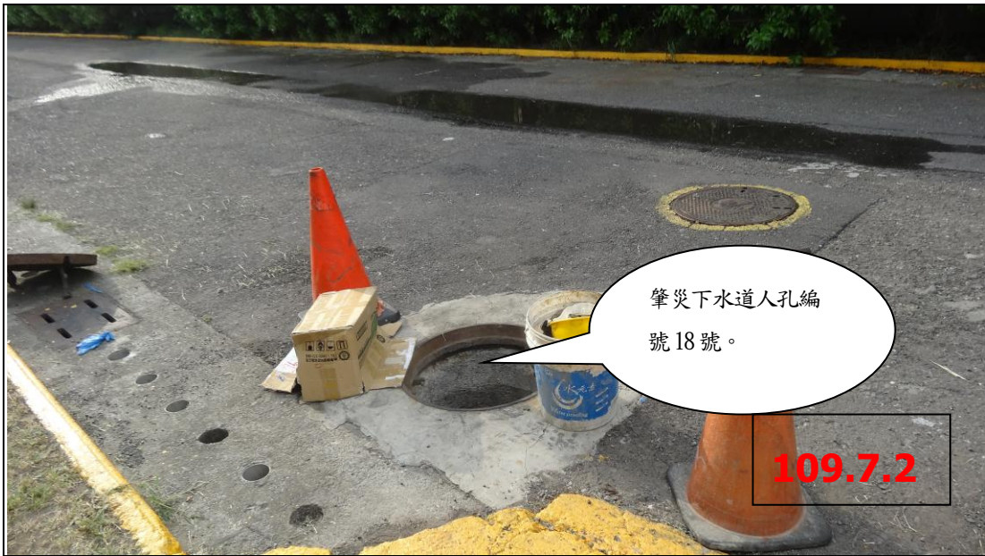
說明 照片 3：該肇災人孔未設置任何通風換氣裝置並採取通風換氣及測定偵測等儀器且未置備供救援人員使用之空氣呼吸器等防護器材。
