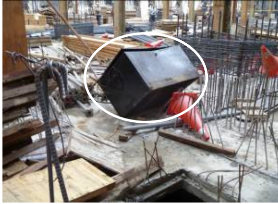
起重機之工具箱掉落至地下6樓壓傷罹災者位置。
