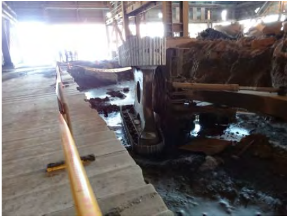
說明 轉爐室內渣場二次冷卻區自設車道未設有護堤
