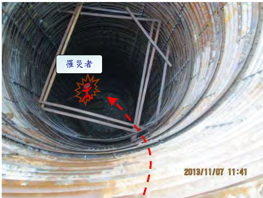
說明五 基樁坑洞現場照片(深度 15 公尺)
