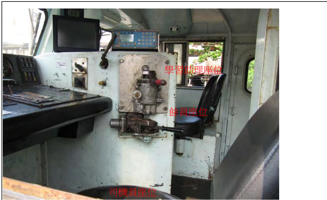
說明 駕駛室未設供站立時扶持之把手等及未有防止人員於乘坐或站立時摔落之防護措施。
