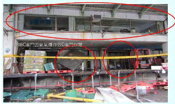
災害現場1樓及夾層外觀
