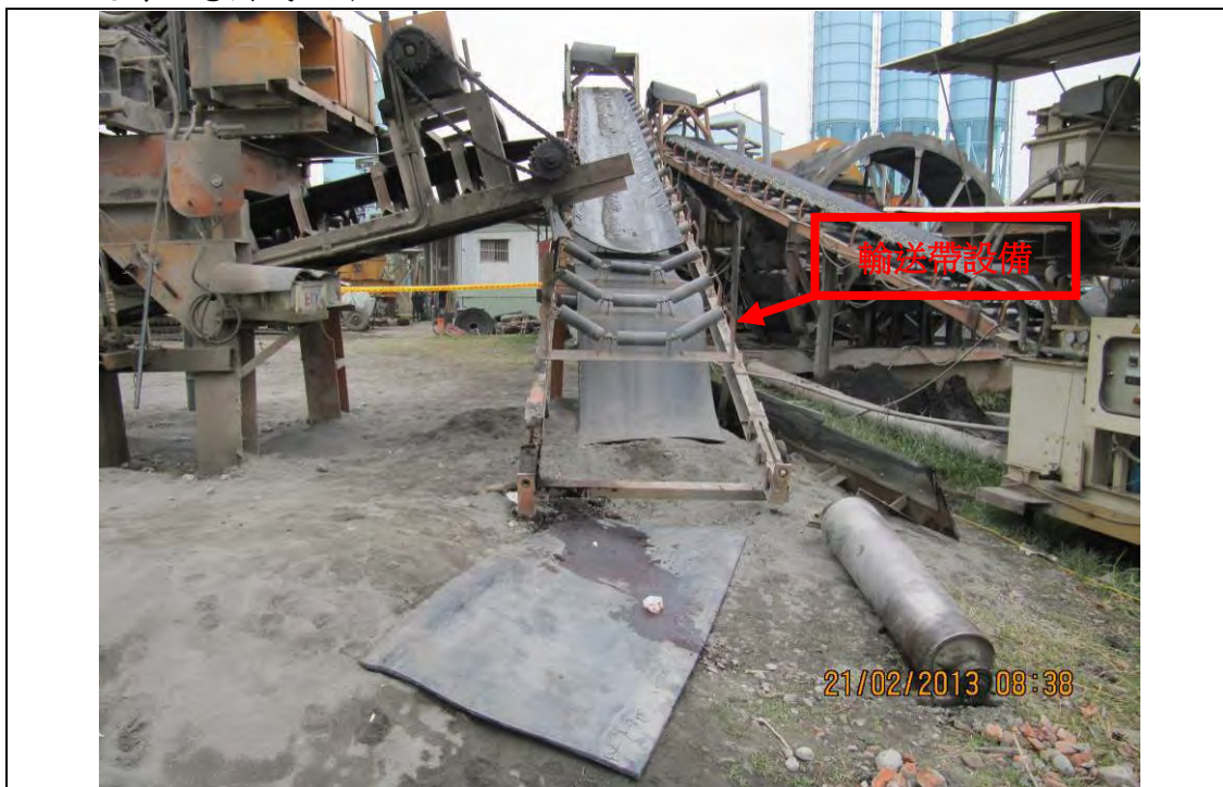
說明 照片 1： 肇災之廠內碎石作業區輸送帶設備。
