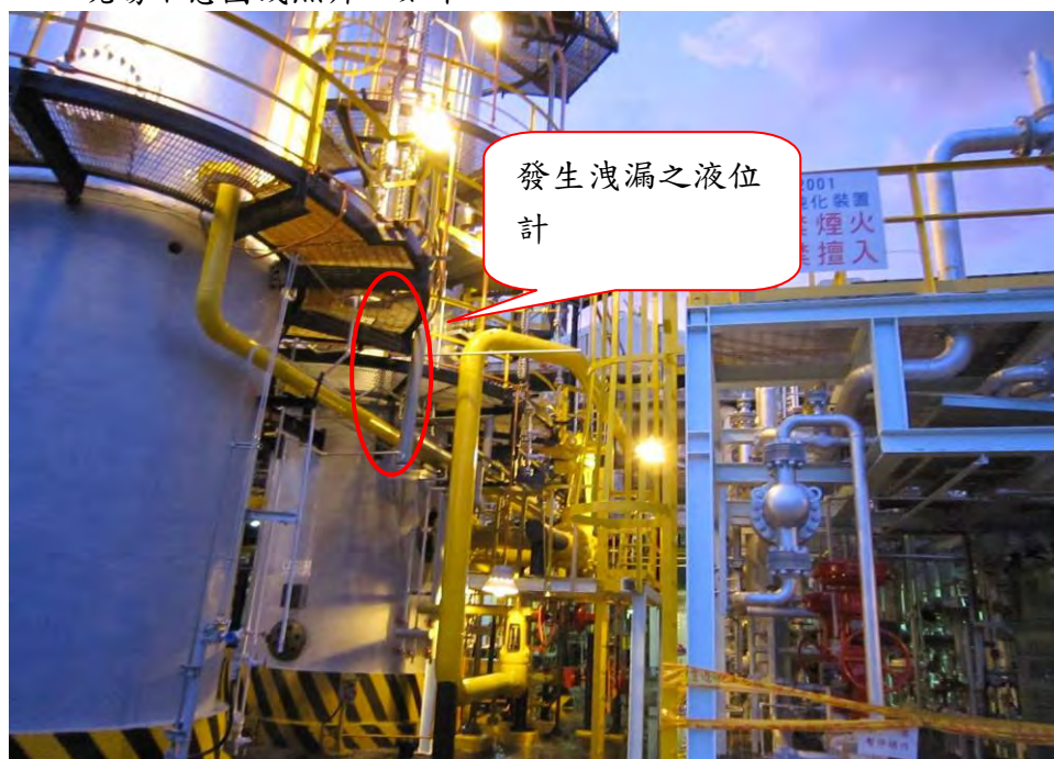
照片 1 發生洩漏之液位計。
