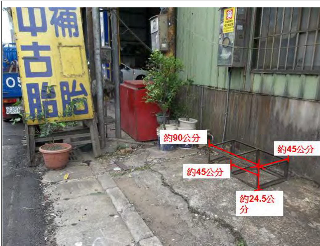
說明四 廣告招牌支架之延伸支架掉落之位置
