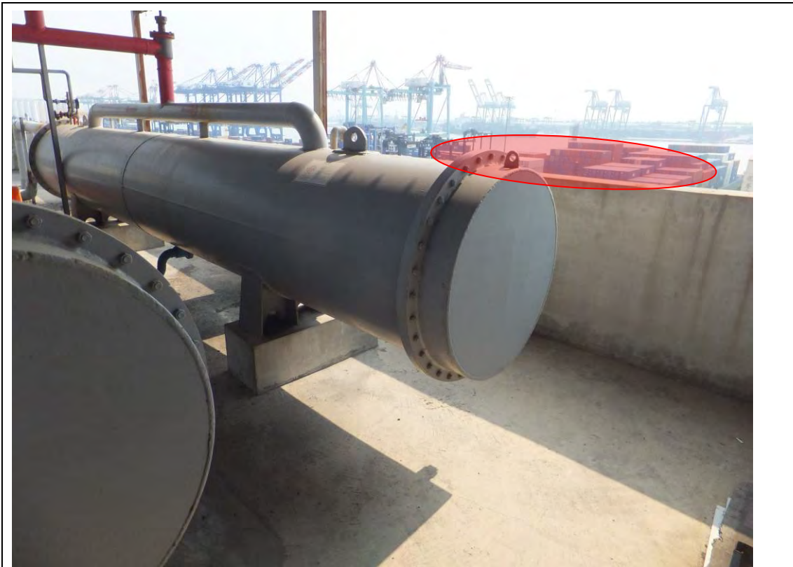
說明 3 | 墜落位置相對於頂樓女兒牆之位置(紅框處)。
