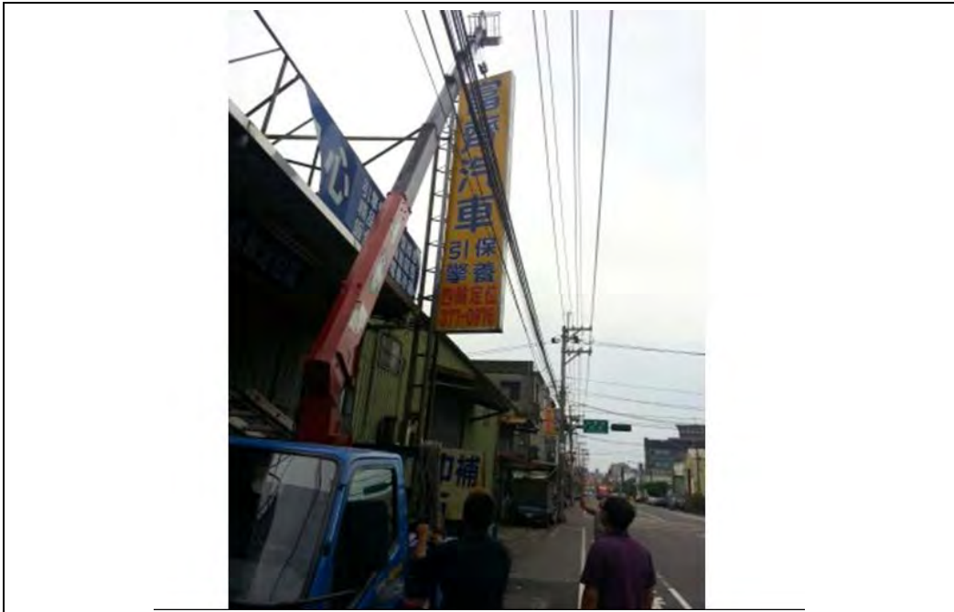
說明二 當時廣告招牌吊掛至欲安裝位置之高度位置約 9.7 公尺。
