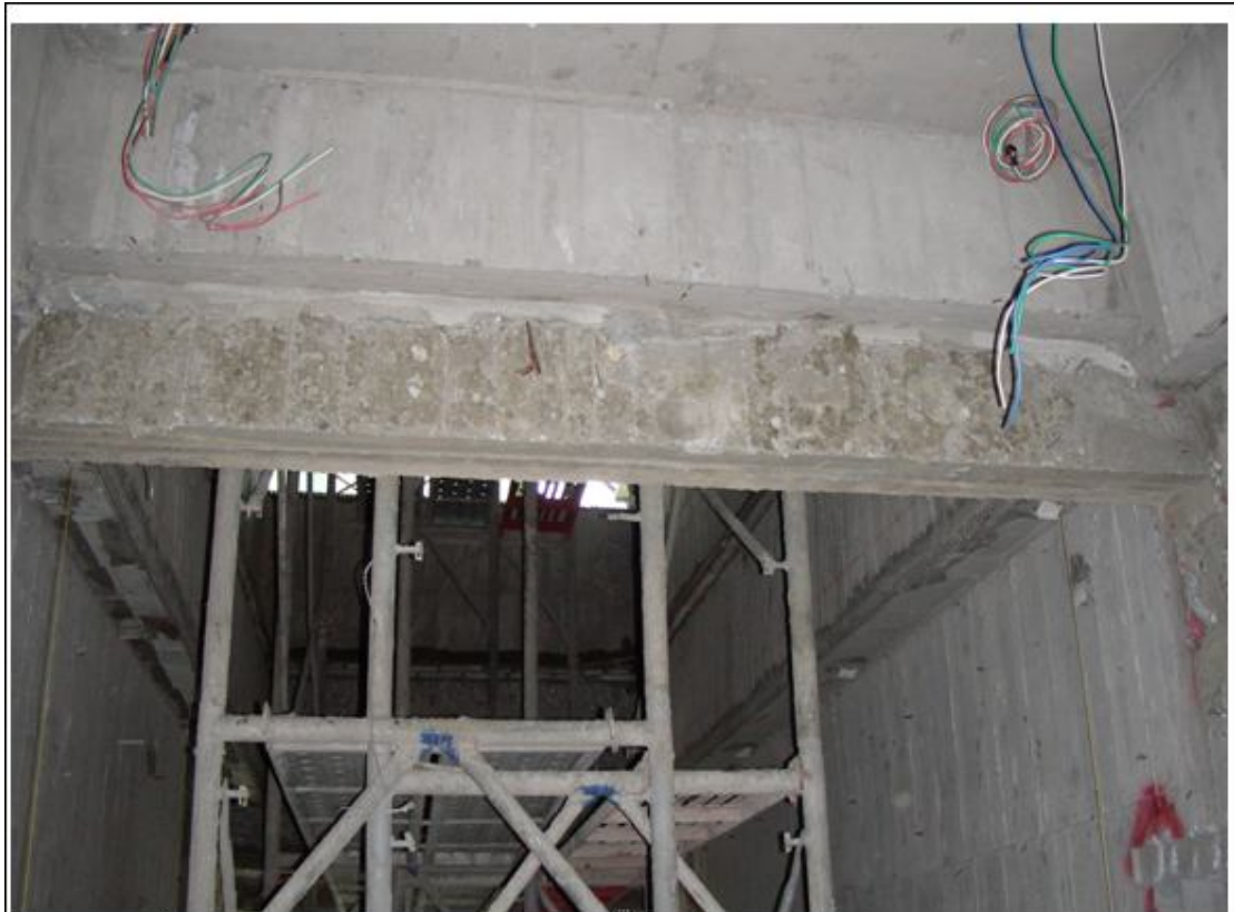
說明 3 照片中為本所 97 年 10 月 3 日至○○○○工地，○○營造股份有限公司人員所指發生之現場
