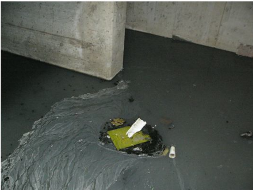
說明 相片 2，災害發生處，排水箱涵爬梯 A 處前因雜物積了 43 公分深之積水及污泥。
