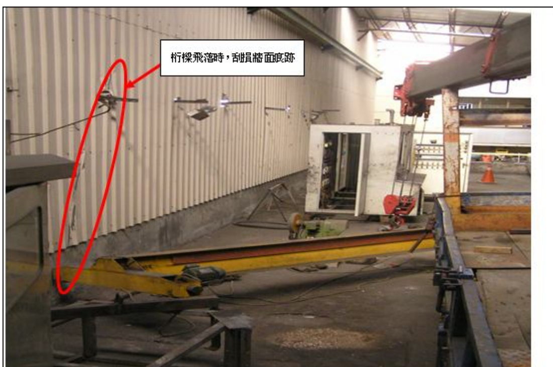
說明二 罹災現場罹災者遭壓之位置及鋼浪板遭桁樑飛落時刮損之痕跡
