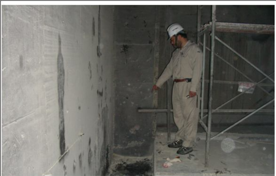
說明 2 照片中為發生事故許○○從事隔間牆螺桿切割工作處
