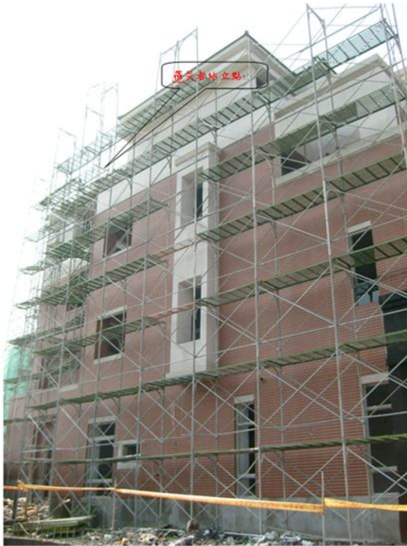
附照 2 林○○站立位置為第 7 層施工架上(如箭頭處)
