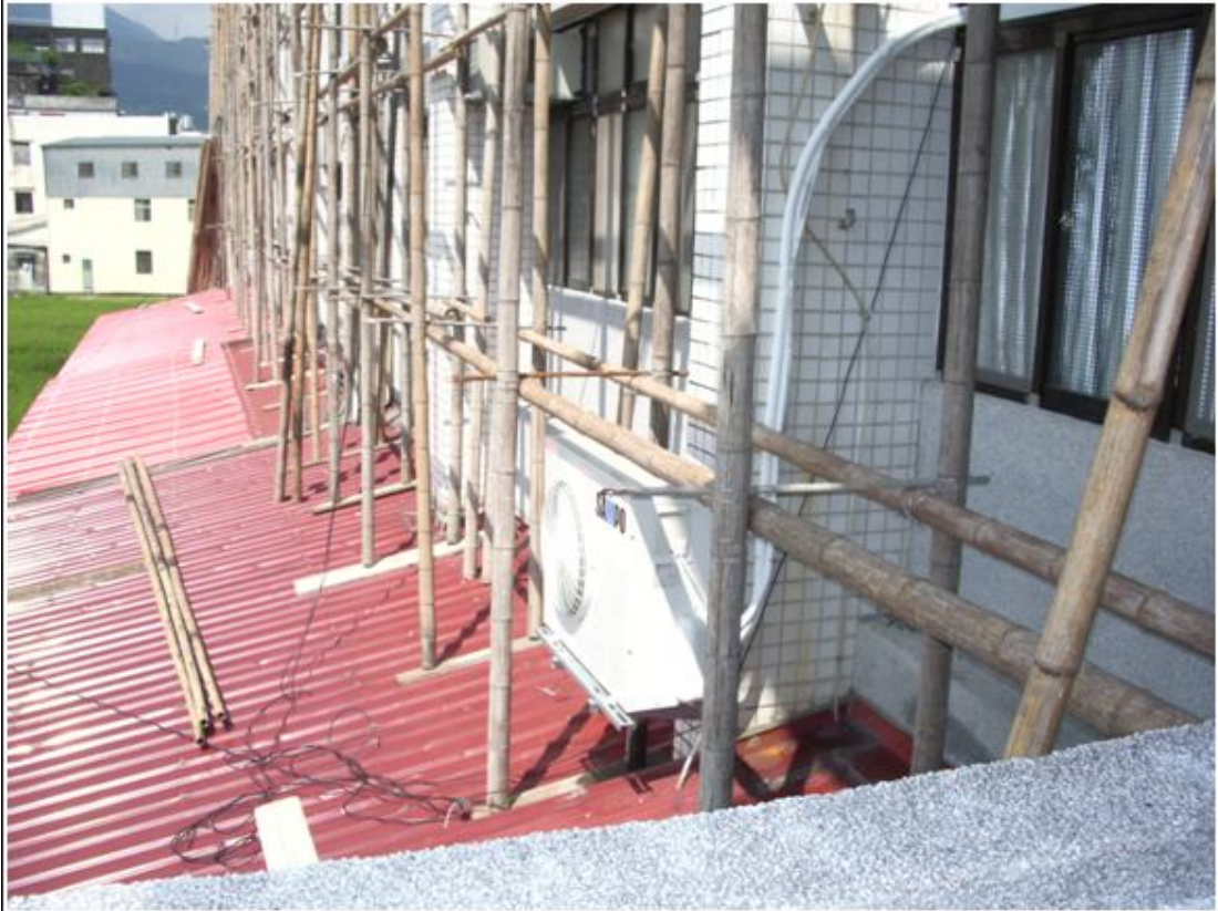
說明 2 照片中為發生事故之後方之 1 層樓鐵皮屋屋頂施工架
