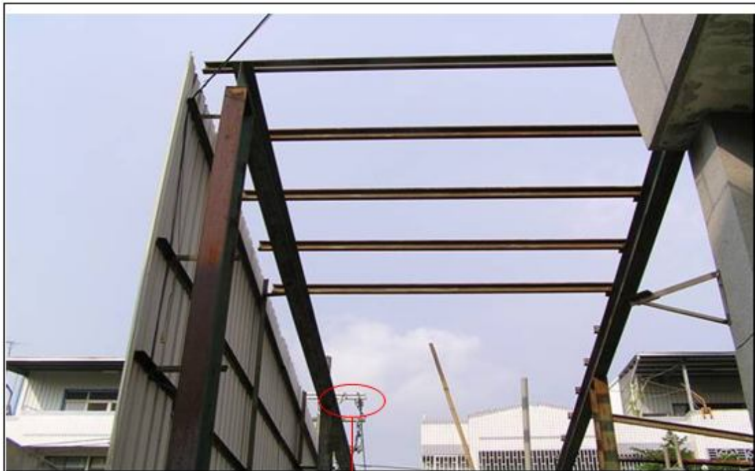
照片二 罹災者由該舊有廠房屋頂最北端且由西側起算第 6 支 C 型鋼開口處墜落至地面。
