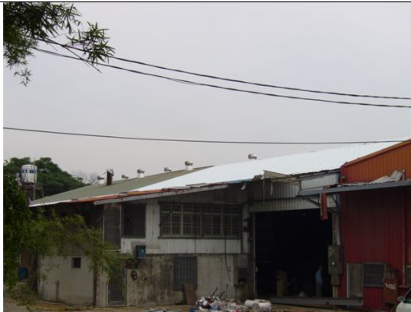
說明三 該屋頂浪板上方未設置適當強度，且寬度在三十公分以上之踏板或裝設安全護網，及未設置安全母索。
