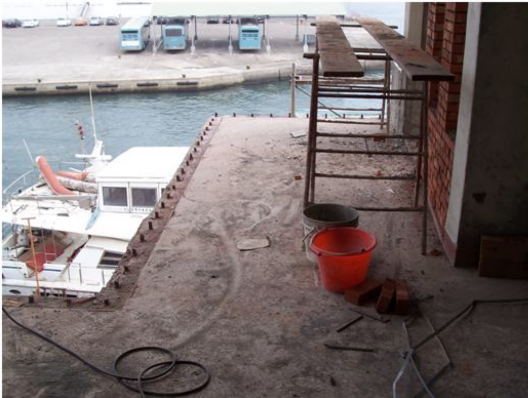
肇災之4樓樓板邊緣開口部分未設置護欄
