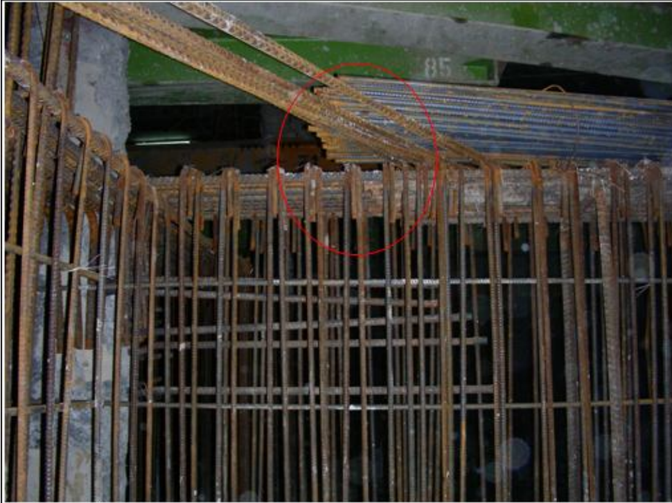
說明 罹災者墜落處情形
