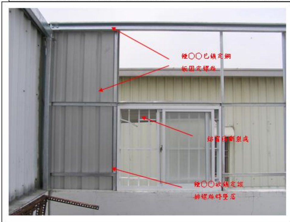
照片四：罹災者當日懸吊於屋外鎖定鋼浪板。
