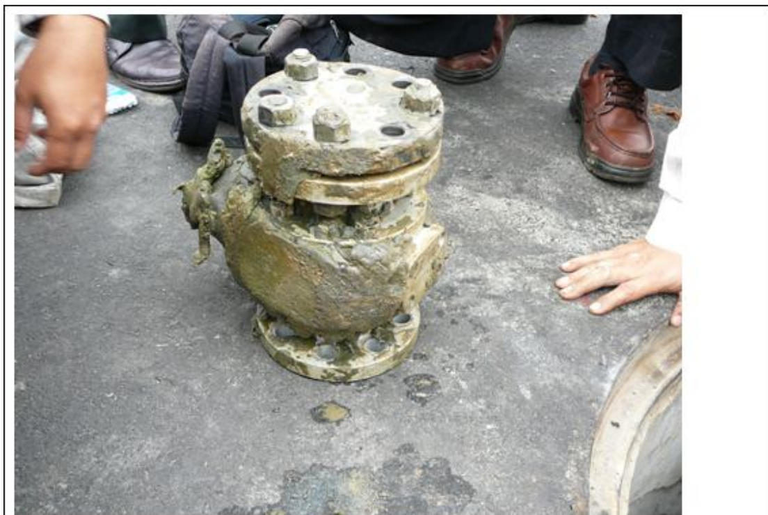
照片 2 | 罹災勞工將天然氣管線分歧管上之 2 吋球閥拆除，致無任何可防氣封管之氣氣外洩之開關。
