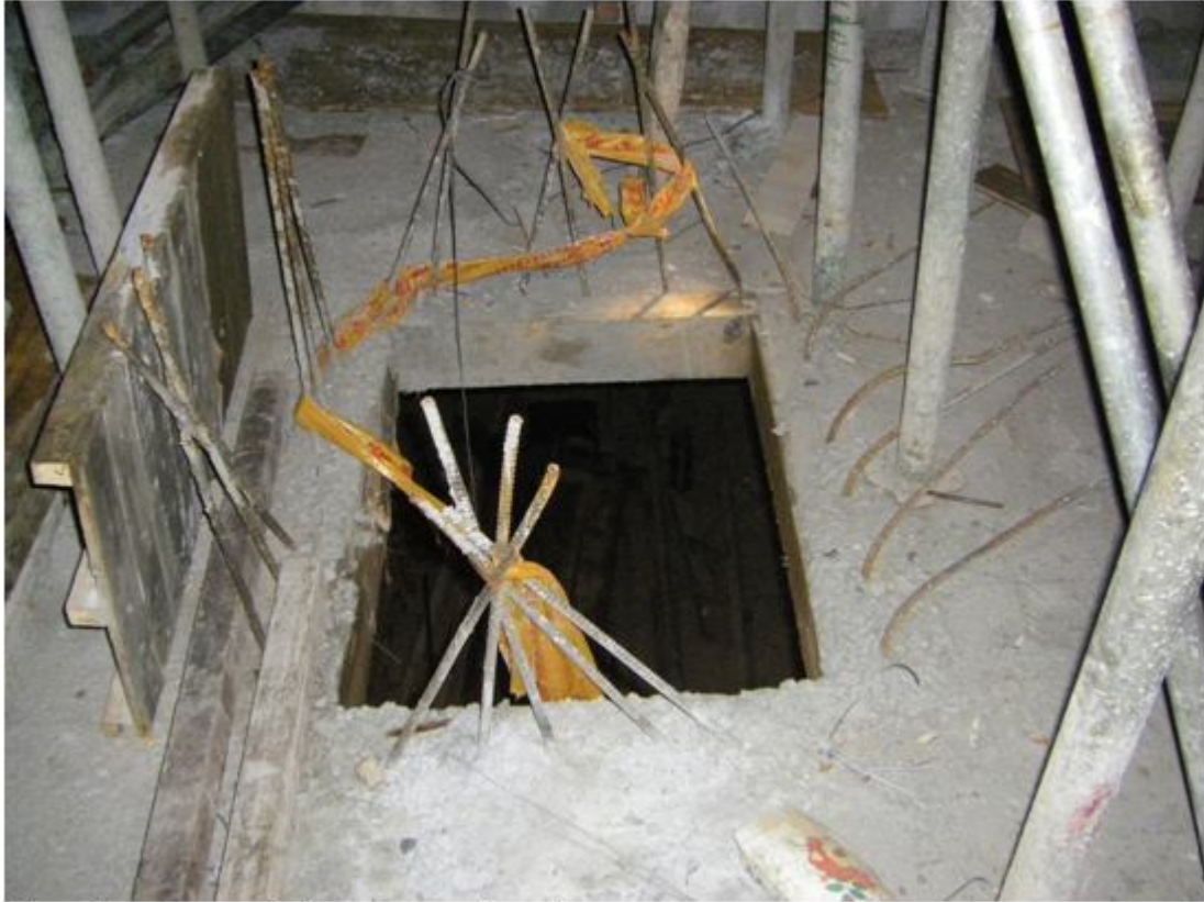
罹災者自地下一樓中間樁開口處墜落。
