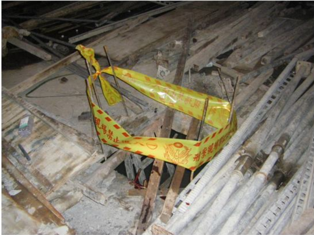
說明：勞工墜落至地下 2 樓筏基坑開口之垂直預留鋼筋上。
