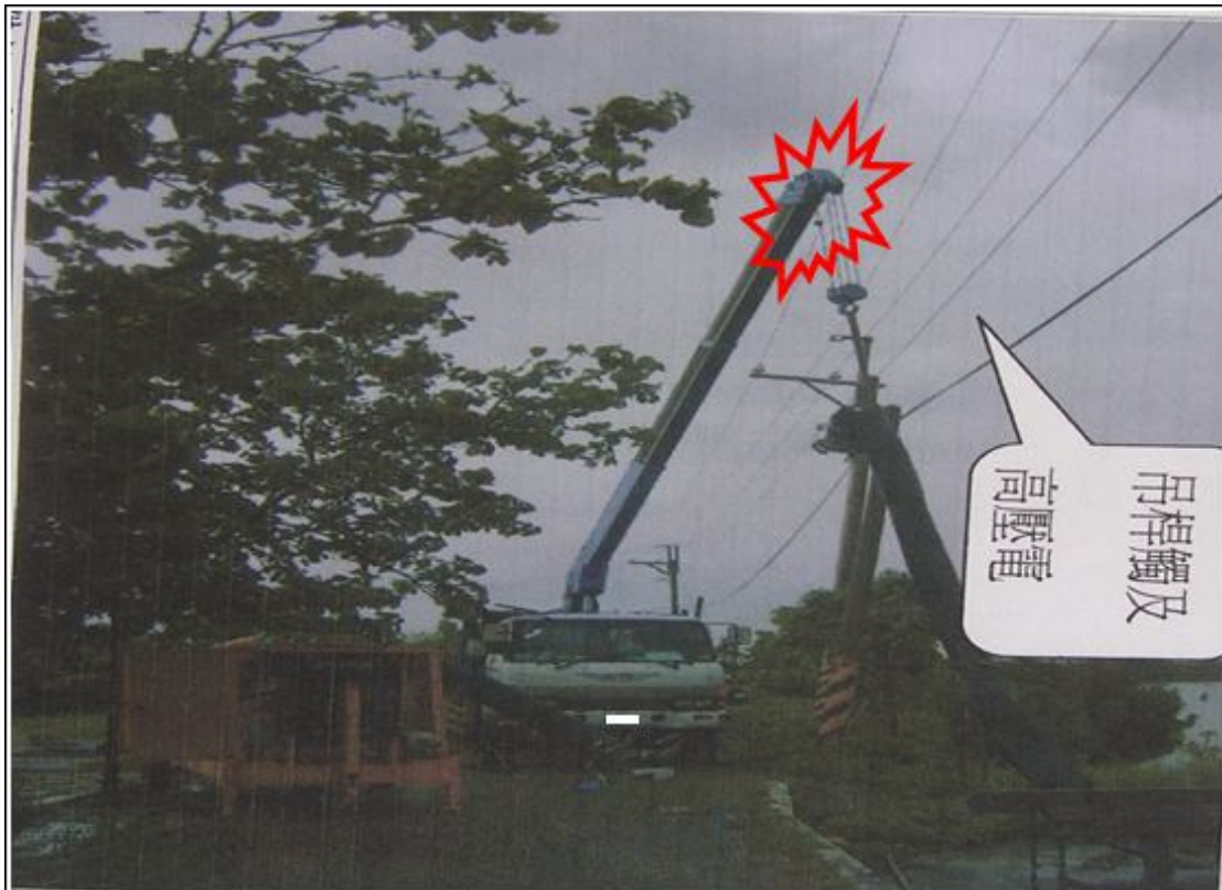
照片一 災害現場全景照片（照片係由○○派出所提供照片翻拍）
