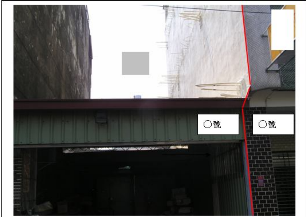
照片二 災害發生於台南縣○○鎮○○街○○○號，為○○街○號「○○住宅外牆油漆搭架工程」工地隔壁
