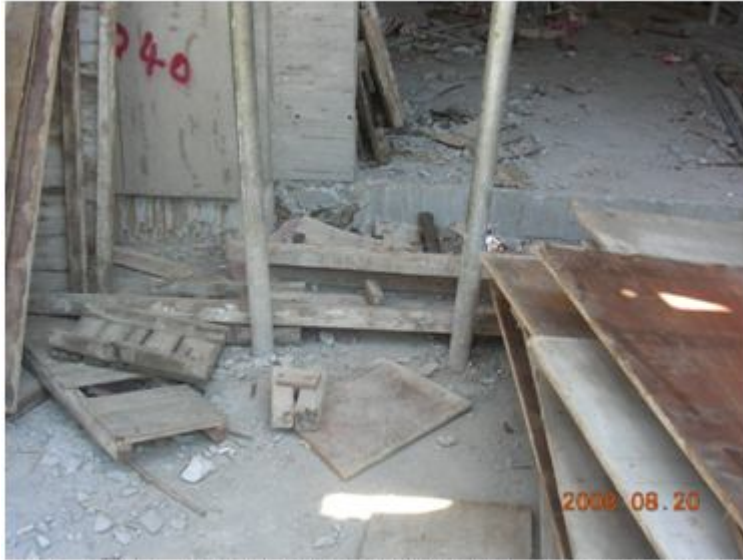
說明：罹災者當日作業位置現場雜亂、物料隨意堆置。
