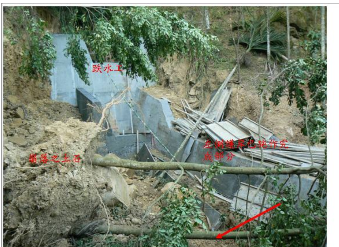
說明 附照 1 發生崩塌後 A 段護岸下方已被土石掩埋(箭頭處為罹災者位置)
