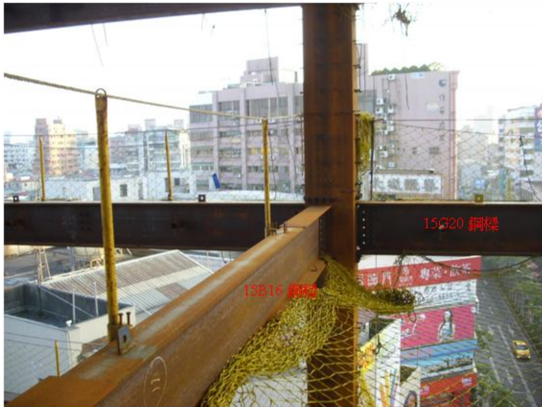
說明二：災害發生處所靠近 15G20 與 15B16 鋼樑交接處
