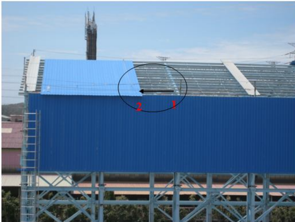
沈○○攀登屋頂後由 1 走至 2 時發生墜落
