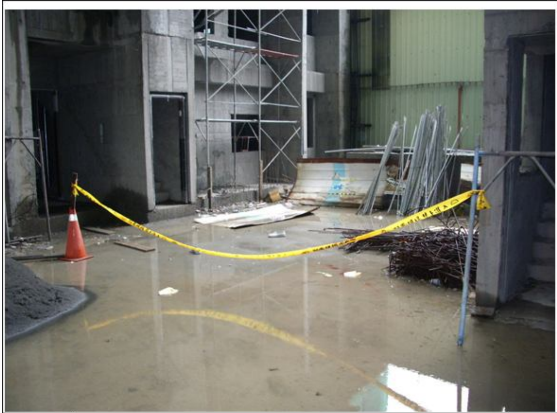
說明 1 照片中為罹災者許○○墜落處1樓
