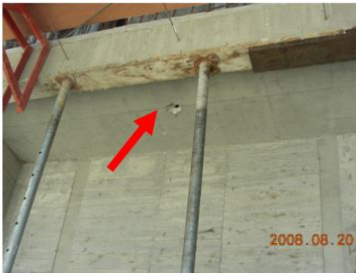
說明：箭頭指示處即為罹災者當日拆除之兩遮底板。
