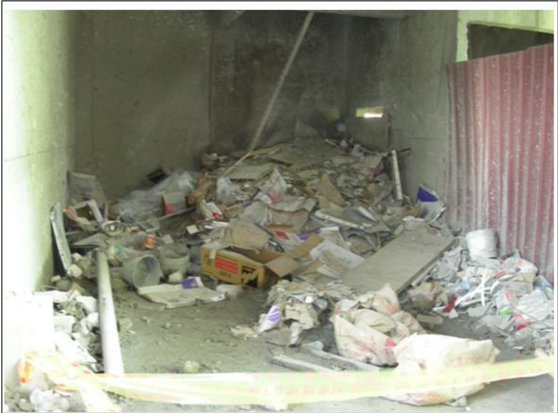
說明 2 照片中為罹災者范○○墜落處1樓
