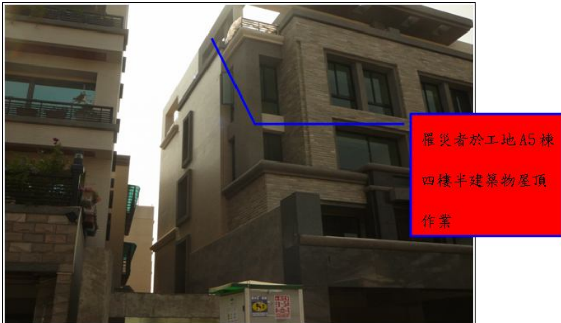
照片一 災害發生於台南市○區○○○路○○○號「○○別墅電梯豪宅雙併，獨棟」工地 A5 棟四樓半建築物屋頂
