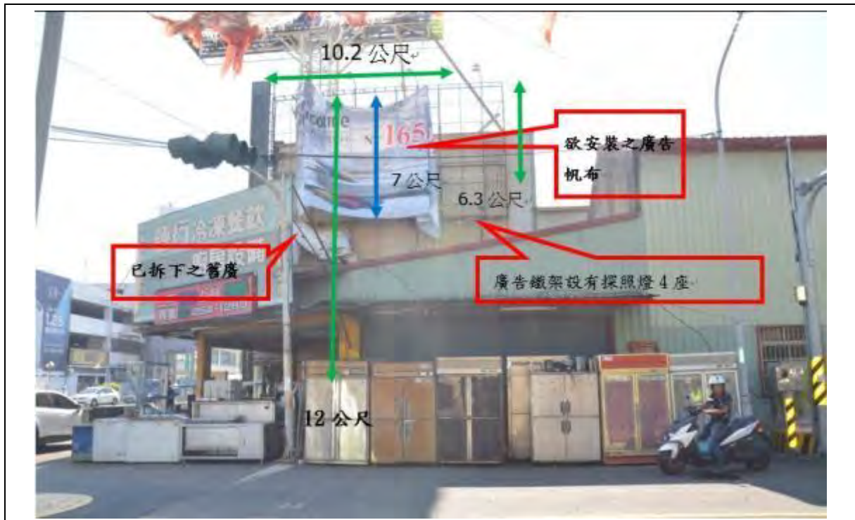
說明一 災害發生於台南市○區○路○號（晶○企業有限公司）鐵皮屋頂上，現場留有罹災者施工到一半尚未完成拆換之廣告帆布。（帆布尺寸為 1020cm×630cm）
