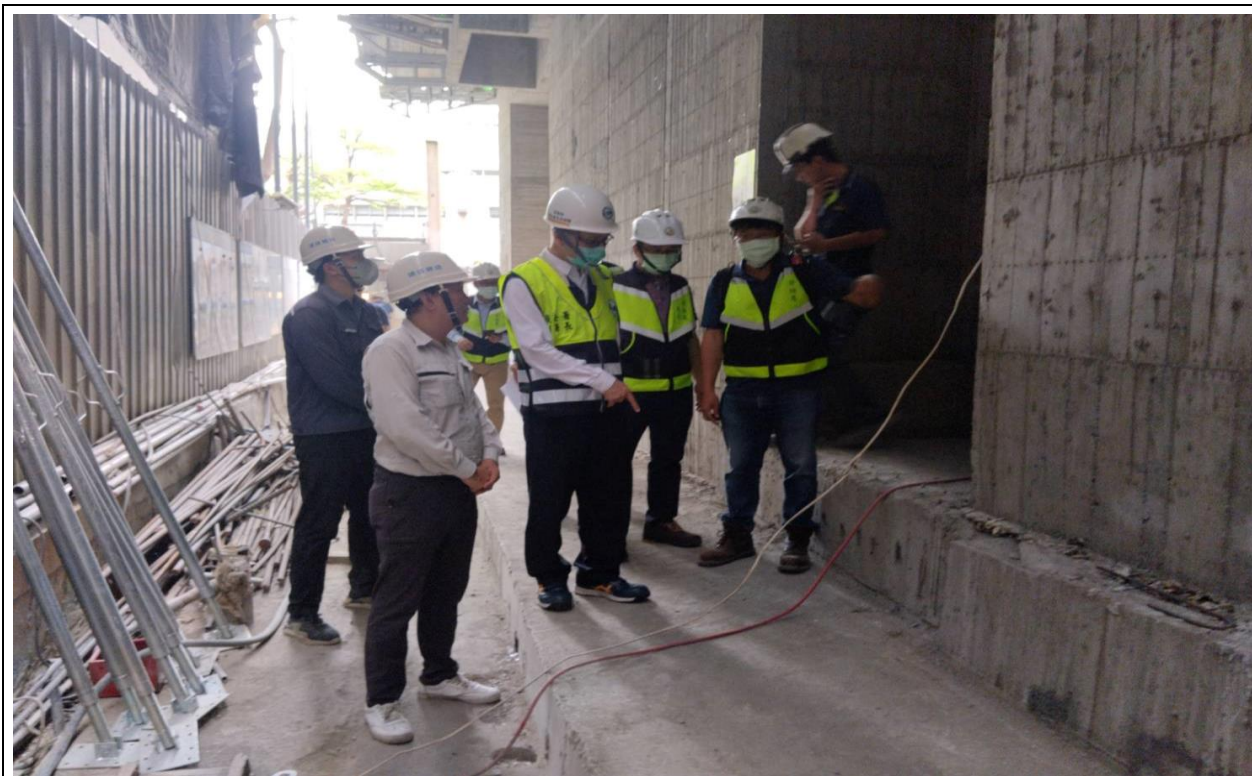
本署朱金龍副署長與高雄市政府勞工局勞動檢查處郭清吉處長率檢查員前往高雄市某建築工地實施勞動檢查。
