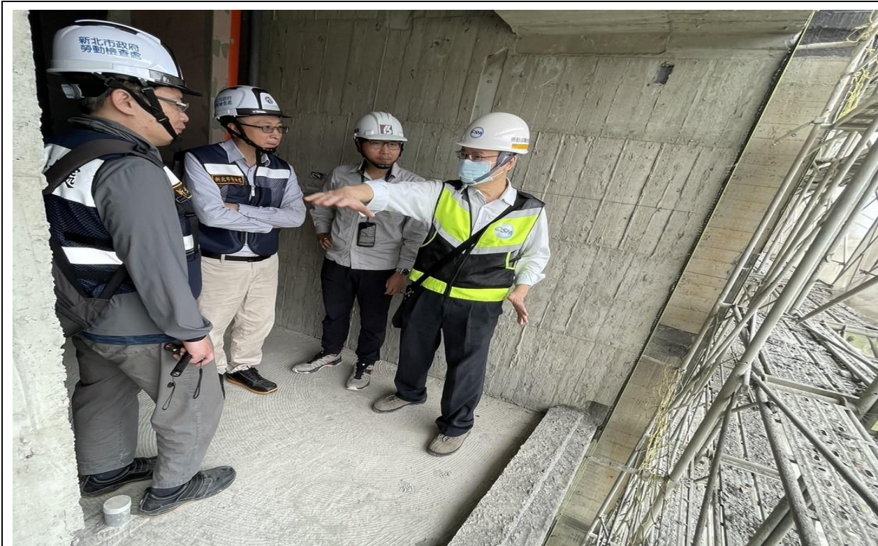
本署職業安全組朱文勇組長與新北市政府勞動檢查處林澤州處長率檢查員前往新北市某建築工程實施勞動檢查。
