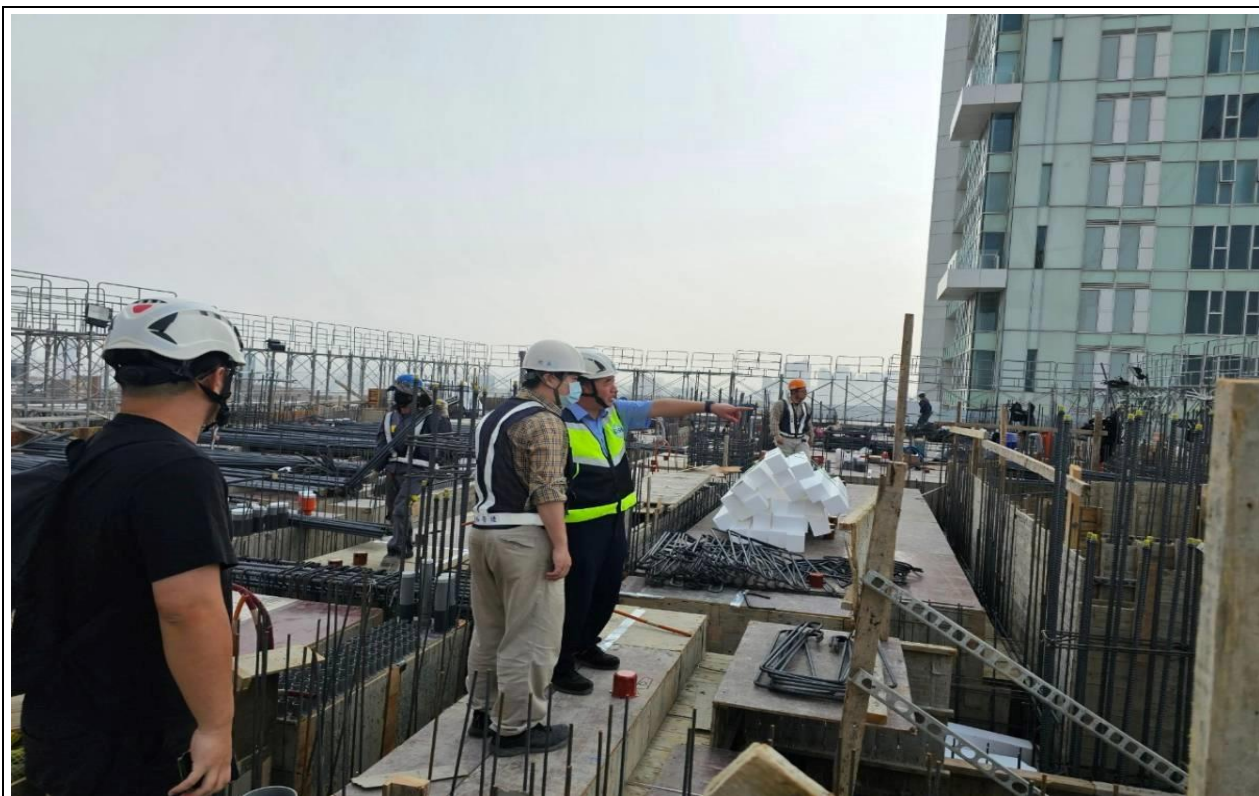
本署中區職業安全衛生中心李文進主任率檢查員前往臺中市某丁類建築工程實施勞動檢查。
