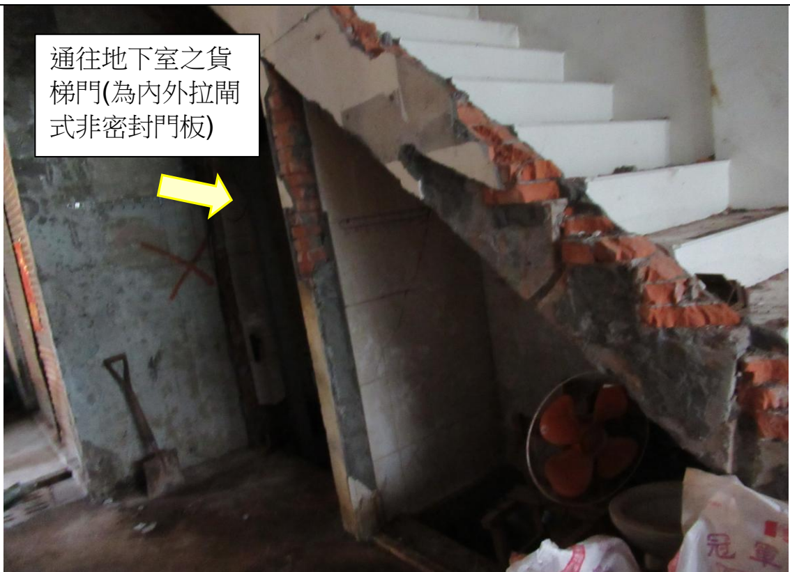
附照 2 說明：氣爆後之災害現場。(屋內建築物磚牆被炸倒塌)。
