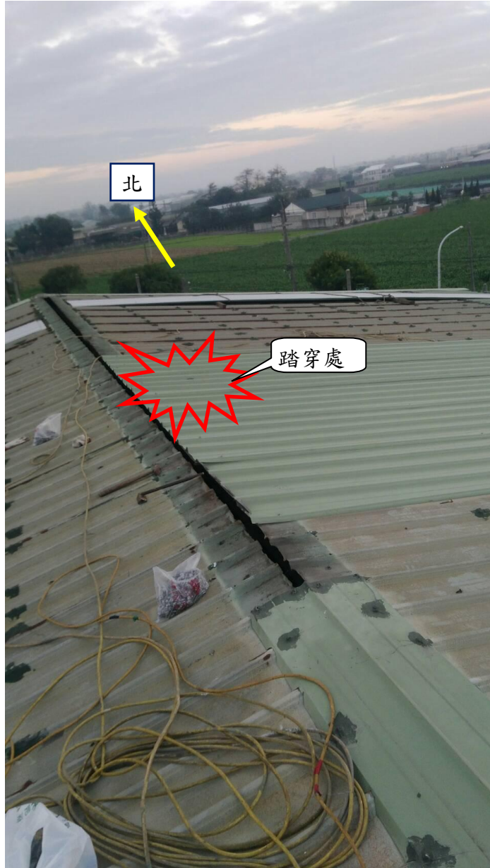
照片 | 現場示意圖 (災害發生之屋頂踏穿處位置)。
