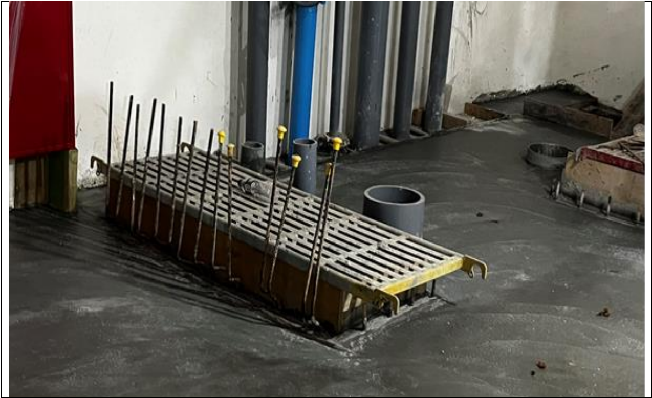
臺中市某廠房工程暴露之鋼筋未採取彎曲尖端、加蓋或加裝護套等防護設施。
