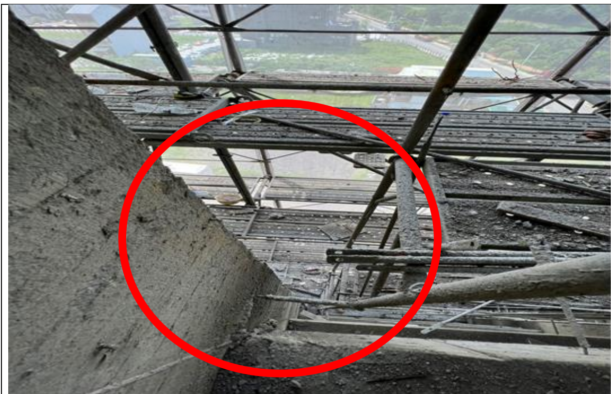
桃園市某建築工地高度 2 公尺以上之開口部分，勞工有遭受墜落危險之虞，未於該處設置護欄、護蓋或安全網等防護設備。
