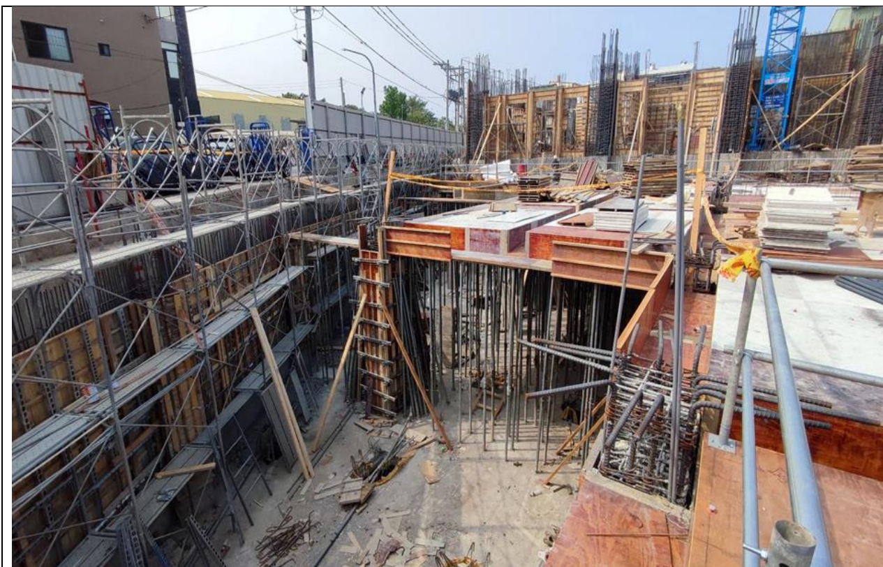
高雄市某建築工地高度 2 公尺以上開口部分未設護欄等防護設備。
