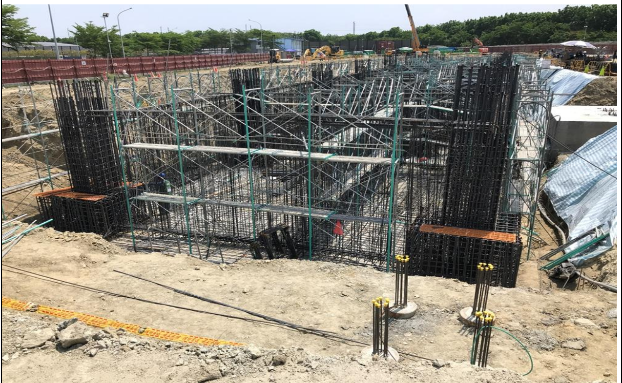
臺南市某廠房工程高度逾 1.5 公尺之施工架未設置上下設備；另基礎開挖深度逾 2 公尺開口未設置護欄。
