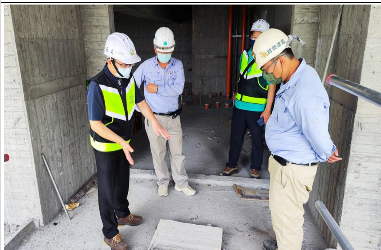
高雄市政府勞工局勞動檢查處郭清吉處長率檢查員前往高雄市某建築工地實施勞動檢查。
