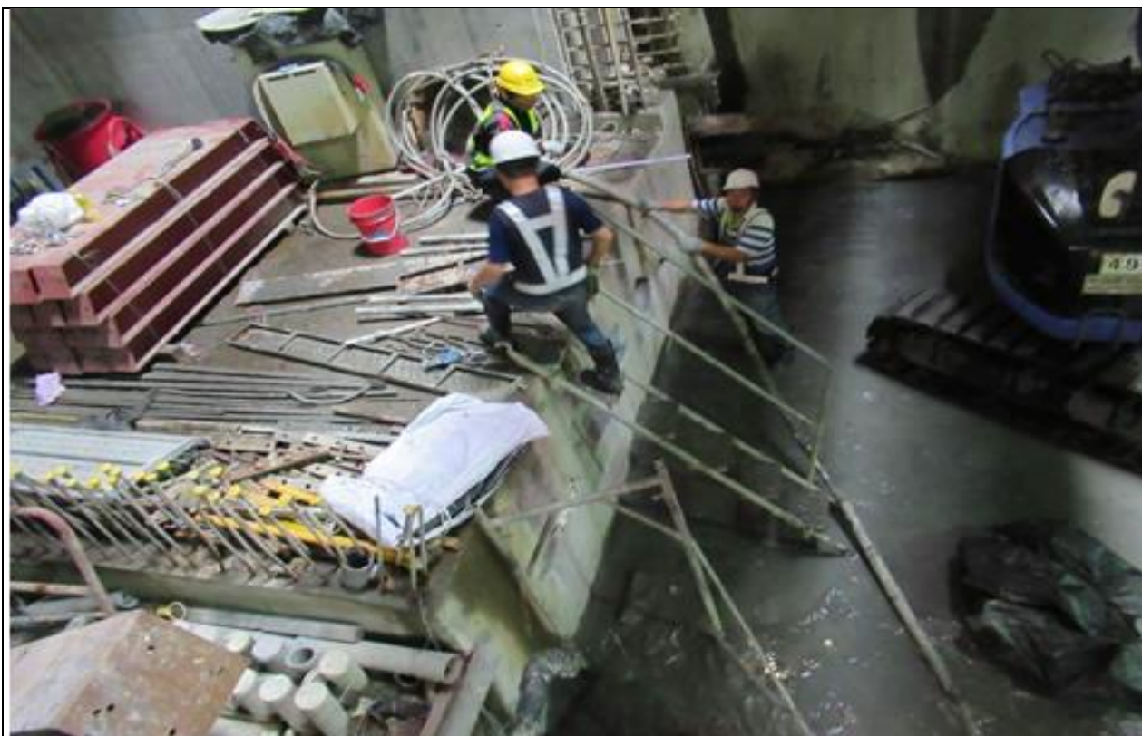
臺北市萬大線捷運工地高度超過 1.5 公尺以上未有安全上下設備。
