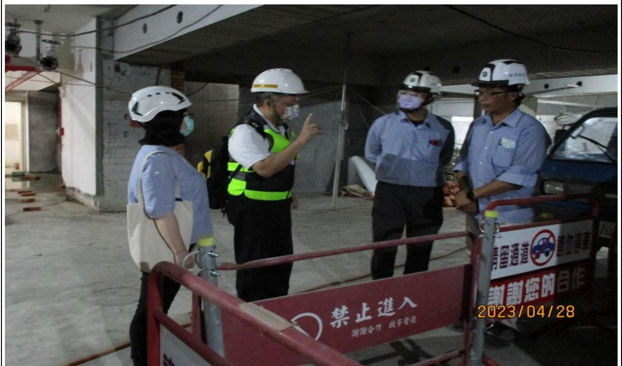
本署林志展副組長及經濟部加工出口區管理處臺中分處張世娟課長率檢查員前往加工出口區某建築工地實施勞動檢查。
