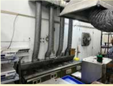
圖二、作業環境 1 清洗作業區，清洗槽以槽蓋覆蓋 (非完全密封)，旁有局部抽氣設備。
