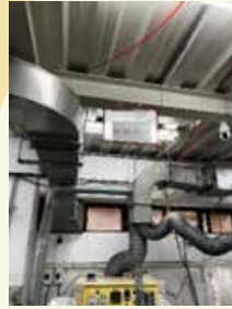
圖三、作業環境 2 廠內各項機台皆與局部換氣設備連接。
