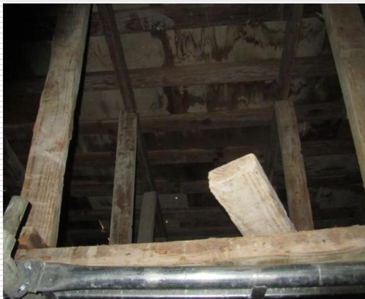
未倒塌之 模板支撐
