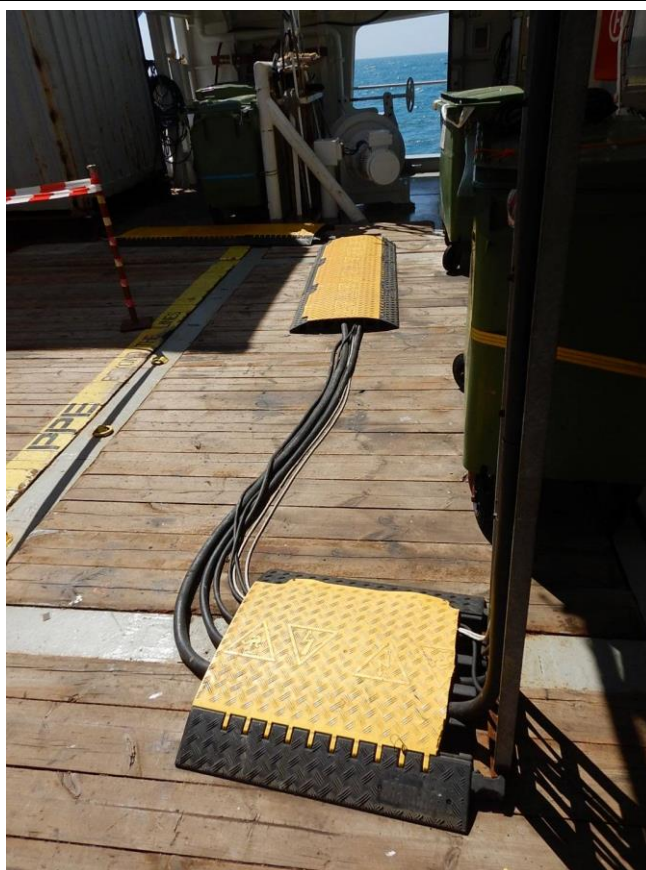
工作船甲板通道之電線防護設施遭部分移除未復原
