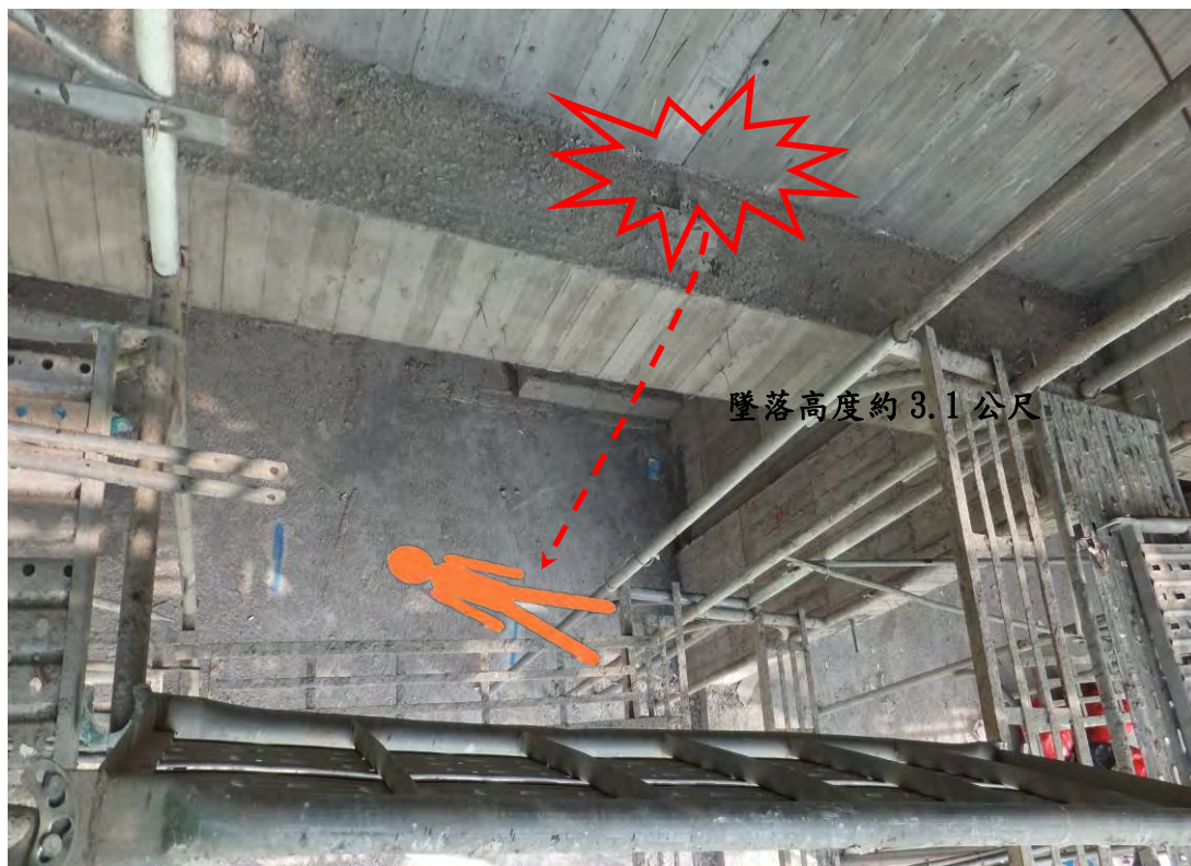
事故發生時現場之相對關係位置。
