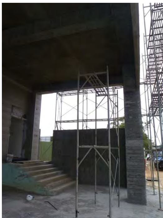
照片 1 罹災者發生墜落之現場
