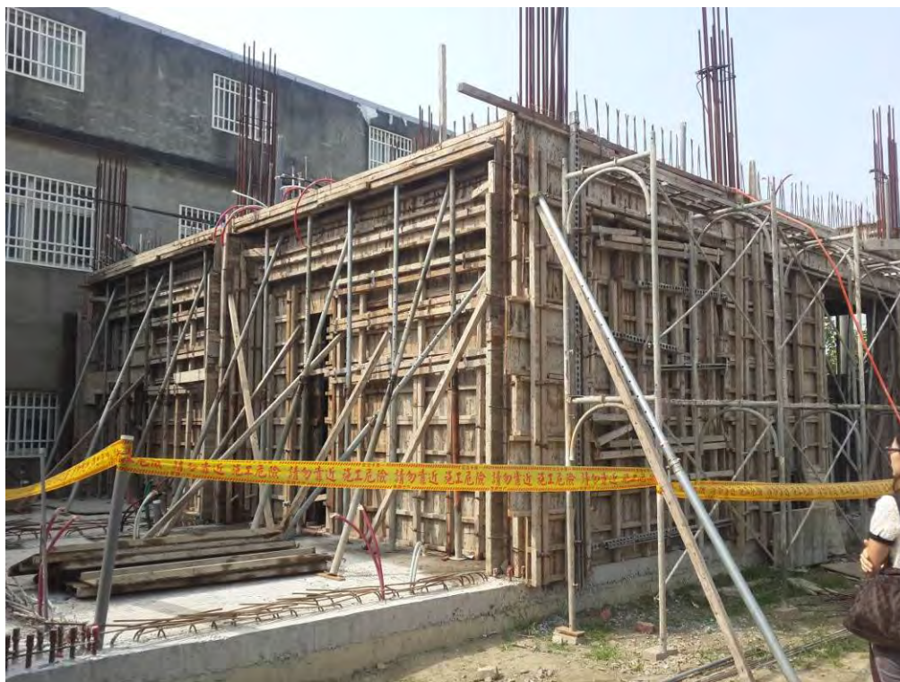
照片 1 林○○、林○○住宅新建工程為 3 層樓建築，目前進行 1 樓頂板模板作業
