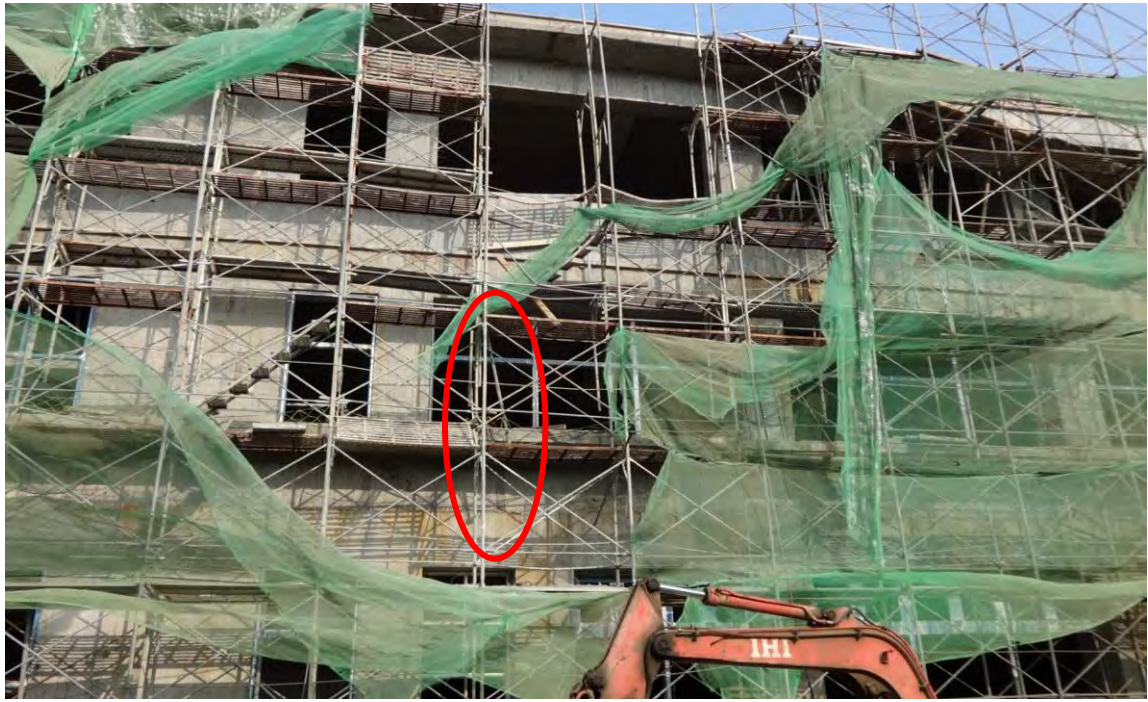
附照 6：可調鋼管支柱 接管掉落至下方安全網
