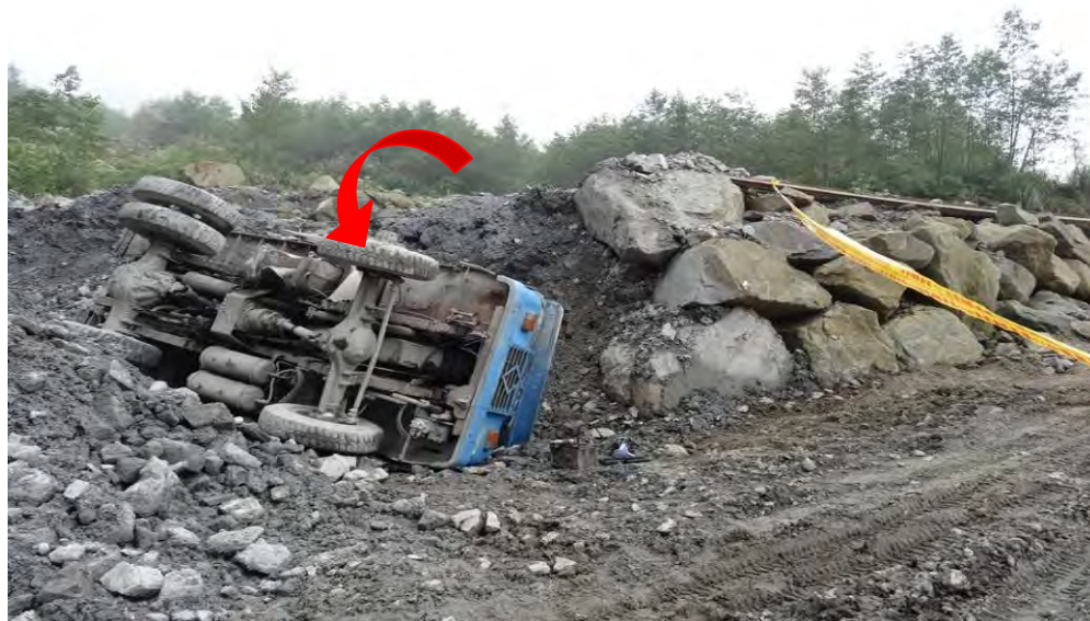
照片 2：罹災者潘金田駕駛之「出礫車(2)號」由卸料平台北側翻覆至下方之礫料整理區，該車翻覆後車頭朝西，車底朝北。
