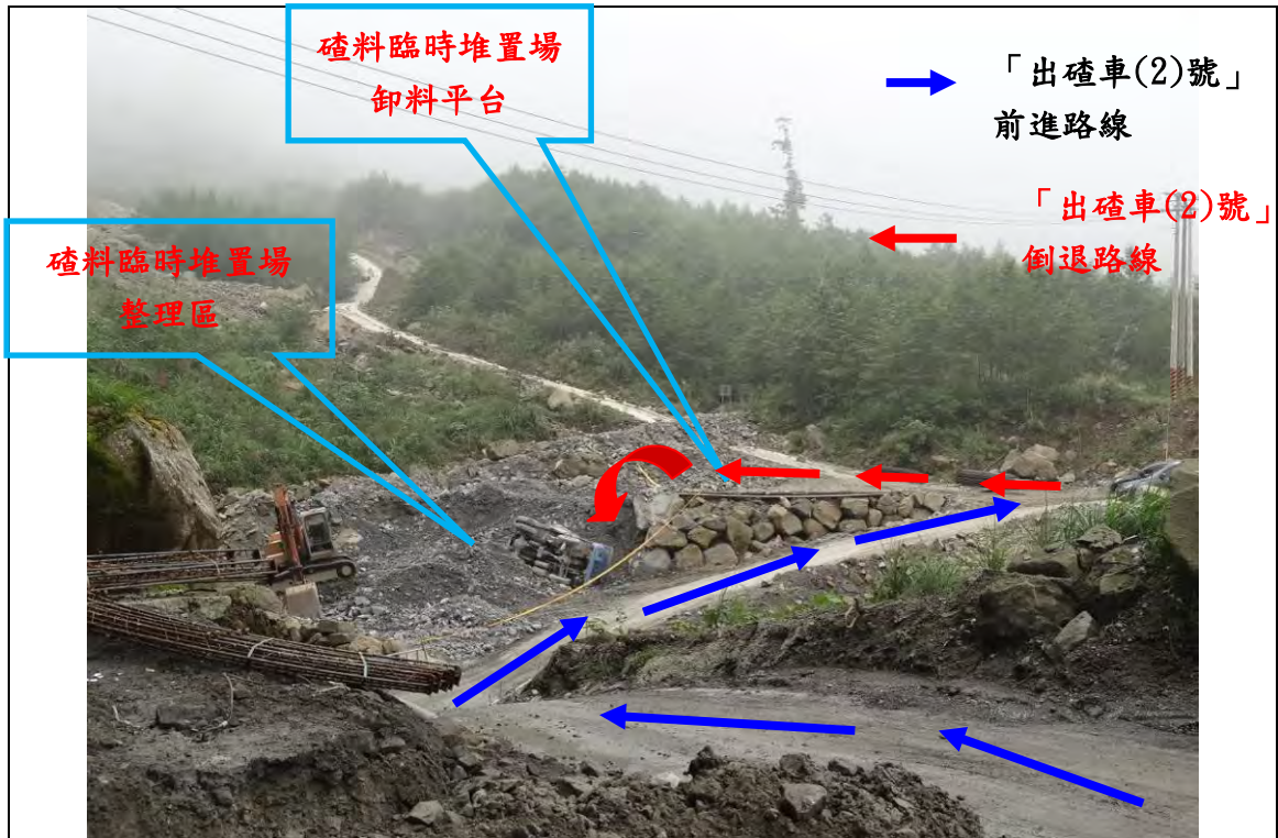
照片 1：災害現場之礫料臨時堆置場，以堆置之礫料整理出一卸料平台，呈南北向，作為出礫車卸料之道路，該卸料平台寬度約 9.5 至 10.0 公尺，長度約 15.3 公尺，平台北側處高度約 3.0 至 4.0 公尺不等。平台北側下方有一礫料整理區，寬度約 9.5 至 10.0 公尺、長度約 20.0 公尺
