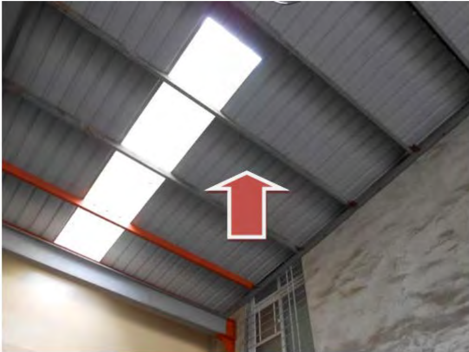
照片1 罹災者踩破浪板處。(現場已完工)
