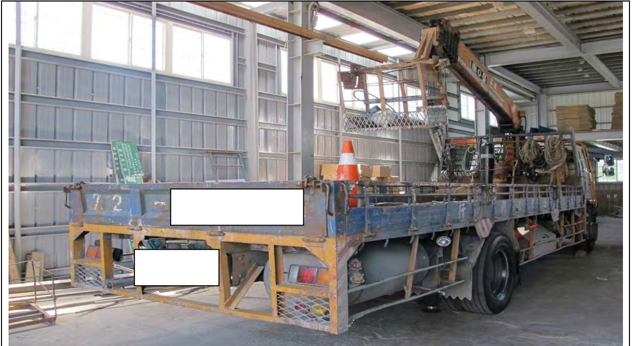
照片 1 本案所使用之移動式起重機操作(吊升荷重:3.03 公噸,編號:41M05B2810001,檢查有效期限:102 年 8 月 4 日),其搭乘設備未委託中央主管機關認可之專業機構簽認。
