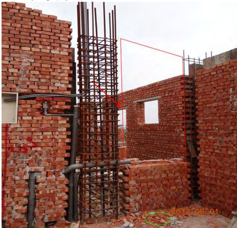
紅色箭頭所圍區域即倒塌範圍，約 480 公斤重之砌磚牆倒塌壓傷勞工（綠圈處）致死
