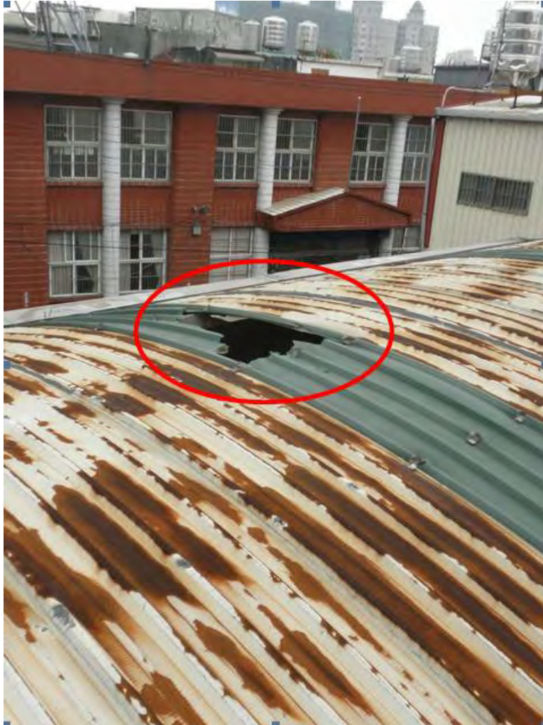
屋頂墜落起始處
