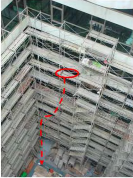
立架往5樓露台飛落並擊中罹災者
