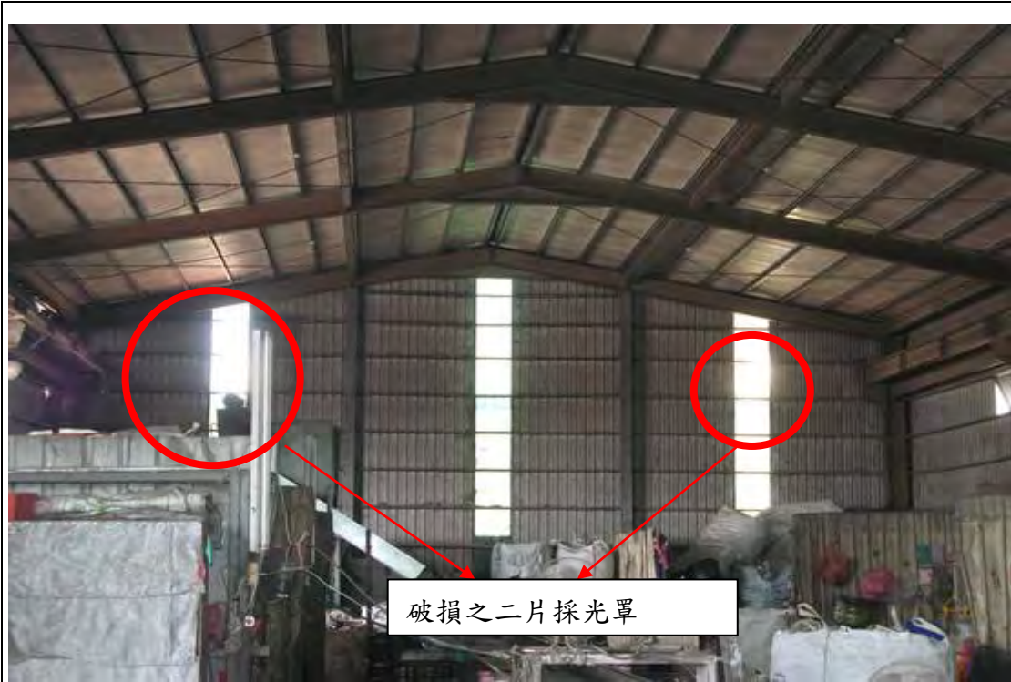
照片一 廠房破損之二片採光罩位置
