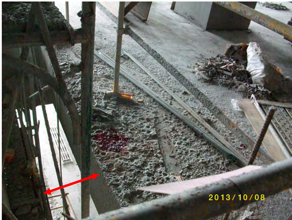
罹災者墜落之施工架與開口空隙，經量測為 27 公分
