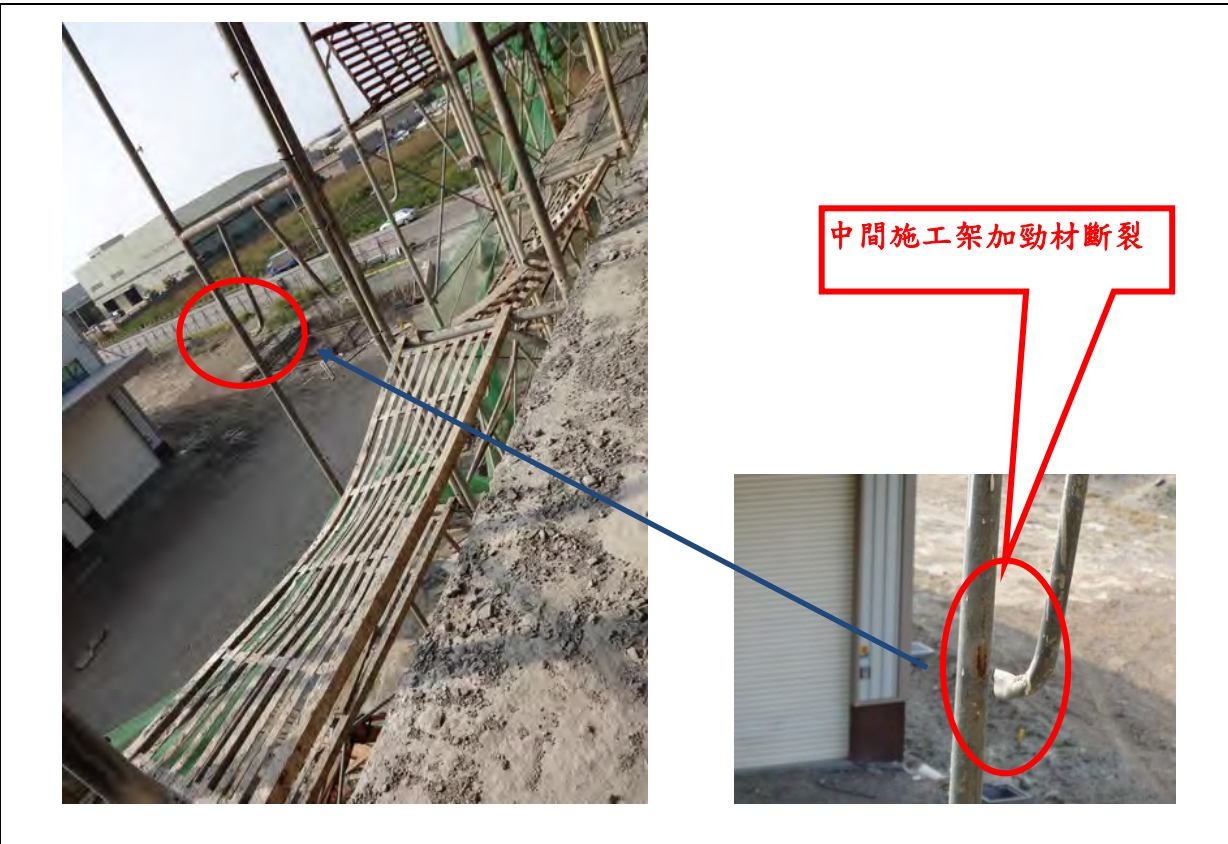
附照 4：中間施工架加勁材斷裂
