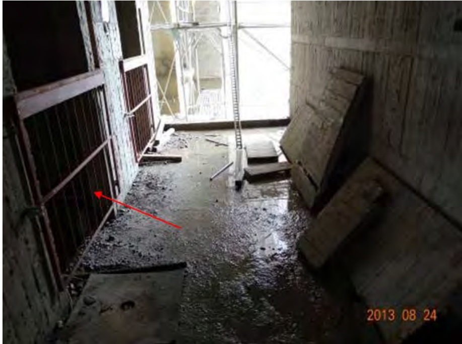
箭頭所指為肇災 C 棟 6 樓之垃圾管道間
