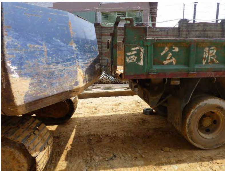
照片：罹災者遭挖土機迴旋時撞擊，身體(腹部)被夾在挖土機與卡車之間
