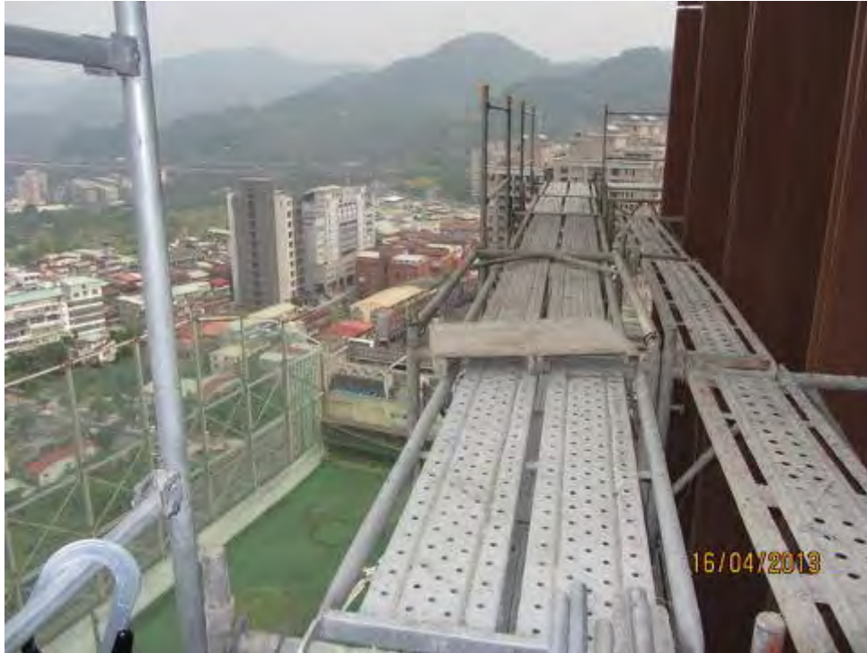
施工架拆除發生墜落時門型框架傾倒在施工架踏板上
