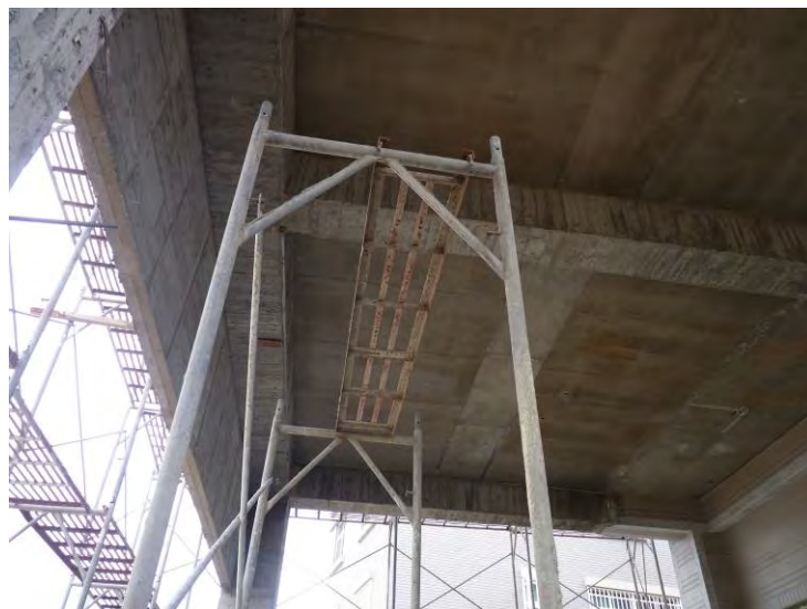
照片 2 罹災者欲拆除樑底模， 拆除時掉落撞擊以施工架搭 設的工作台，造成晃動導致 罹災者墜落地面。
