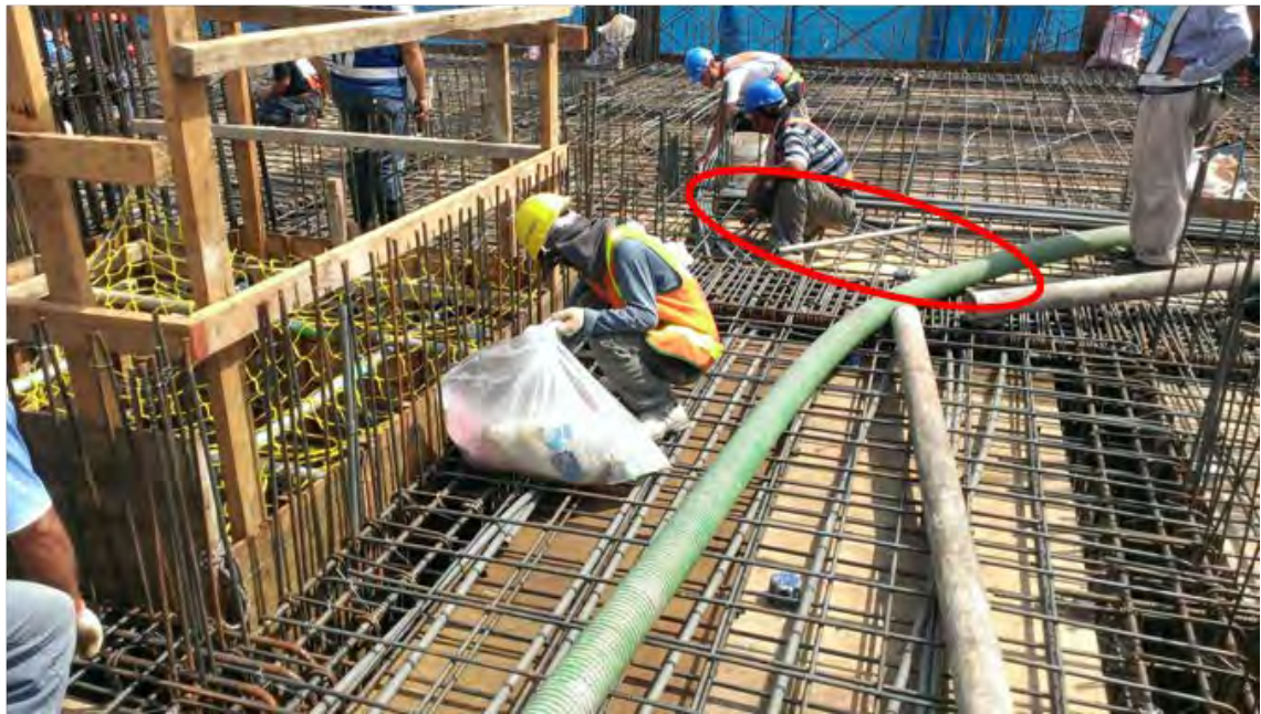
罹災者被發現時倒臥之大概位置（事發當時樓板上未有照片中工人）
