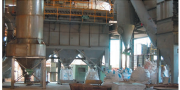
集塵區為廠區通風較好處，但太空包週圍仍有塵灰掉落
