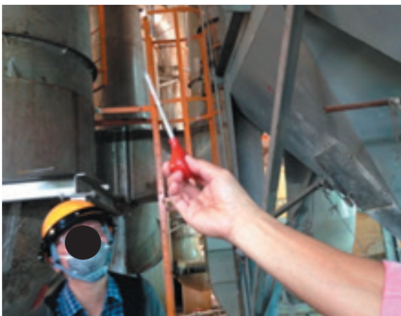
現場以發煙管測試廠區風向，顯示風向往廠區外流動，另可檢測集氣設備功能，但當天無運作
