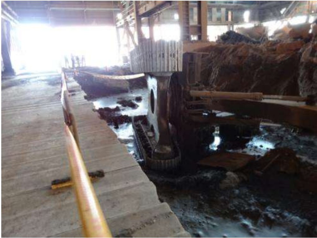
轉爐室內渣場二次冷卻區自設車道未設有護堤
