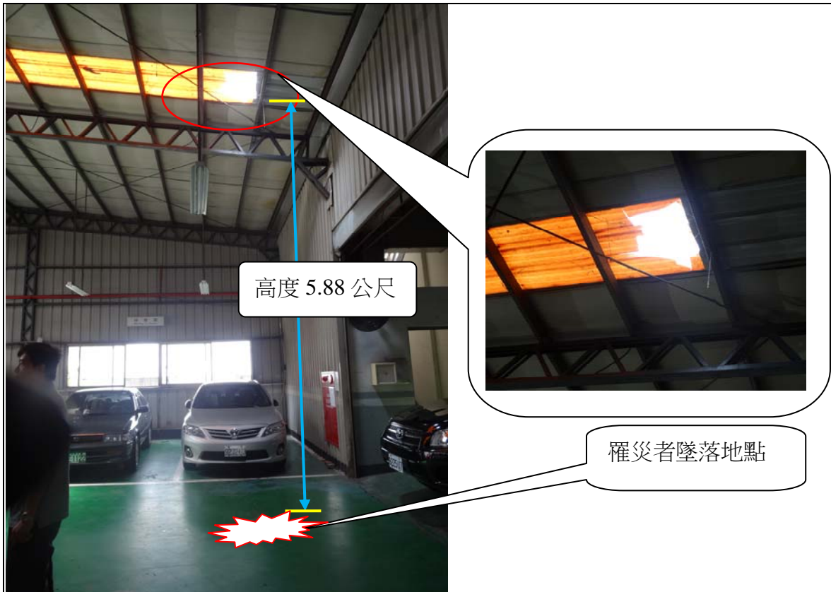
照片一 罹災者於服務廠接車區車道上方屋頂墜落距地面高度為 5.88 公尺。
