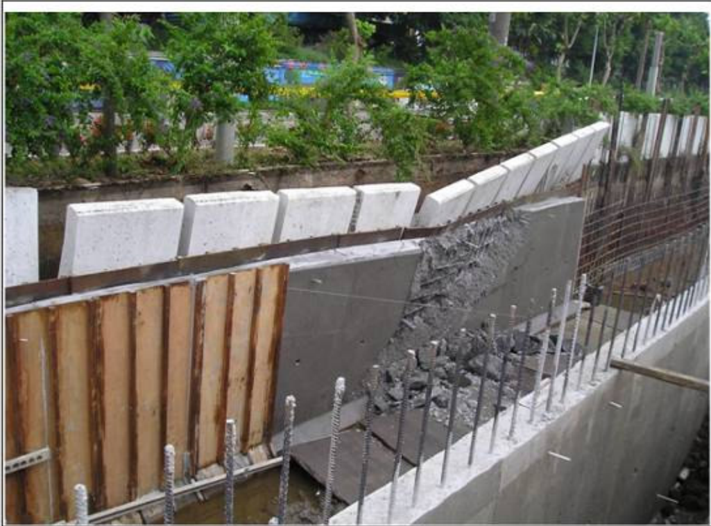
說明 附照 2 倒塌段造成渠道結構毀損情形
