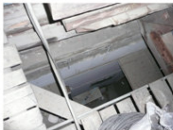
說明：貓道右側無防護設備。
