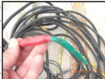
說明：電源線絕緣被覆破損致銅線裸露。
