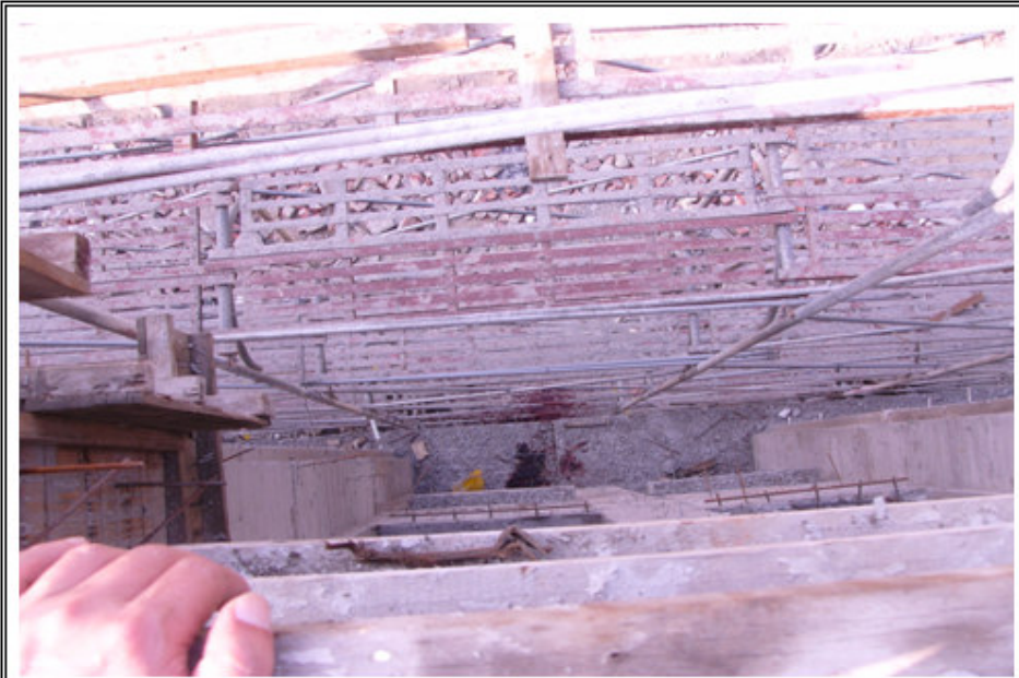
附照 2、工地 4 樓外牆施工架工作台至 2 樓平台高差約 5.4 公尺。
