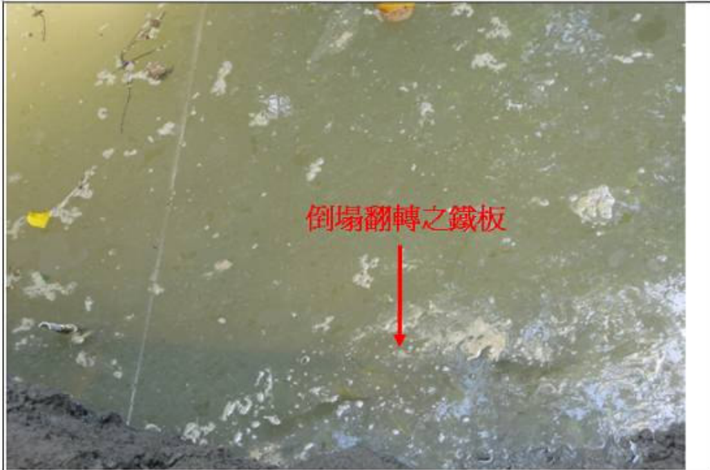
照片五 | 遺留現場被積水淹沒之鐵板
