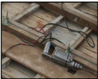
說明：漏電電鑽。
