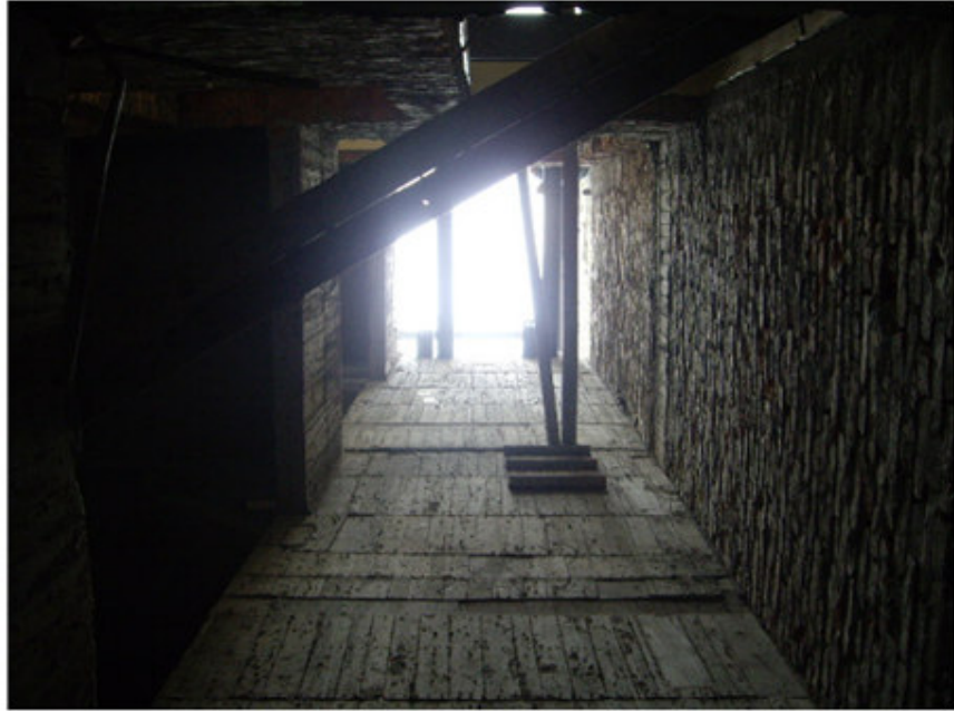
說明二：自一樓仰視，罹災者作業位置相當五樓高度。
