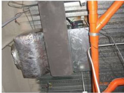
女廁上方空調送風機設備。
