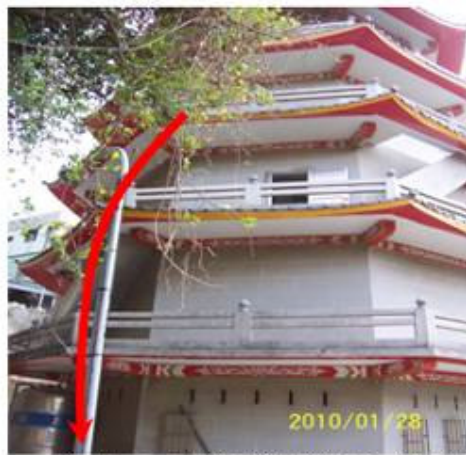
照片 1 罹災者作業處-墜落
