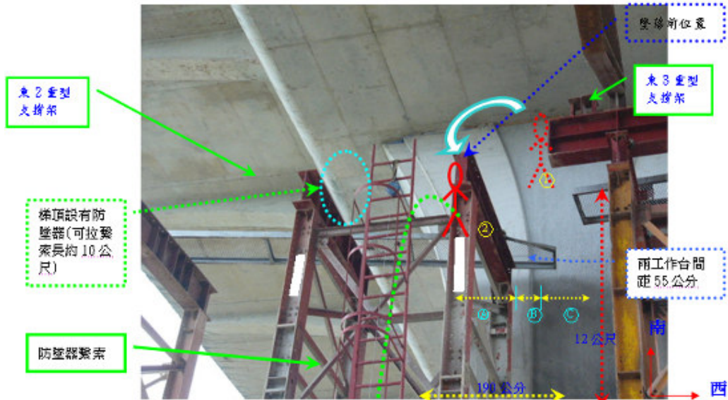
照片 2：現場概況（張○○由 1（東 3 重型支撐架）往 2（東 2 重型支撐架）移位再自重型支撐架內側墜落至地面。A:距約 80 公分，B: 兩工作台間距約 55 公分，C:距約 55 公分）
