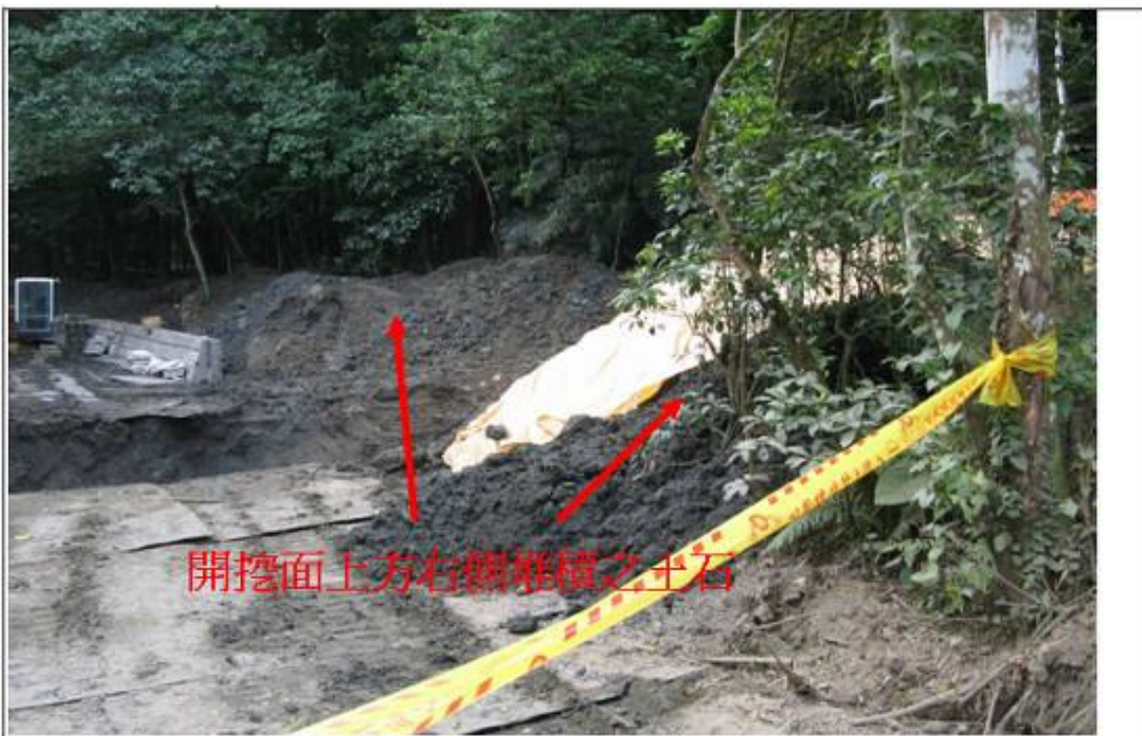
照片六 | 現場開挖面上方右側堆積之土石
