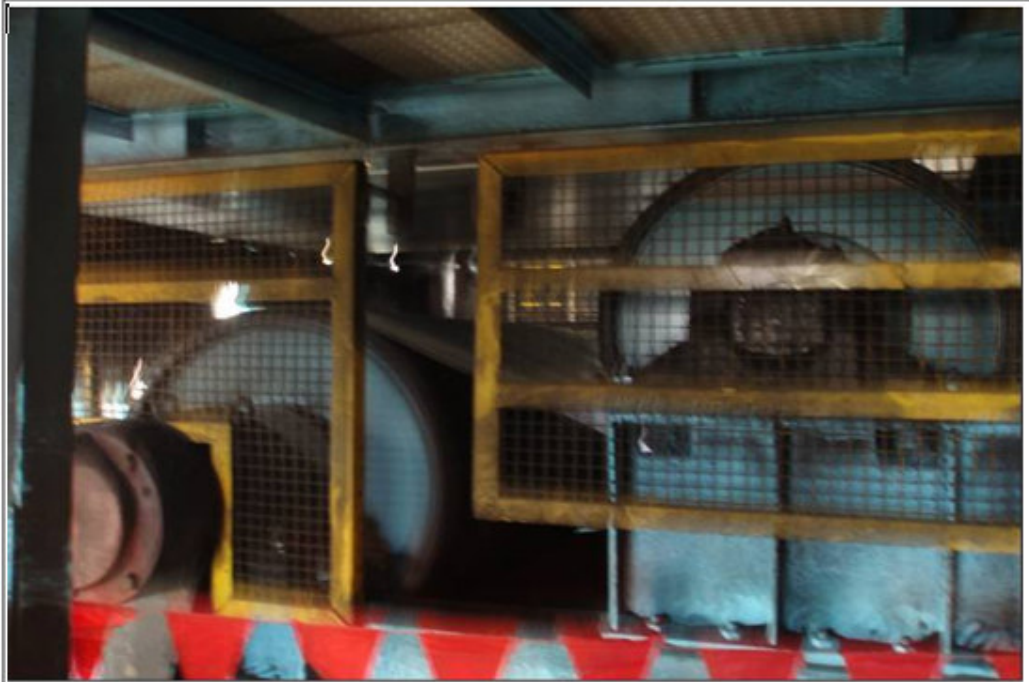
照片一 傳輸煤帶運機正常運作情形。
