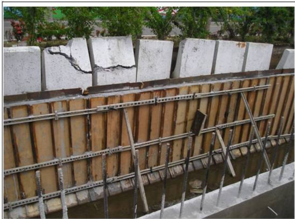
說明 附照 3 倒塌擋土牆毀損情形
