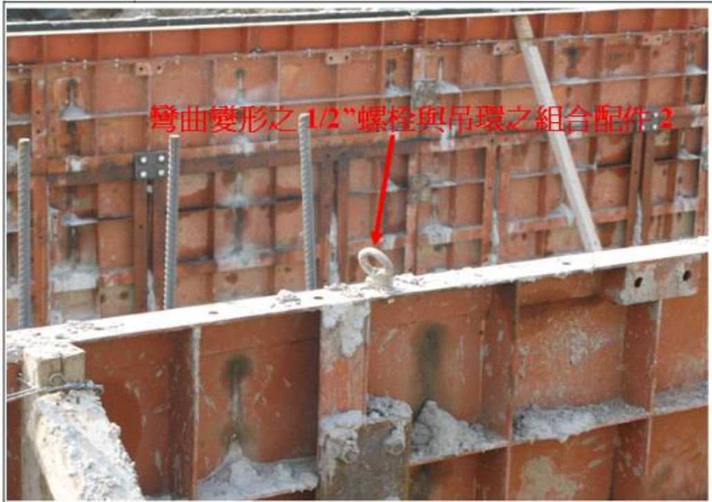
照片 8 彎曲變形之 1/2 吋螺栓與吊環之組合配件 2
