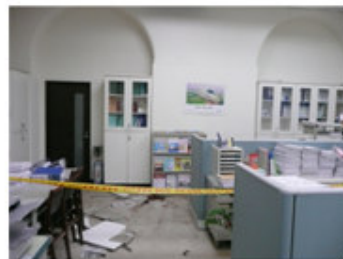
說明：罹災者墜落時天花板 破損散落于2樓地板。
