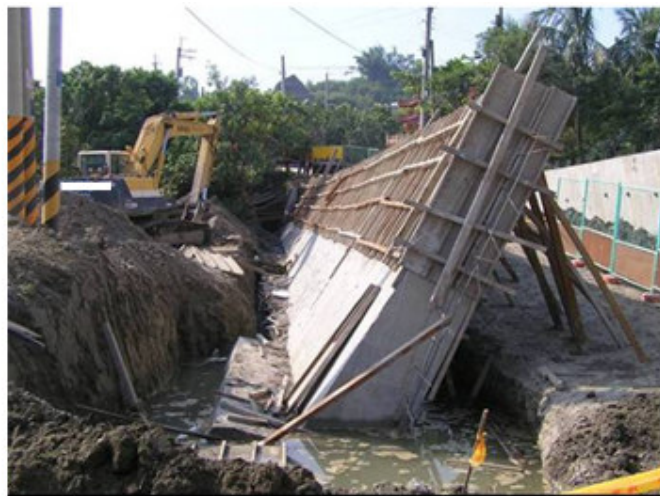
說明：倒塌之擋土牆長度 31.39M，頂部寬 0.6M，底部漸變由為 1M 至 0.9M，而高度漸變為 4M 至 3M，且有一基座長寬高為 5M×2.3M×1.1M，經計算得整座擋土牆重約 237 公噸
