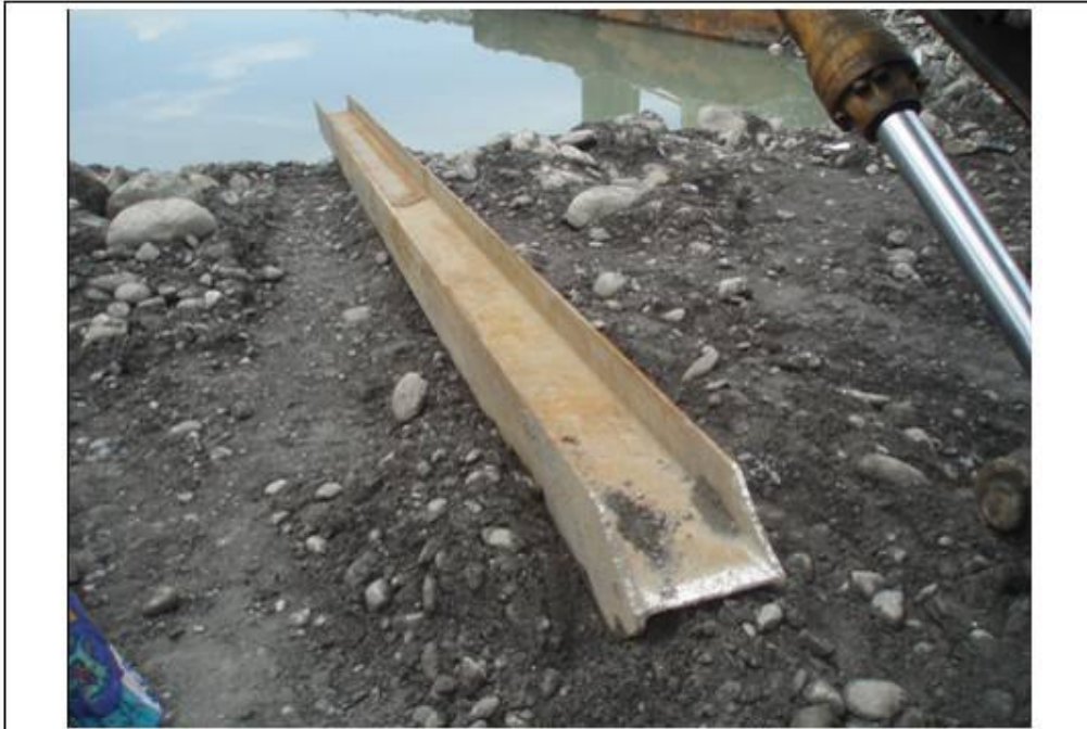
照片二 本災害落下之H型鋼(每根約 1.3 公噸)
