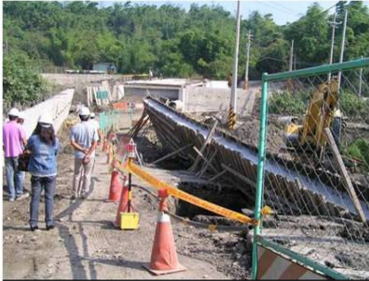
說明：災害發生於○○縣○○鄉本工程之椿號約 0K+119 之擋土牆倒塌處
