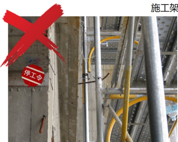
施工架無繫牆桿繫結固定於建物
