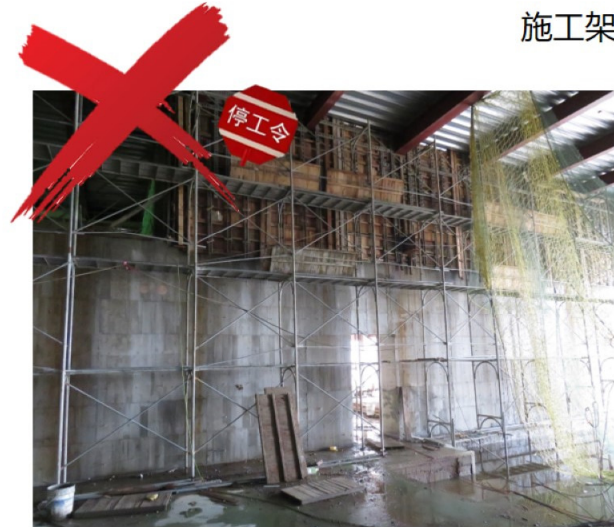
施工架無繫牆桿繫結固定於建物
