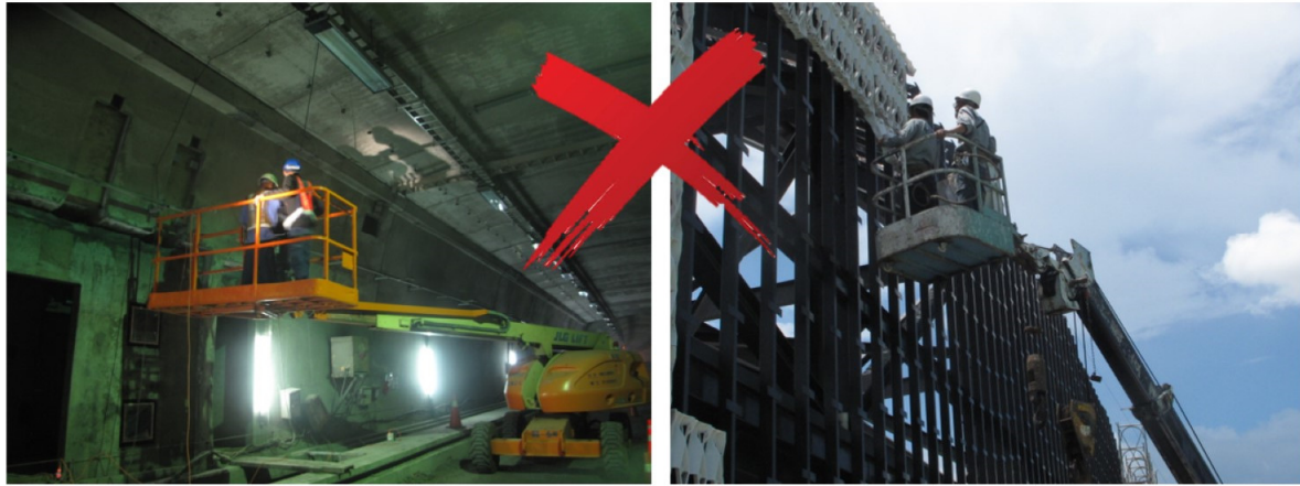
高空工作車作業勞工未使用安全帶
