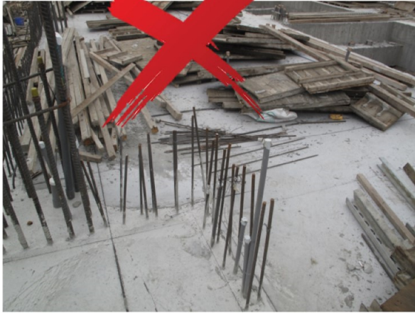
裸露鋼筋未彎曲
