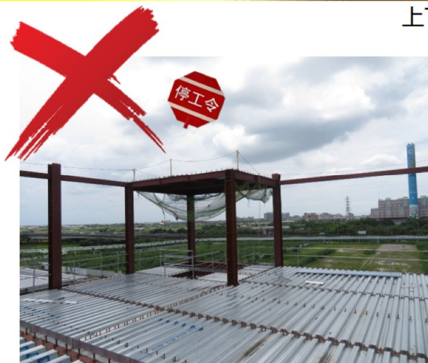
屋突未設上下設備及護欄
