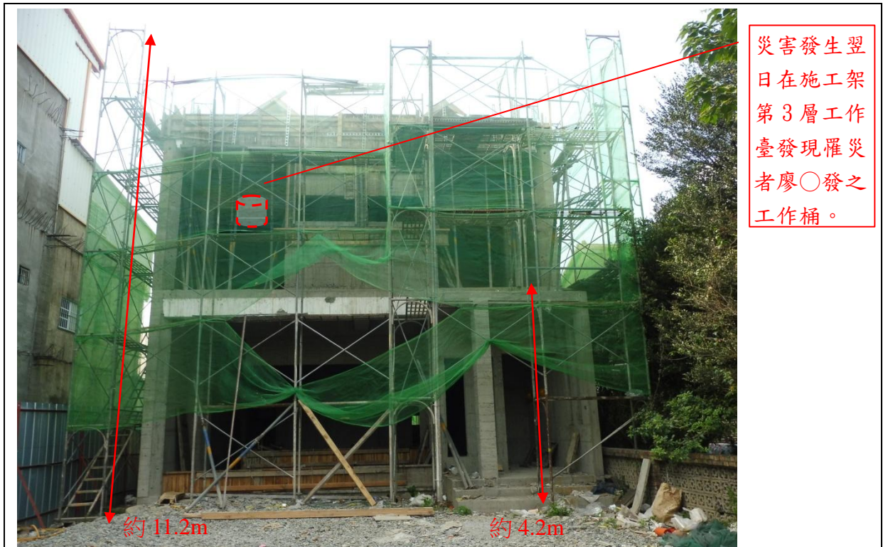
附照 1：外牆施工架高約 11.2 公尺，2 樓樓板(高約 4.2 公尺)開口部分未設置護欄。
