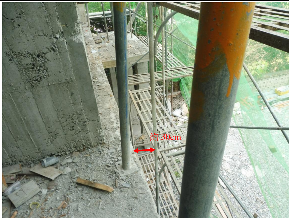
附照 2：2 樓樓板開口部分未設置護欄，與外牆施工架間隙開口約 30 公分。
