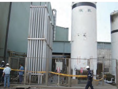
危險性工作場所（高壓氣體類壓力容器）
