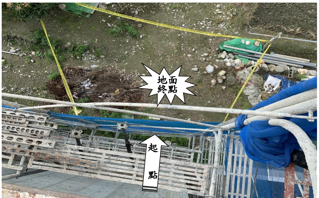
照片 3：經查對罹災者莊 00 當日所作業之該層施工架僅鋪設 1 片 0.3 公尺寬度之踏板，未滿鋪而形成 1.8 公尺×0.4 公尺之開口，外側亦未設置下拉桿。
