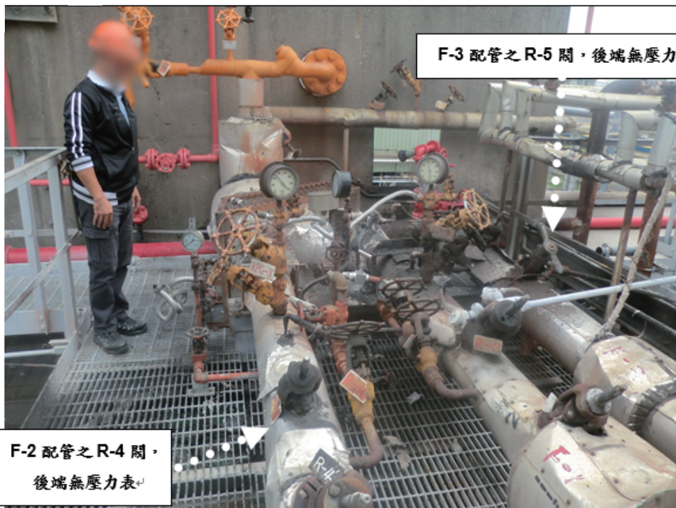
▲ R-4及R-5閥後端無壓力表，且未標示啟閉狀態。
