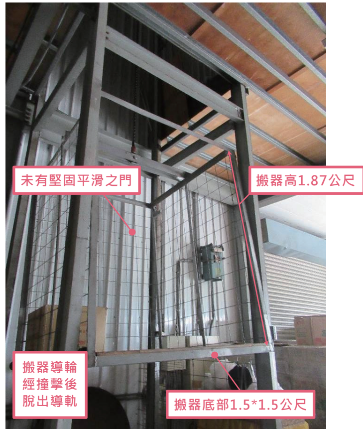
▲ 升降機搬器現場照片。
