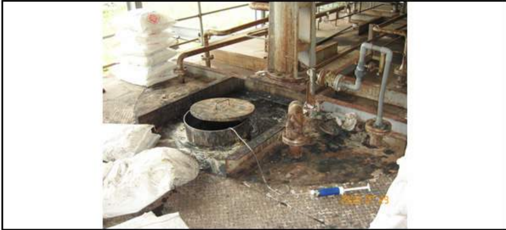
▲ 廢水處理槽內空氣，經檢測結果硫化氫濃度在 120 ppm 以上。
