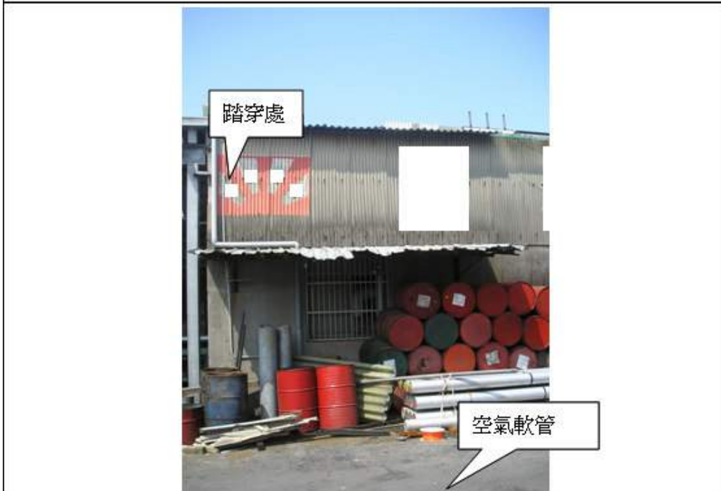
照片八 踏穿處屋外發現空氣軟管 1 卷
