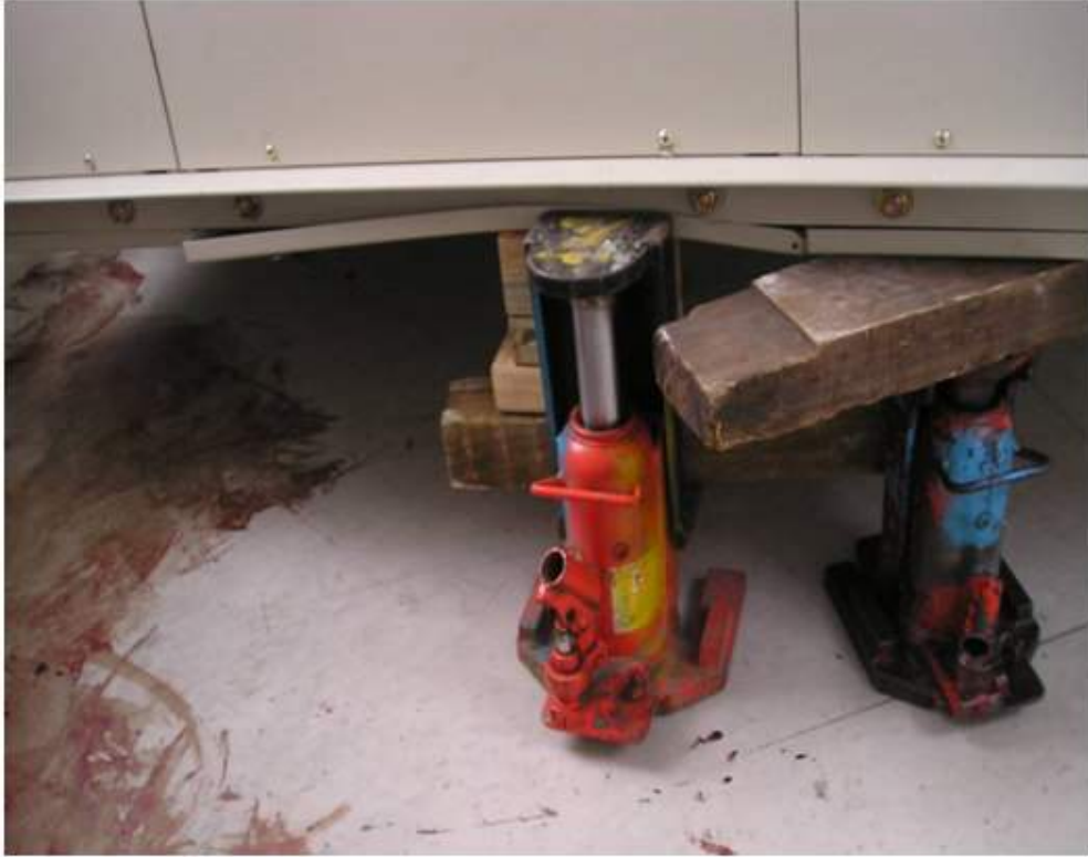
照片 2：罹災者繞至後面並蹲下來以油壓千斤頂（紅色）置於靠外側之低壓電氣控制盤箱底部撐起。
