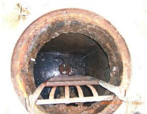
照片一：罹災現場之污水池。
