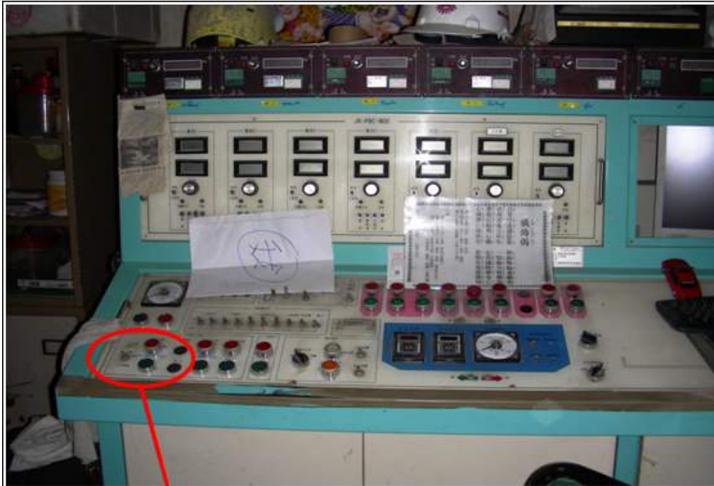
照片五 拌合機及輸送帶控制台
