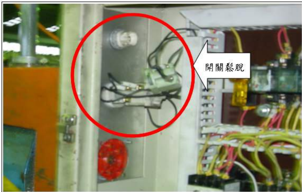
說明 2 切管機控制箱電源控制開關鬆脫情形。
