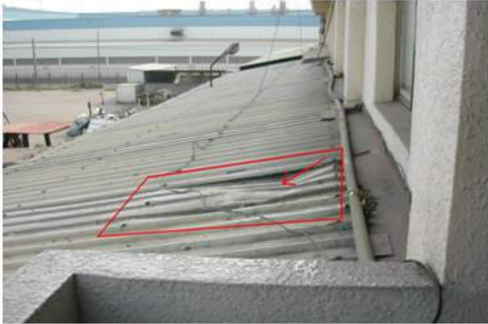
照片 1 發生踏穿棚頂浪板處導致墜落
