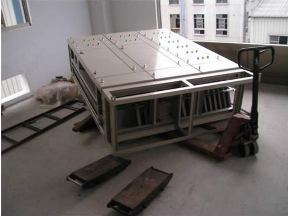
照片 1：低壓電氣控制盤箱往罹災者方向傾倒，造成罹災者嚴重顱腦損傷併顱內出血及兩側氣血胸，休克死亡。
