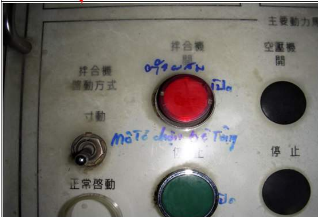
照片六 拌合機控制開關
