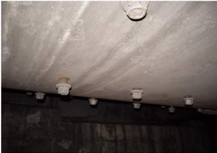
說明 2 煤磨機機體外之螺絲鬆脫情形。
