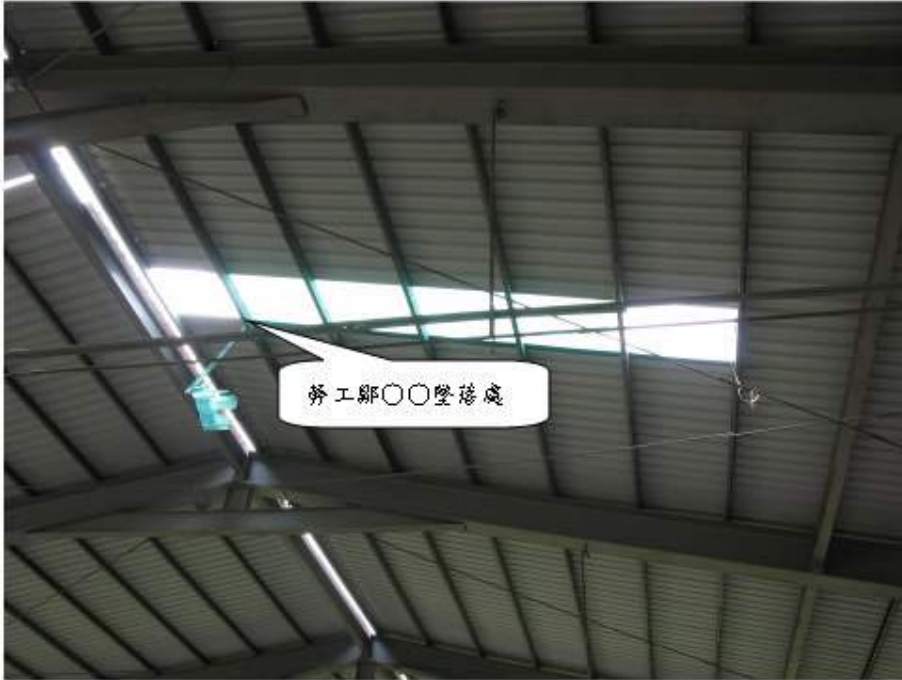
照片 二： 勞工部○○踏穿塑膠浪板墜落處(部員踏穿塑膠浪板約距廠房內側約長 15 米、寬約 14 米處)。
