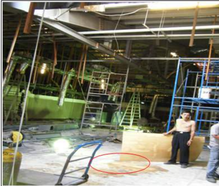
照片一 事故當日罹災者不慎自 3.4 公尺高之屋頂開口處墜落至地面之位置。
