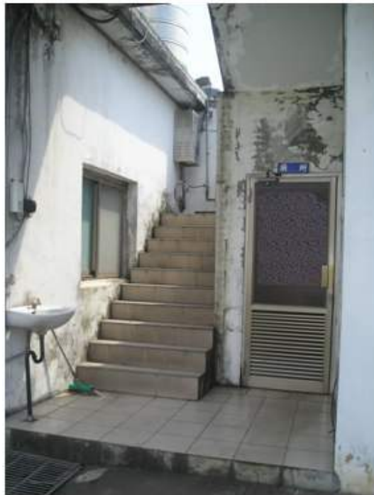
照片十四 推測罹災者係由辦公室旁樓梯爬上屋頂
