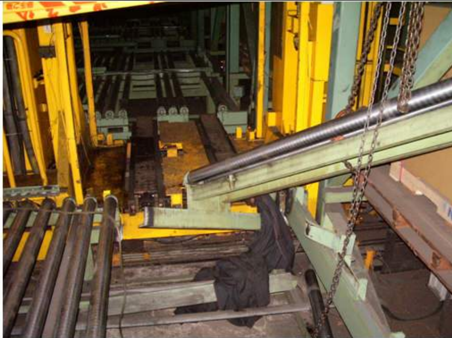
說明 圖三：肇災現場，滾輪鐵架已切斷
