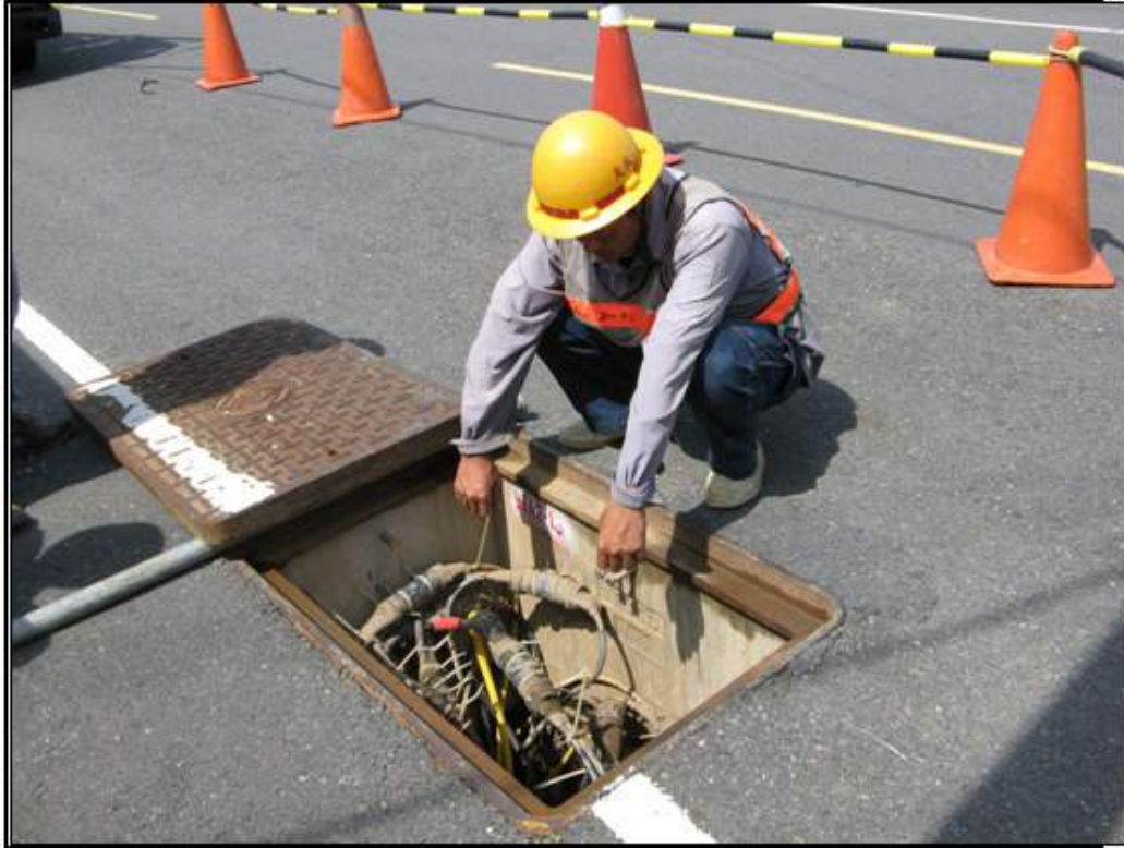
照片 災害發生現場
