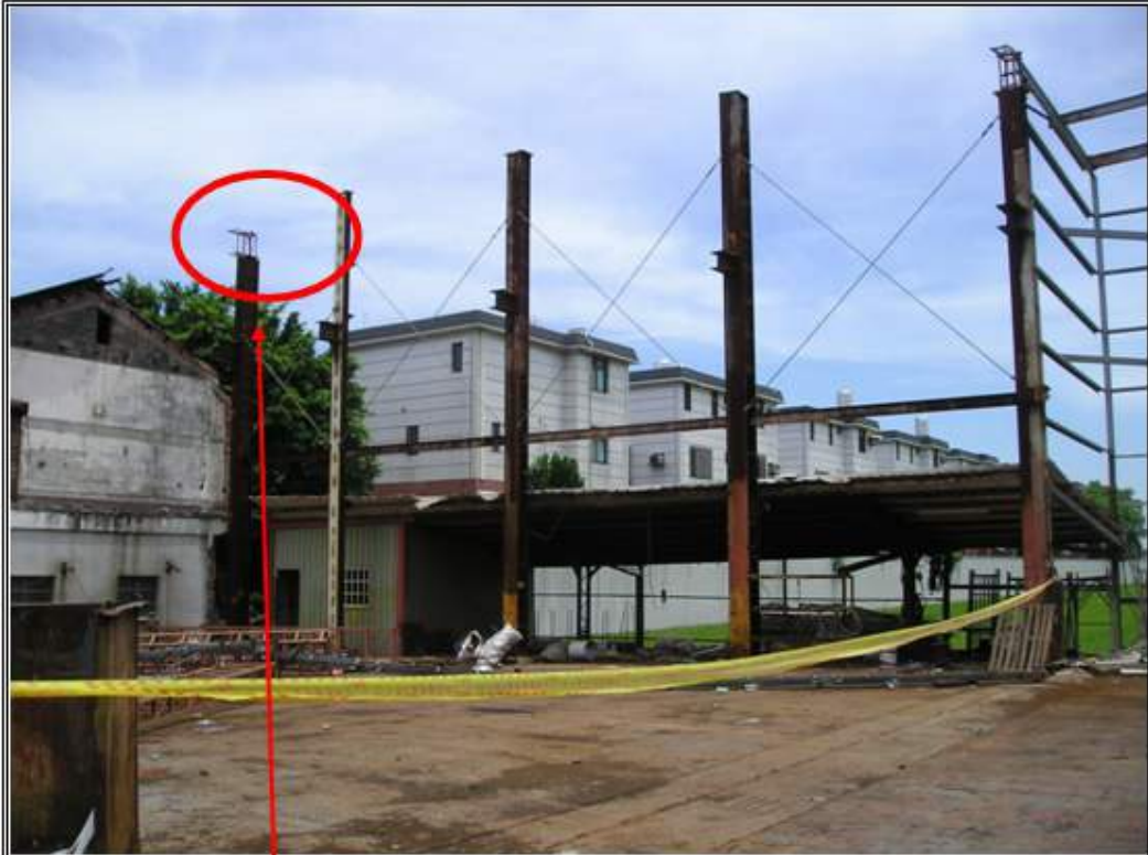
照片：從 H 型鋼攀爬下來時墜落地面。
