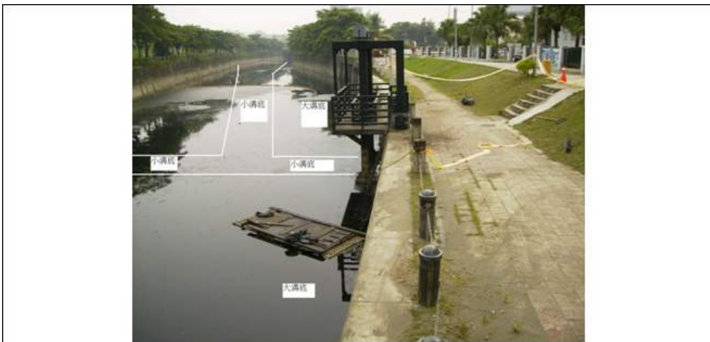
照片 2 攔污柵堤岸附近皆無任何救生圈等救生設備。
