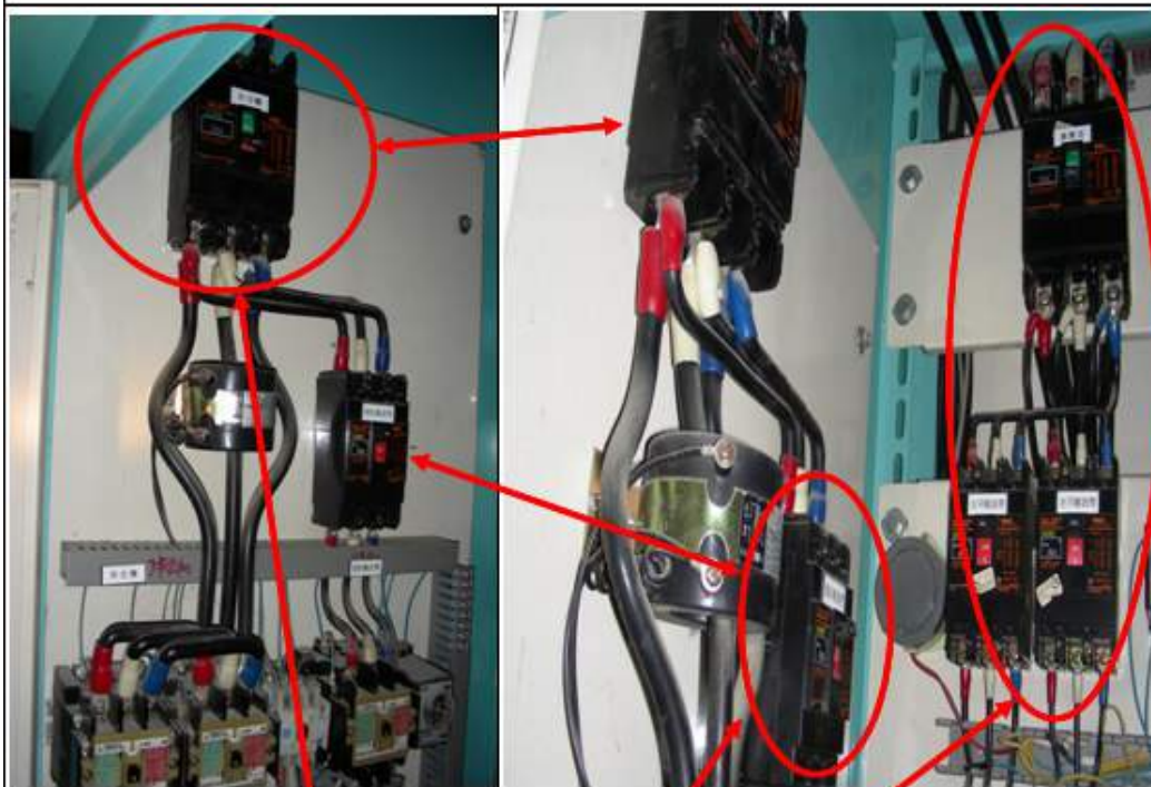
照片八 拌合機及輸送帶(傾斜式 1 條、水平式 2 條)電源開關
