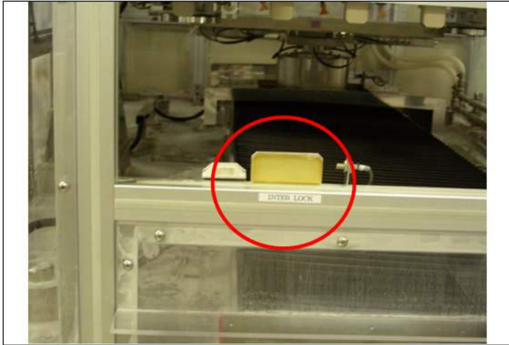
照片二 安全門之連鎖裝置
