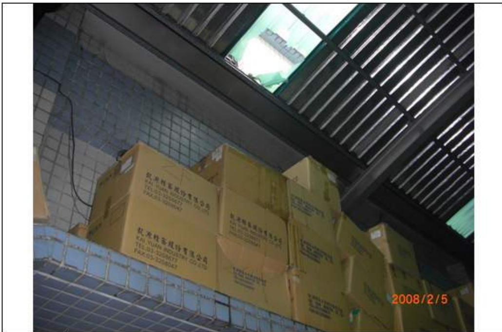
說明 罹災者墜落處遮雨棚採光罩 (由下方拍攝)
