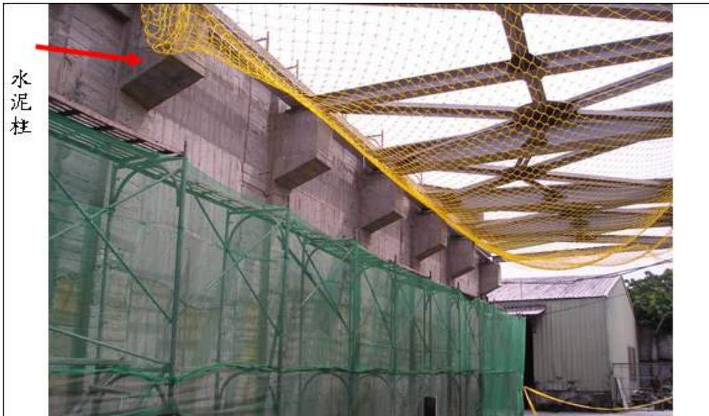
說明照片 1 罹災者游 00 站立於施工架第 2 層上之踏板(由地面至第 2 層踏板處高約 3.3 公尺)從事鎖固 H 型鋼鋼樑與水泥柱之螺栓。
