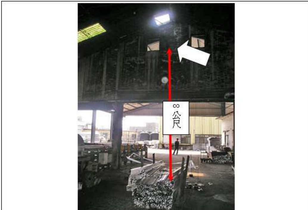
照片五 踏穿處離地面高度約 8 公尺，成 1 公尺*1 公尺開口
