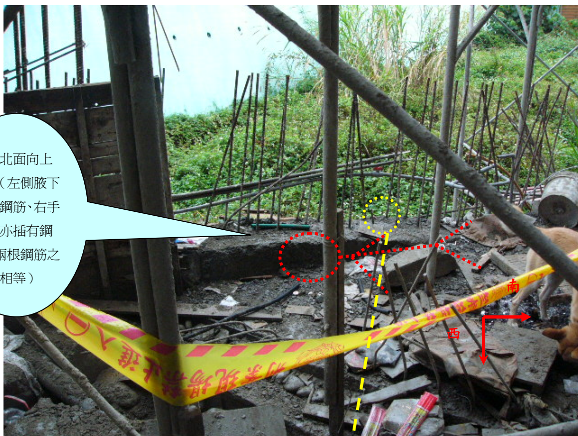
照片 1：災害現場概況
