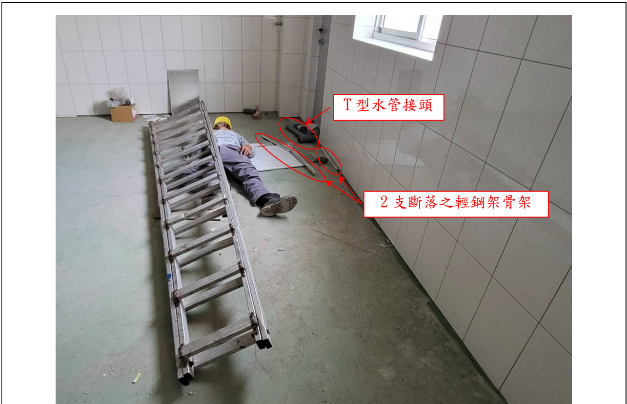
說明 照片 3： 田罹災者從 2.8 公尺處之合梯墜落至地面(仰躺於地面)，合梯伴隨田罹災者翻落並壓在墜落至地面之田罹災者身上(現場模擬照片，罹災者未戴安全帽)，地面上散落 2 支斷落之輕鋼架骨架及 T 型水管接頭。
