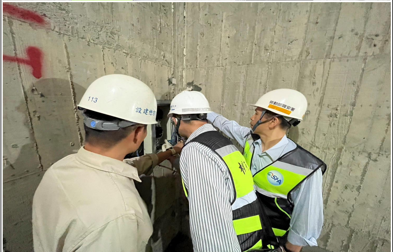
職安署林毓堂副署長與桃園市政府勞動檢查處陳柏良副處長率檢查員前往桃園市某建築工地實施勞動檢查。
