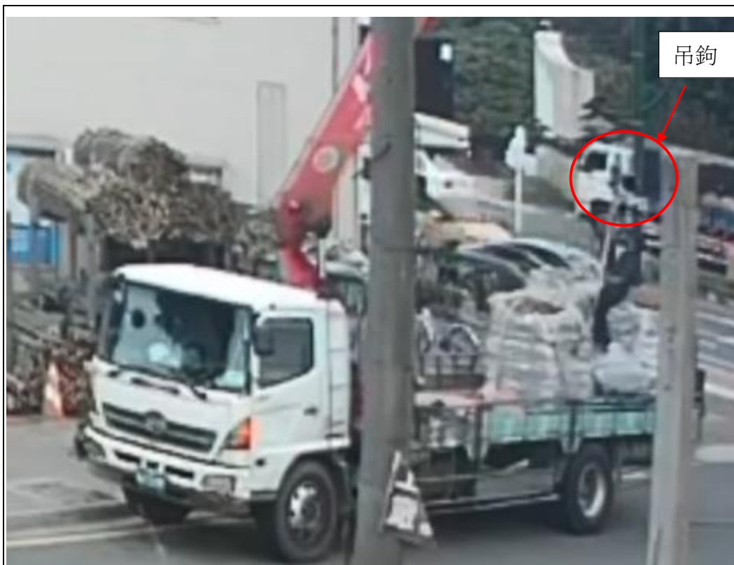
照片 2 吊掛過程中纖維帶突然滑脫，造成吊鉤晃動擊中王○○。
