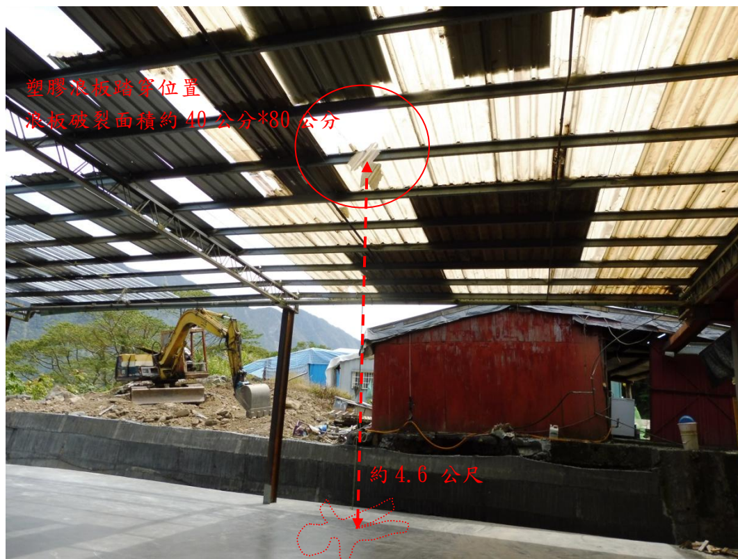
附照 2：遭邱○○踏穿之塑膠浪板破裂面積約 40 公分*80 公分。
