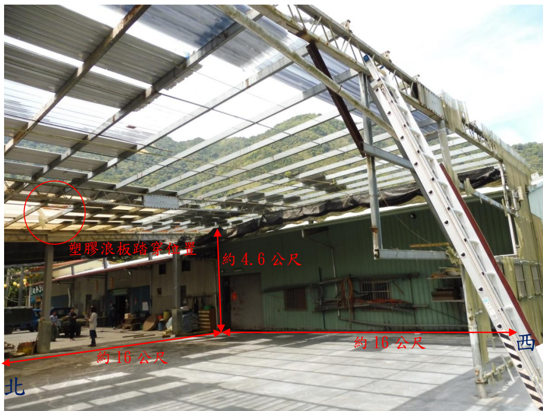
附照 1：四維茶業曬茶區面積約 16 公尺*16 公尺，屋頂高度約 4.6 公尺。屋頂未設置安全母索供鉤掛安全帶，亦未事先規劃安全通道及於屋架上設置適當強度且寬度在 30 公分以上之踏板。
