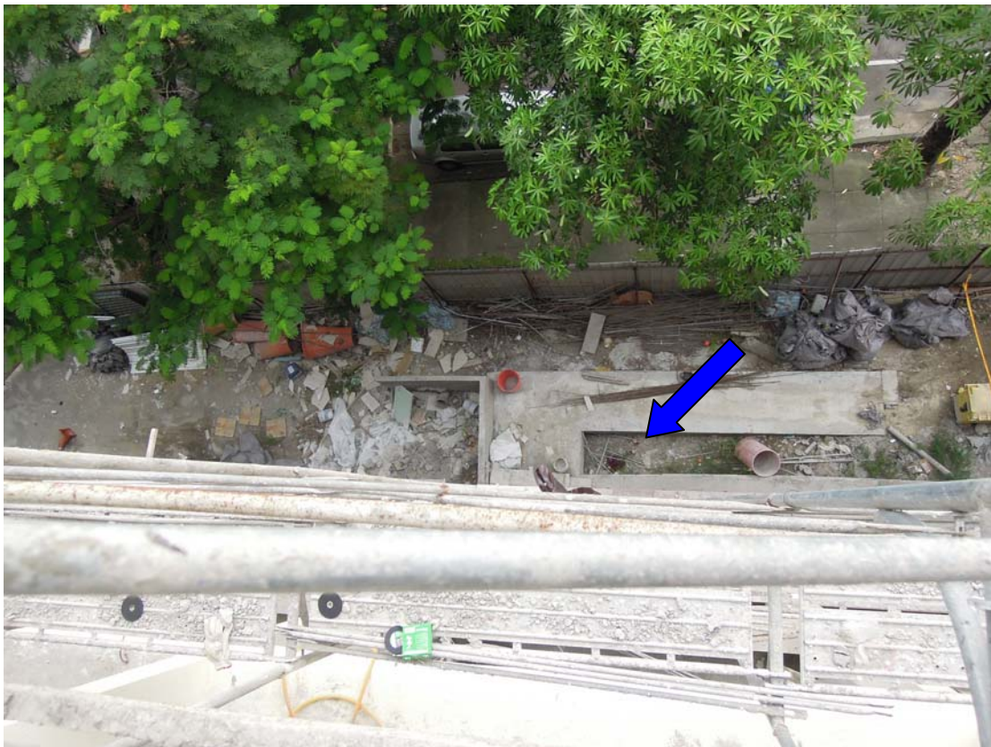
照片 2 墜落位置照片
