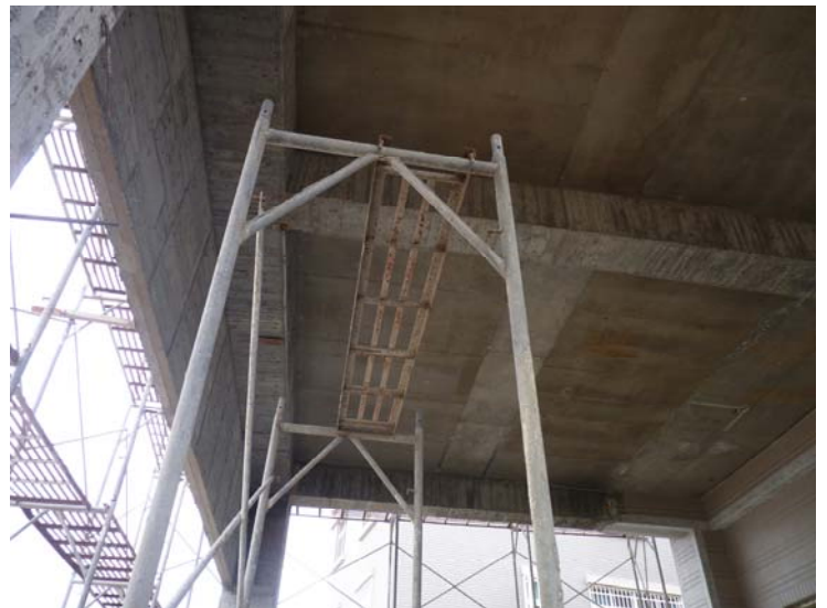
照片 2 罹災者欲拆除樑底模， 拆除時掉落撞擊以施工架 搭設的工作台，造成晃動 導致罹災者墜落地面
