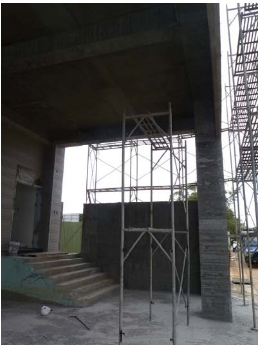
照片 1 罹災者發生墜落之現場
