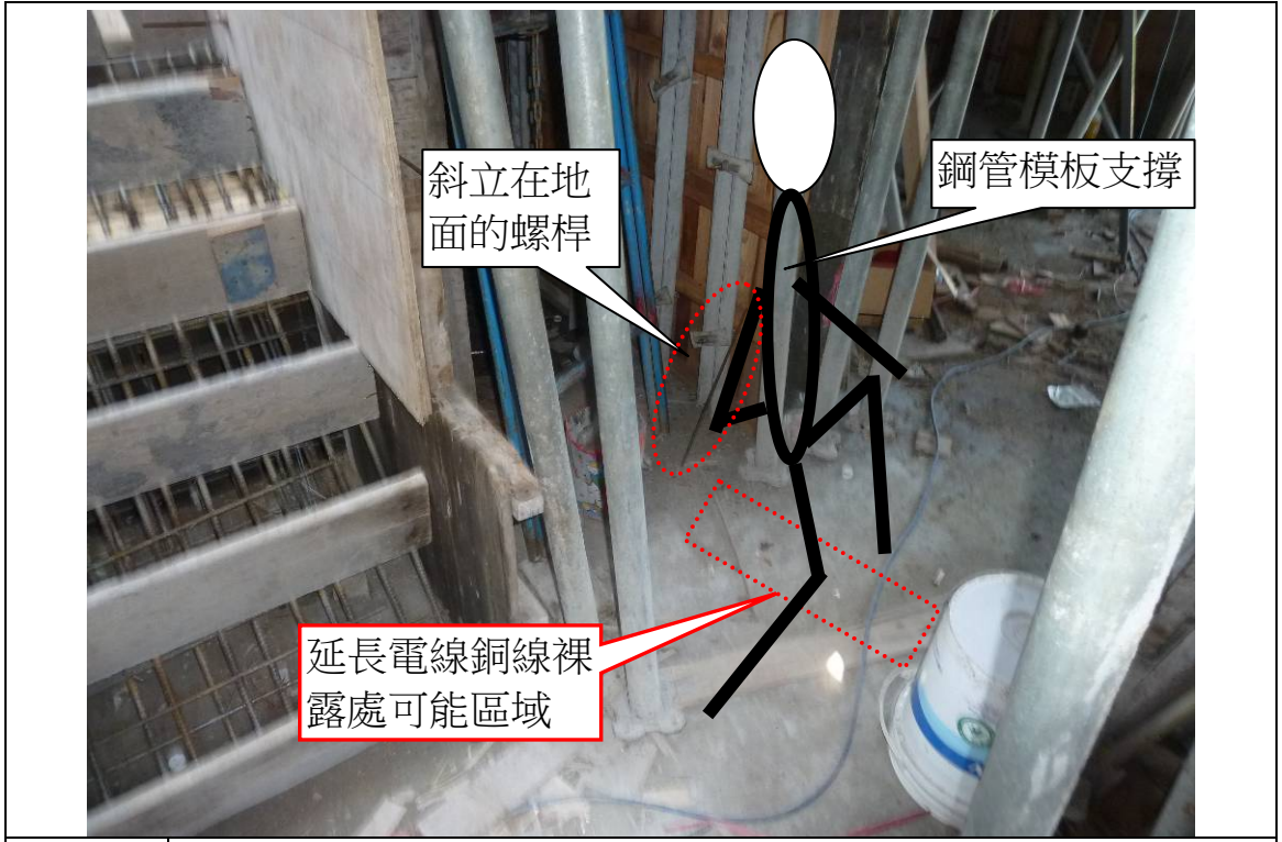
說明 附照 10：感電電流路徑：延長電線裸露處→左膝上緣→心臟→左手臂內側→鋼管模板支撐
