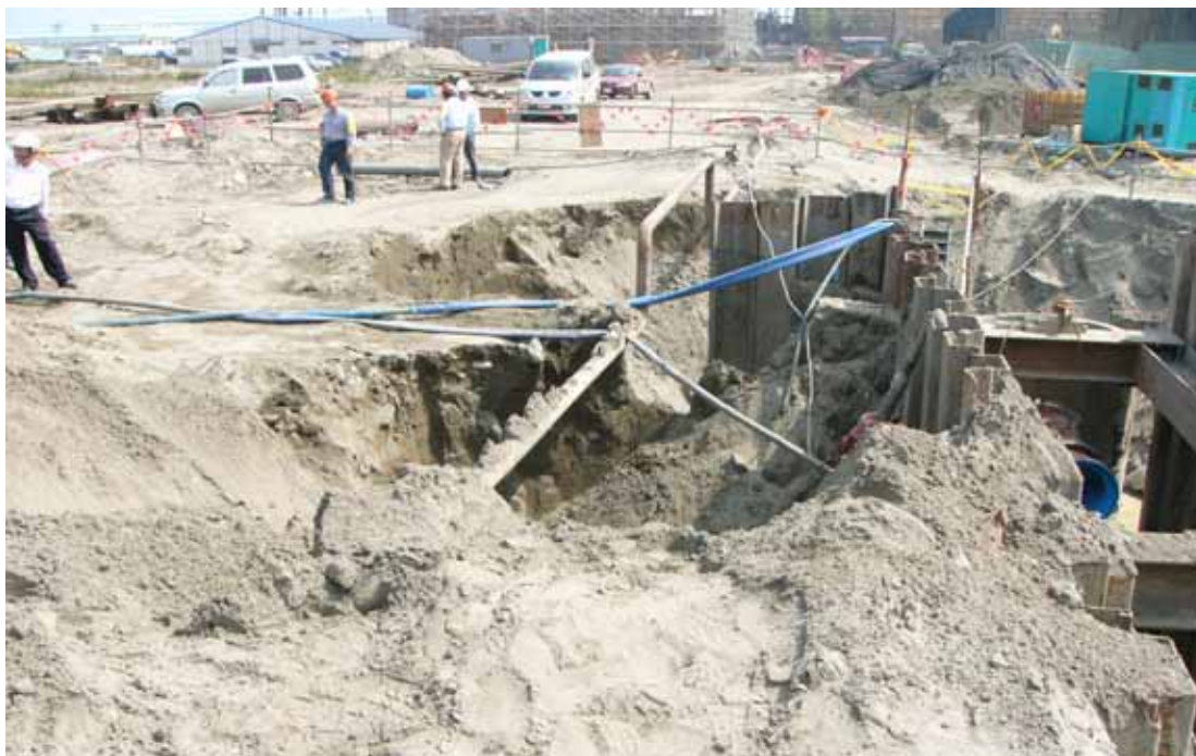
照片 1：災害發生位置
