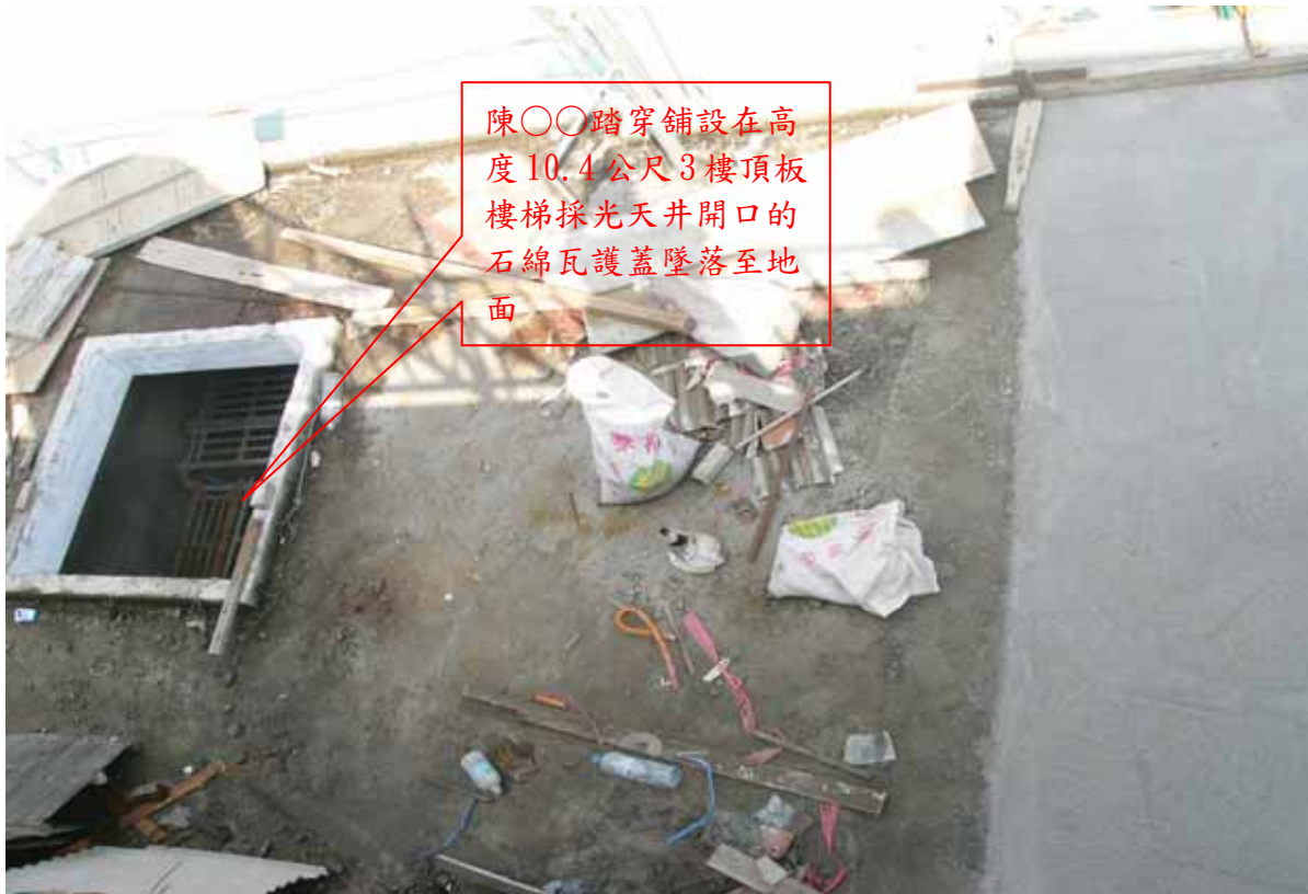
照片 1：災害發生位置
