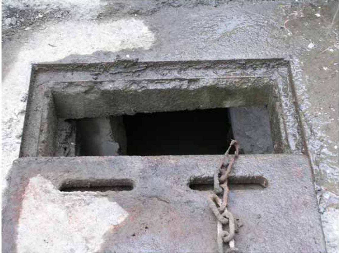
照片 1：災害發生位置
