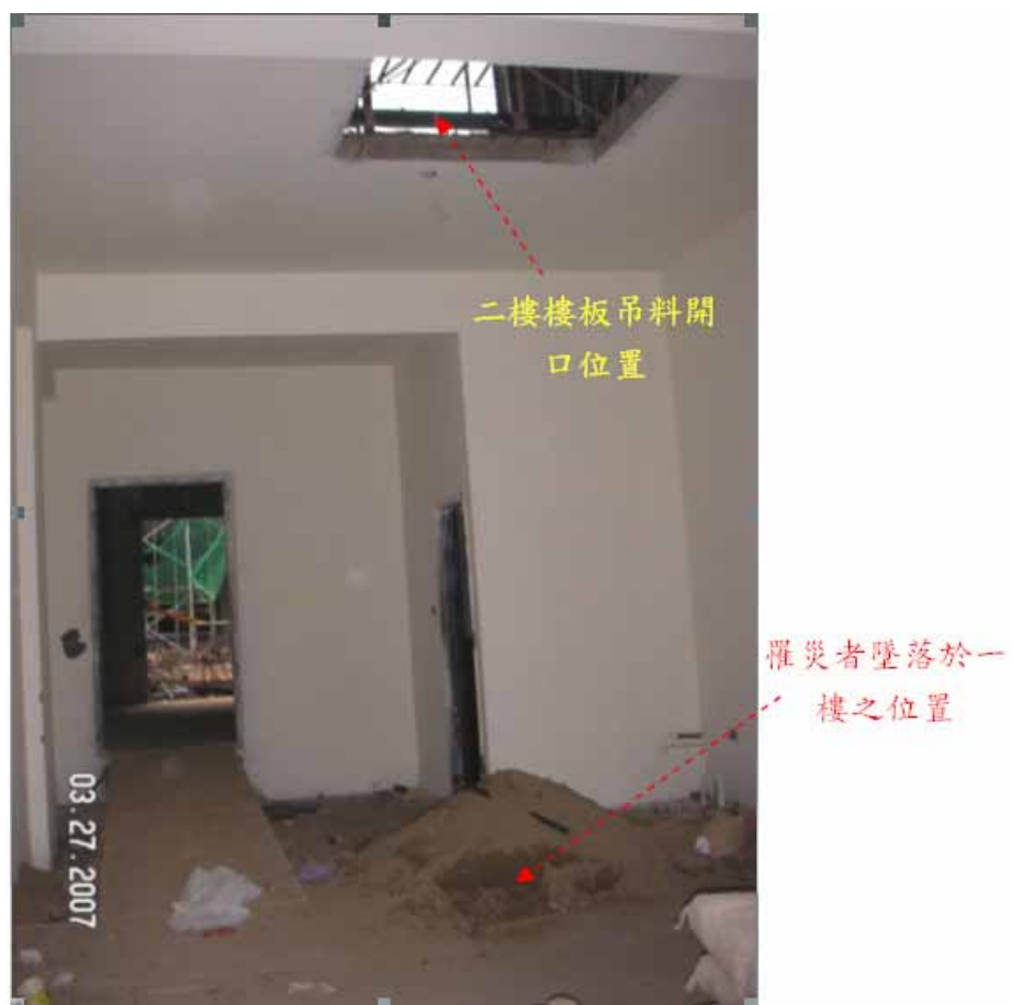
照片 2：罹災者墜落地面之位置
