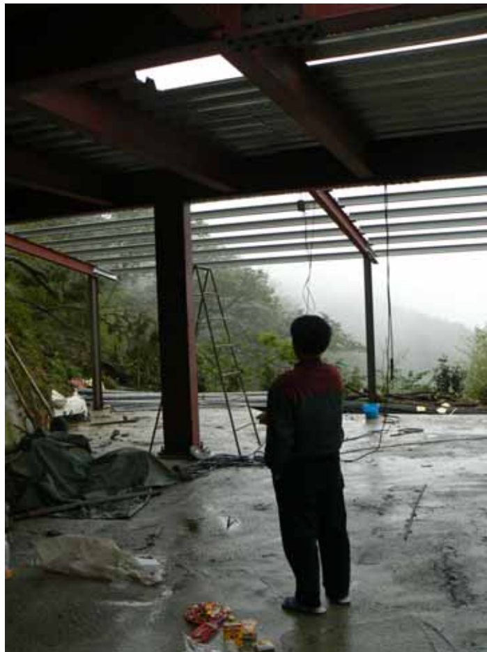
照片 1：罹災者從車庫頂板 (高約 3.4 公尺)墜落至地面
