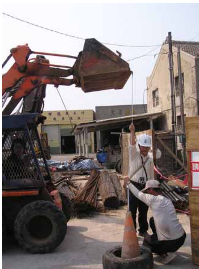
照片 2：現場鏟土機之鏟斗升高後高度為 2.6 公尺
