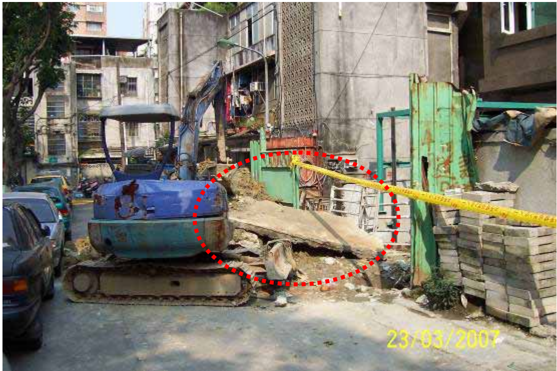
照片 2：工地正門前之挖土機及崩落之混凝土版塊
