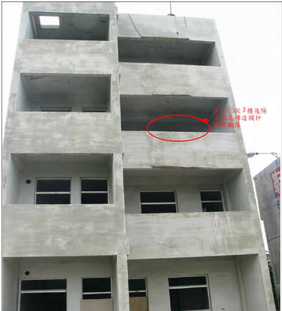
照片 1：王○○住宅新建工程為地上 4 層樓之 RC 構造物；樓層高度分為 1 樓層高 360 公分、餘層高均為 330 公分。
