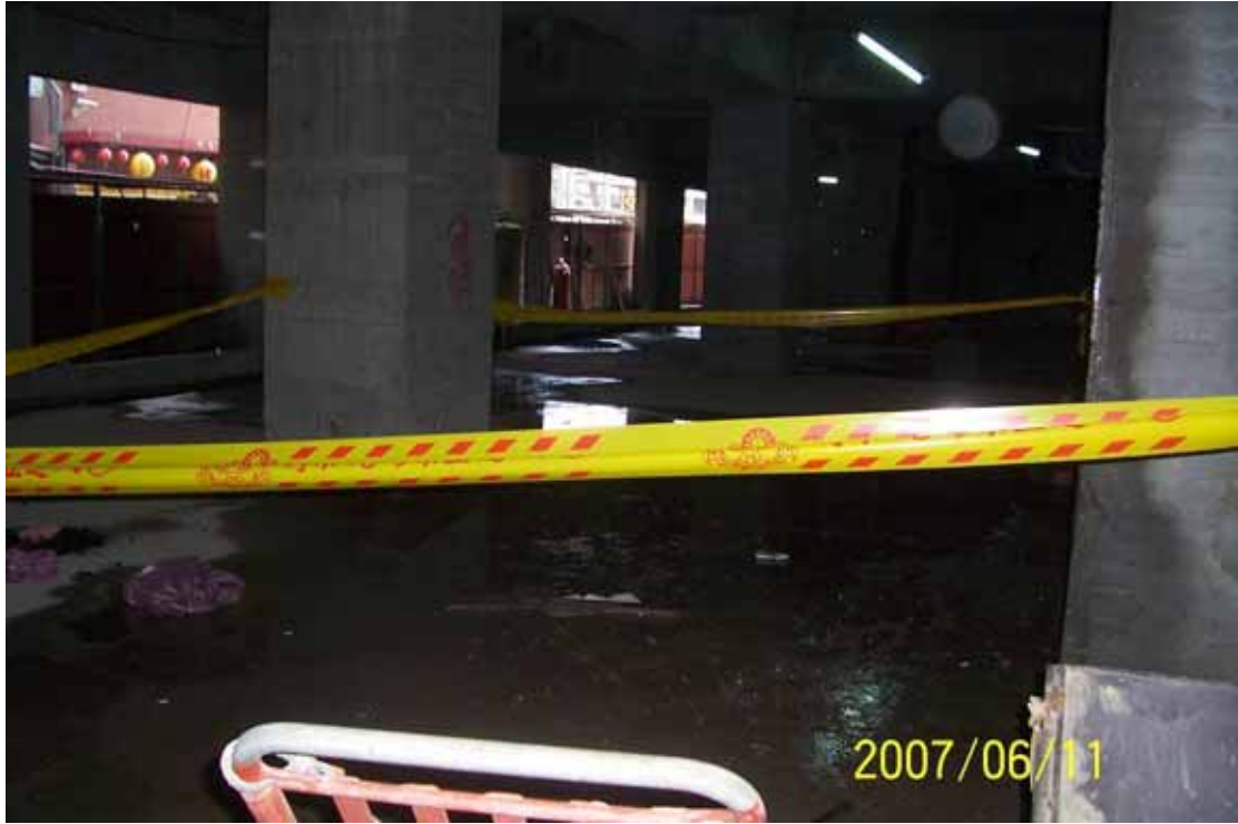
照片 1：罹災者從管道開口墜落至 1 樓地面
