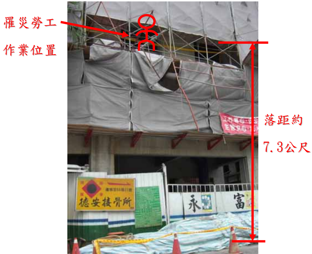
照片 1：工地現場施工架及斜籬設置情形， 罹災者墜落位置、高度
