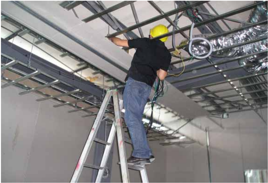
照片 1：現場量測所有線頭及輕型鋼未發現有帶電，又罹災者所站位置為圖中更上一格距地面 2.3 公尺
