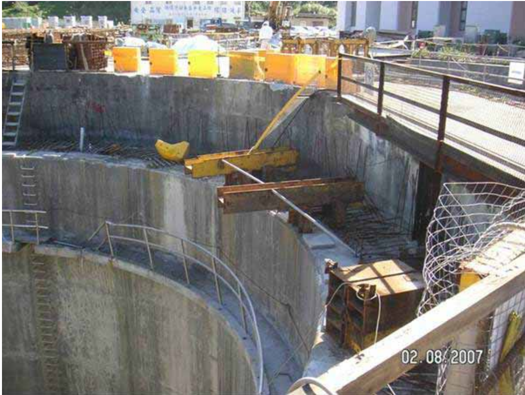
照片 4：1.事發後數堆支撐用型鋼位置已被移至災害發生處旁之護欄邊；2.事發後部份支撐用型鋼及軌道鋼樑已隨挖土機掉落至井底
