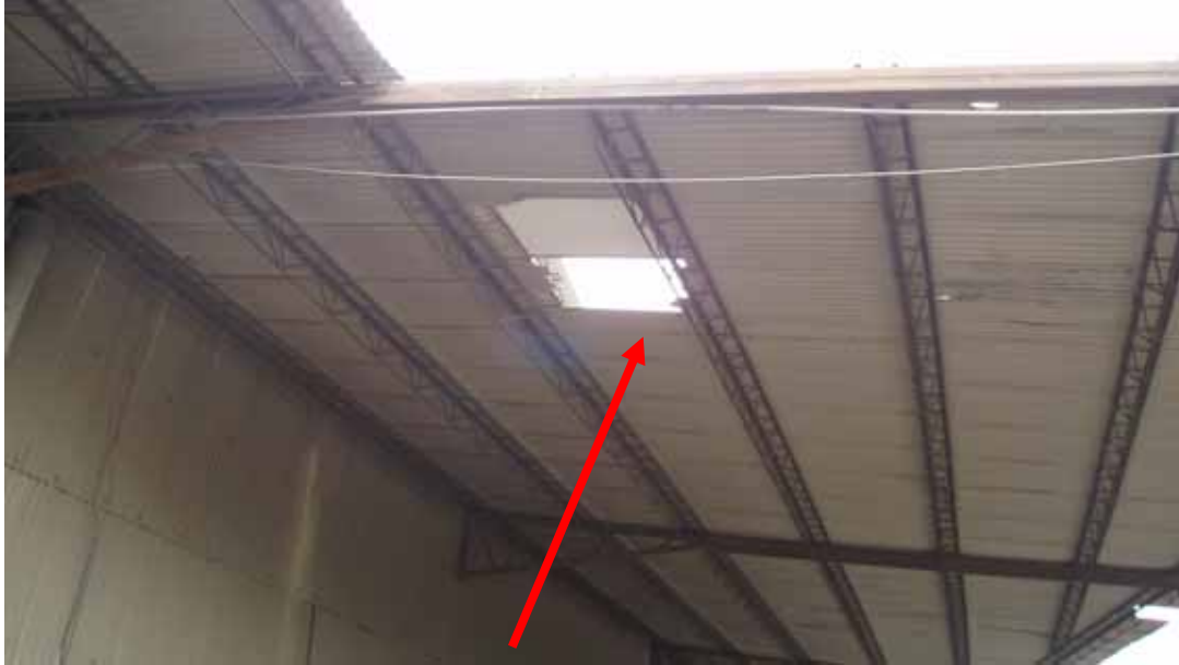
照片 1：廠房屋頂破破一長約 40 公分寬約 30 公分大洞一大洞，罹災者由此墜落
