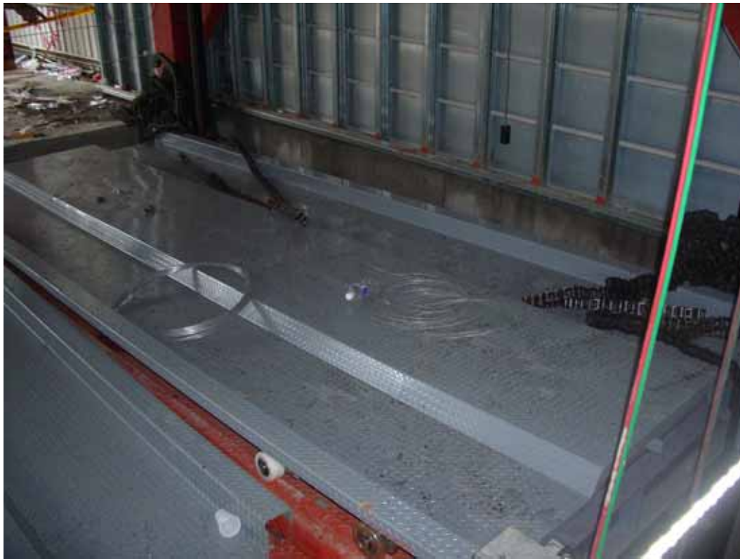
照片 3：現場 40 多米的傳動鍊條斷裂掉落狀。
