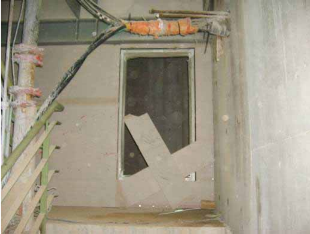
照片 1：墜落起點 FAB 棟 B 梯 1F 往 2F 樓梯轉折平臺之施工中管道間維修門開口
