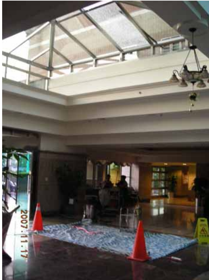
照片 1：事發現場狀況
