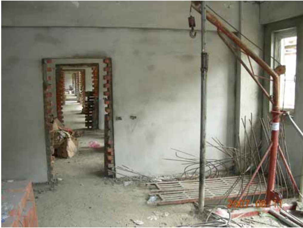
照片 1：事發現場狀況
