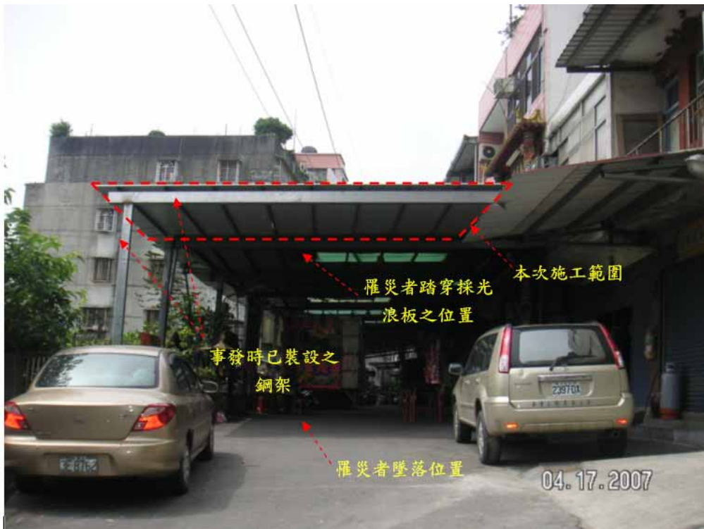
照片 1：罹災者當時墜落相關位置與當時現場狀況
