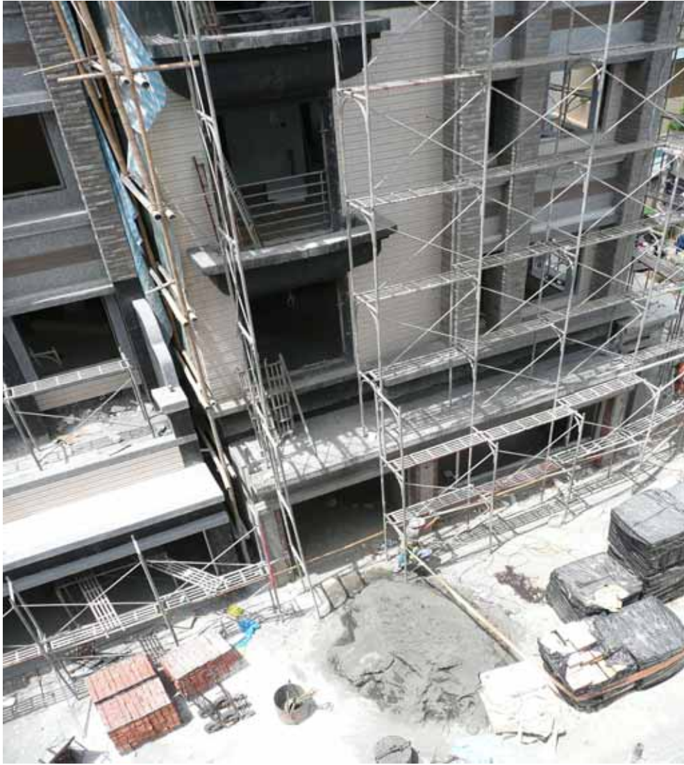
照片 1：災害發生位置
