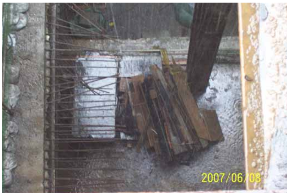
照片 2：構台開口處墜落至車站 C 區穿堂層(落距 16 公尺)
