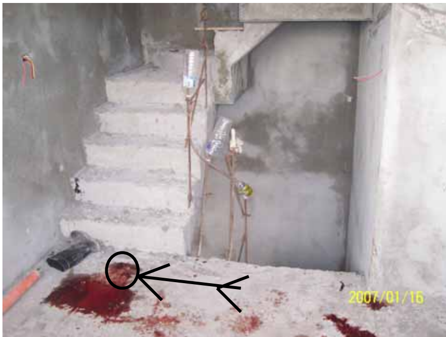
照片 2 罹災者墜落至屋突 2 樓樓板位置圖
