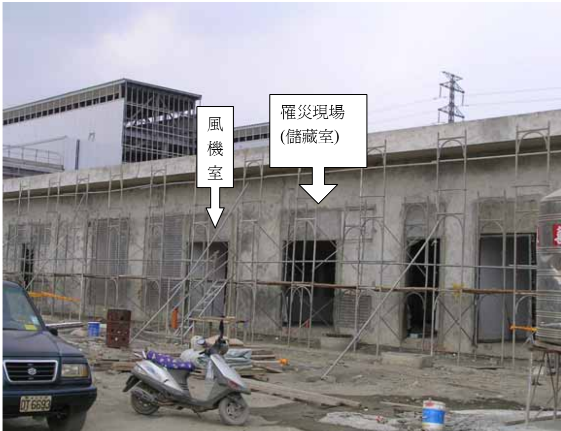
照片 1：罹災處建物全貌
