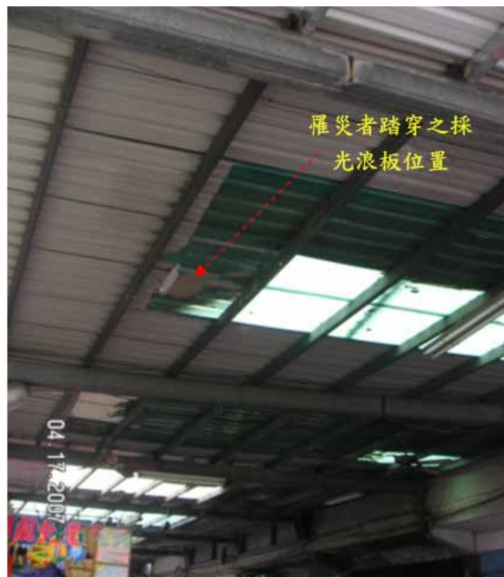
照片 2：罹災者踏穿之採光浪板情形
