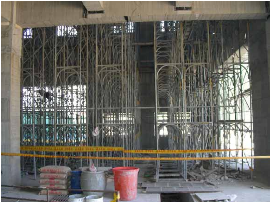
照片 1：事發現場狀況
