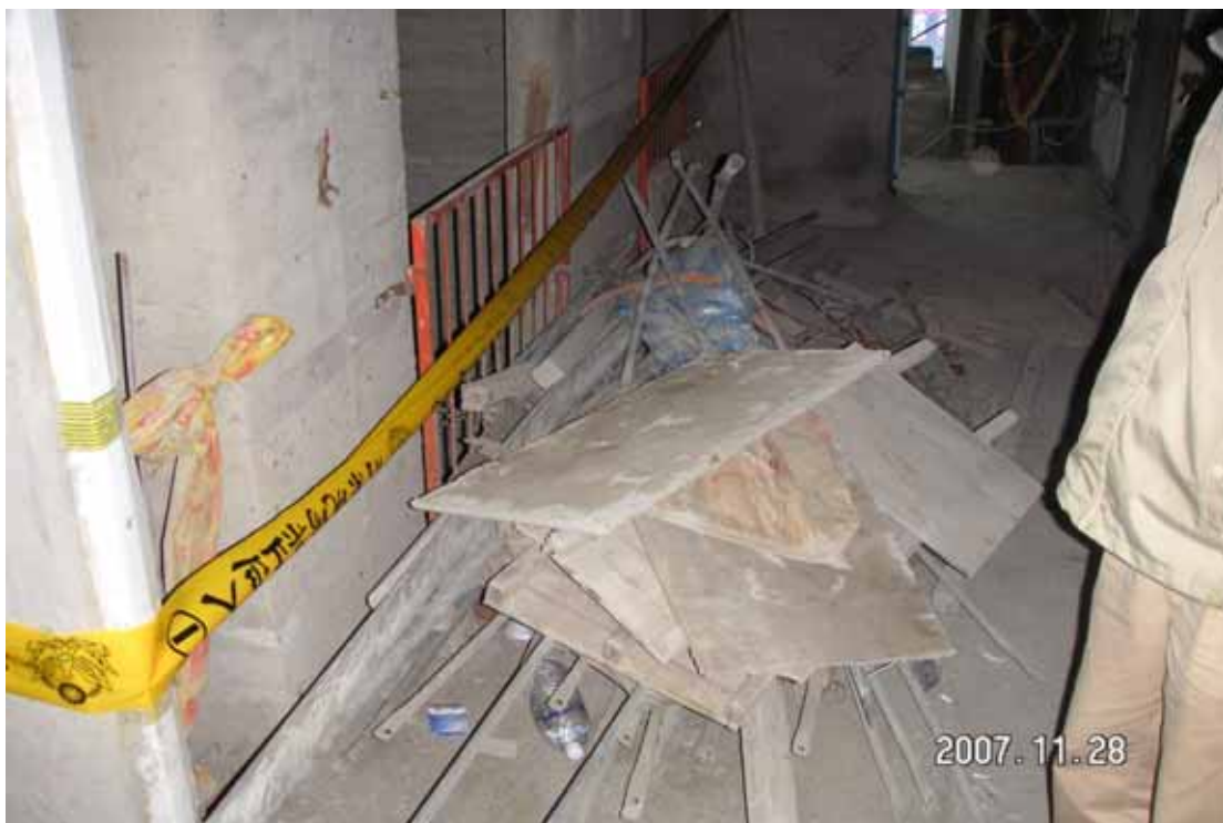
照片 2：事故發生後警方至 H 棟第 15 層電梯間封鎖事故現場，當時該 H 棟第 1 層電梯間左側電梯間之柵門是關閉的，柵門前方整齊堆置有一堆包含施工架桿件、水電 PVC 管材及模板廢料等材料，警方亦有拍照存證
