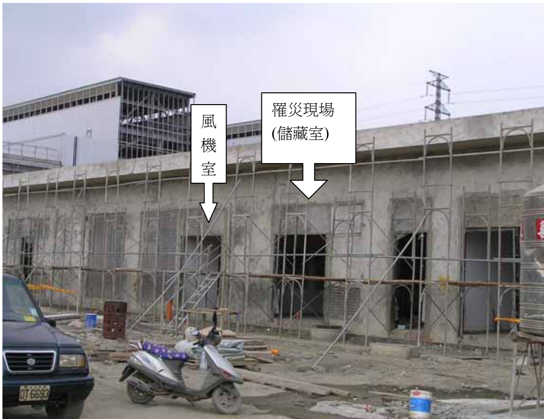
照片 1：罹災處建物全貌
