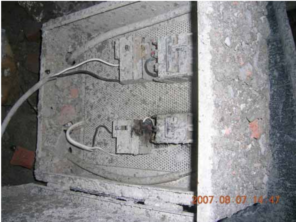
照片 3：臨時配電箱內漏電斷路器均已損壞失效
