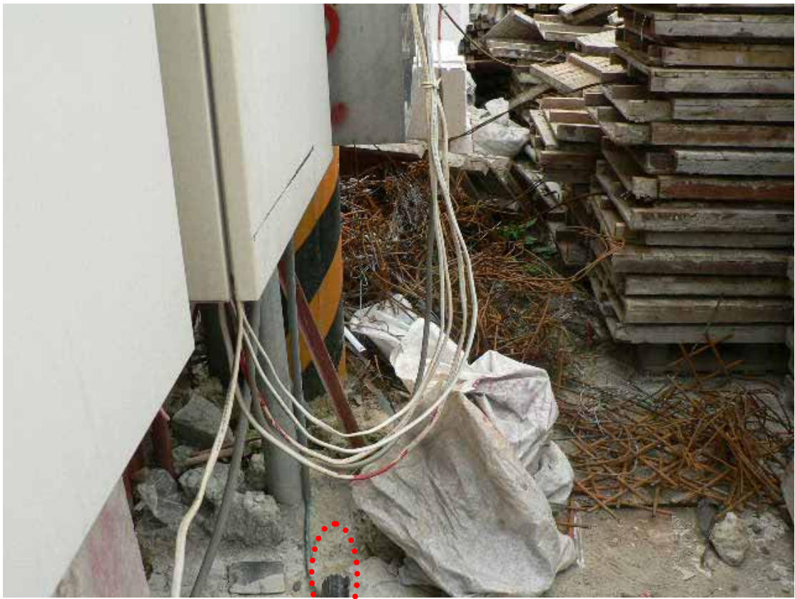
照片 7：進工地右側靠圍籬之主開關箱，地面留有一拆下之無熔絲開關（一）
