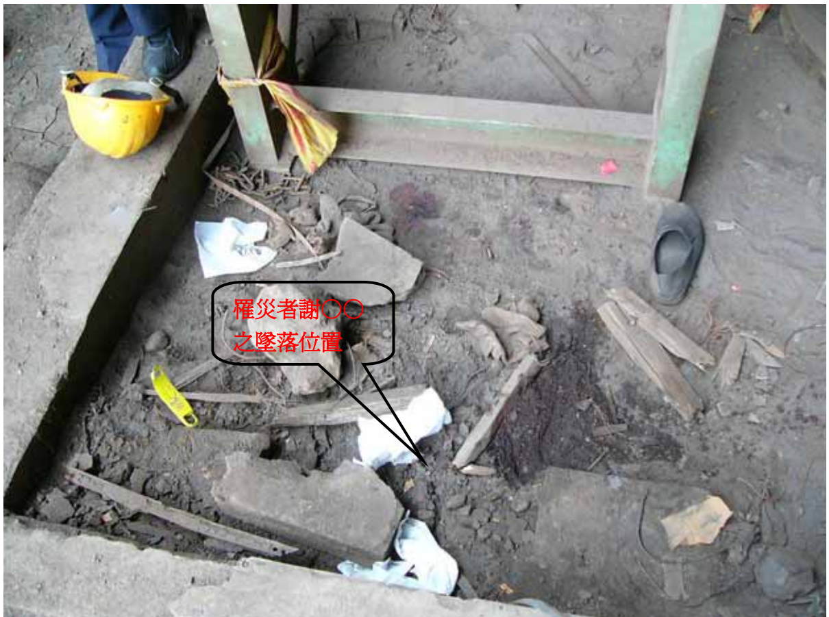
照片 1：罹災者謝○○於鋼構拆除作業時墜落地面之位置
