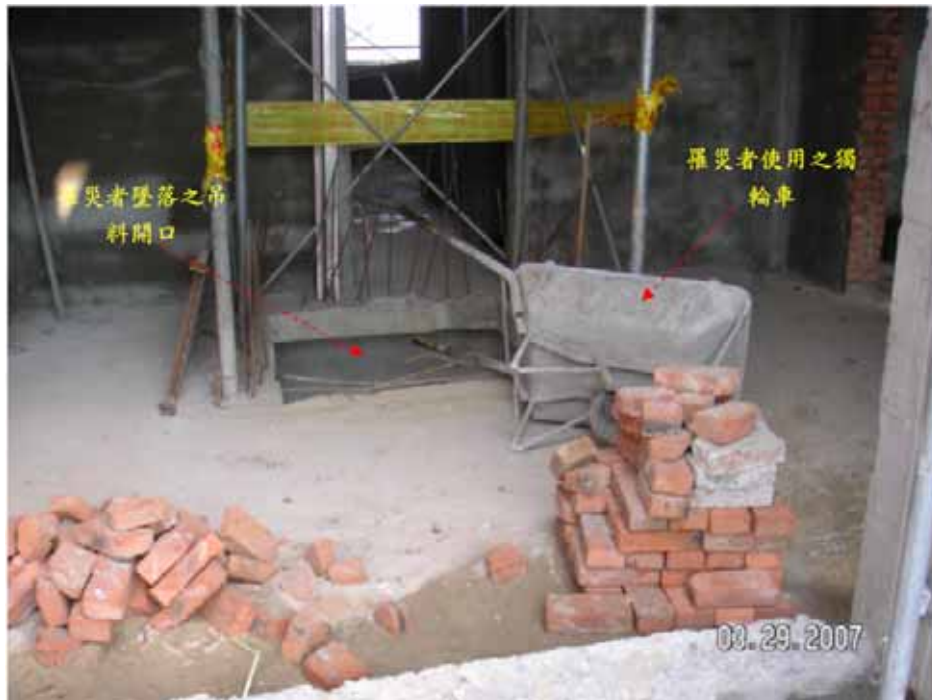
照片 1：罹災者墜落之吊料開口及作業位置
