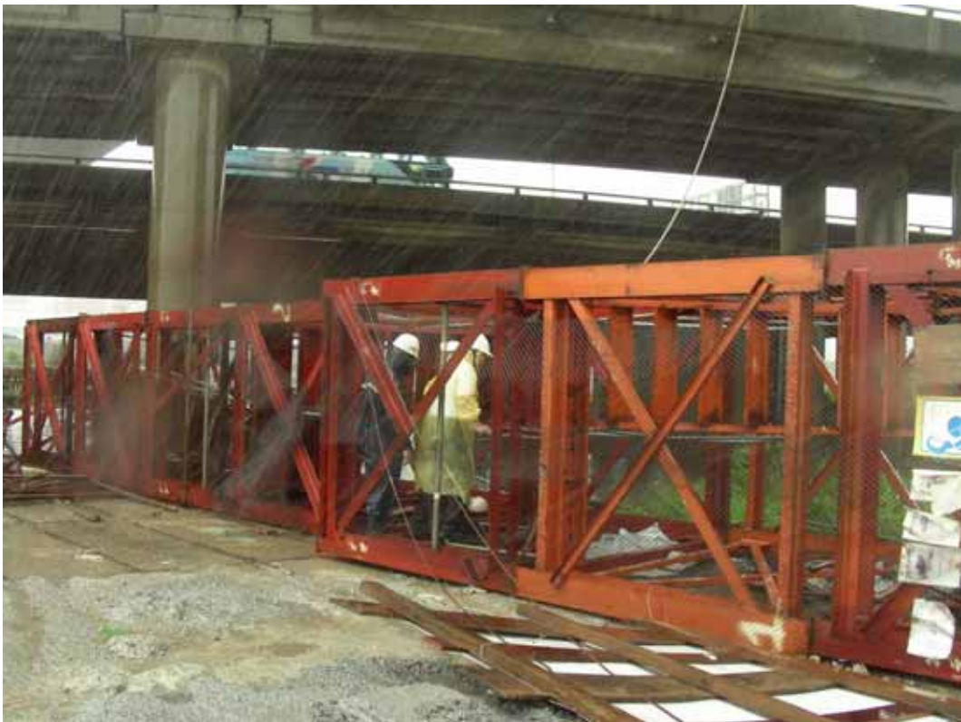
照片 2：本工地 9k+807 (p42 橋墩) 旁之上下樓梯 (由每單元長 3 公尺、寬高各 2 公尺之型鋼框架組立而成，共 12 單元、總高 24 公尺)
