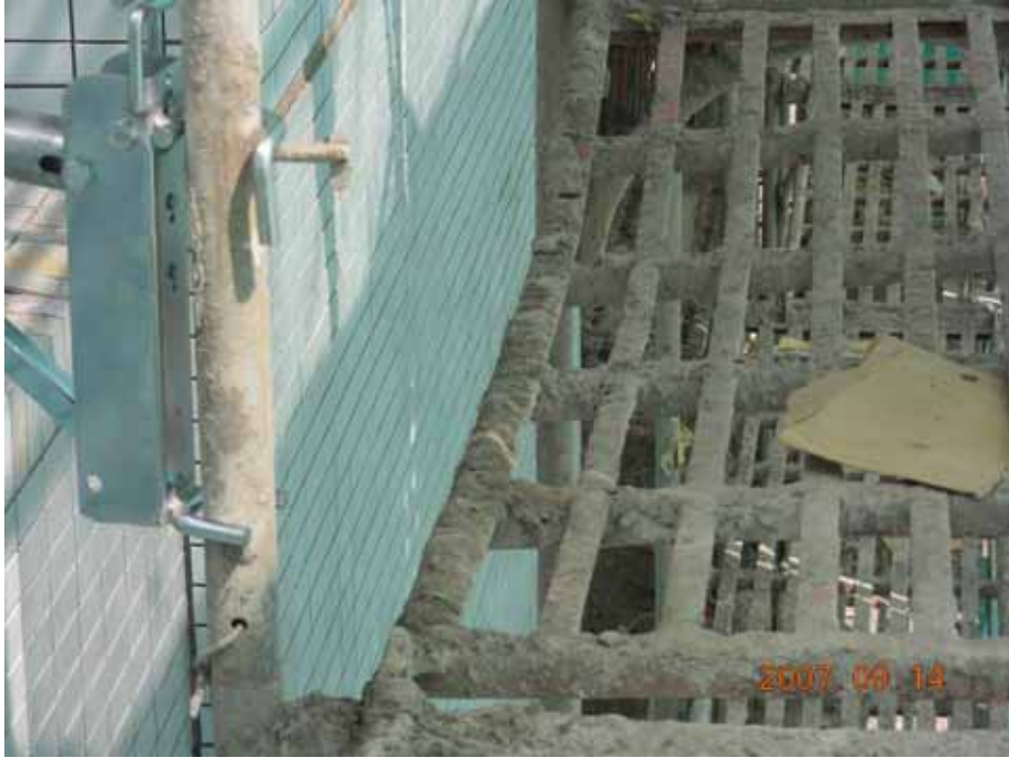
照片 3：罹災者墜落動線上遭撞擊變形之施工架踏板
