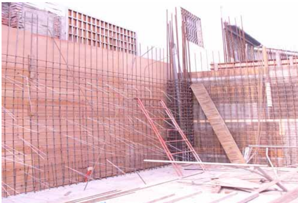
照片 1 罹災者自 3.6 公尺高之牆壁模板上墜落時臉頰被鋼筋插入受傷
