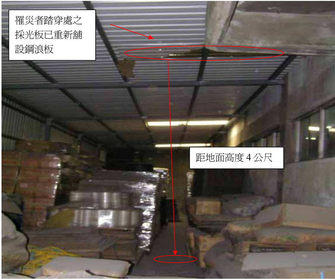
照片 2：罹災者墜落處鄰廠廠房內之情形
