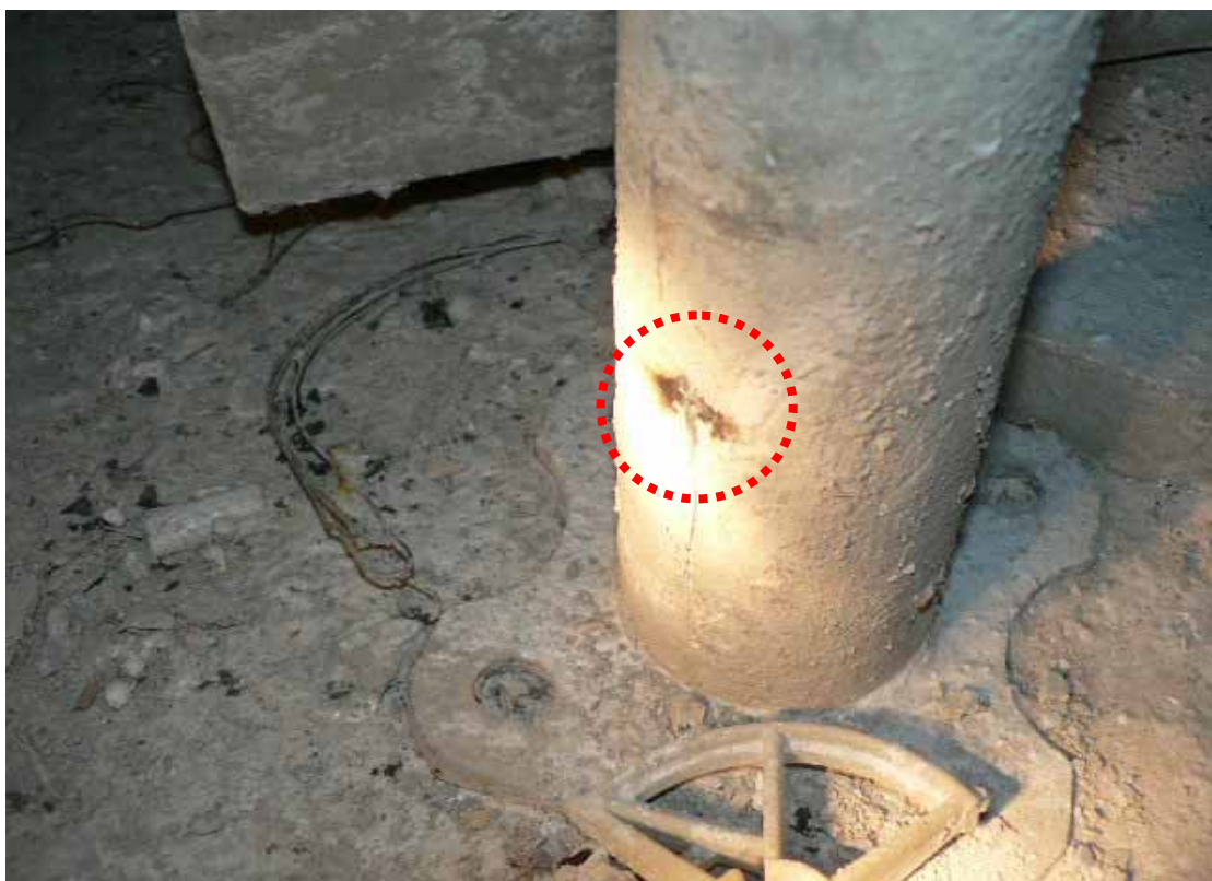
照片 5：災害現場支撐鋼管疑似遭電擊痕跡之一
