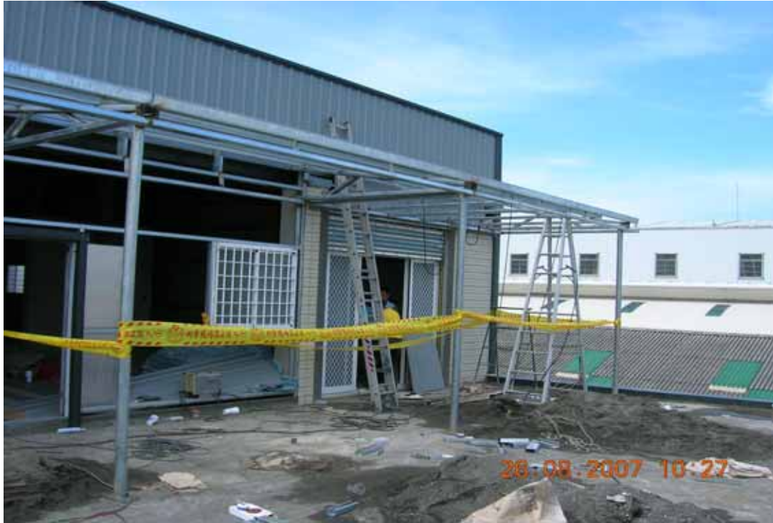
照片 1：災害發生位置
