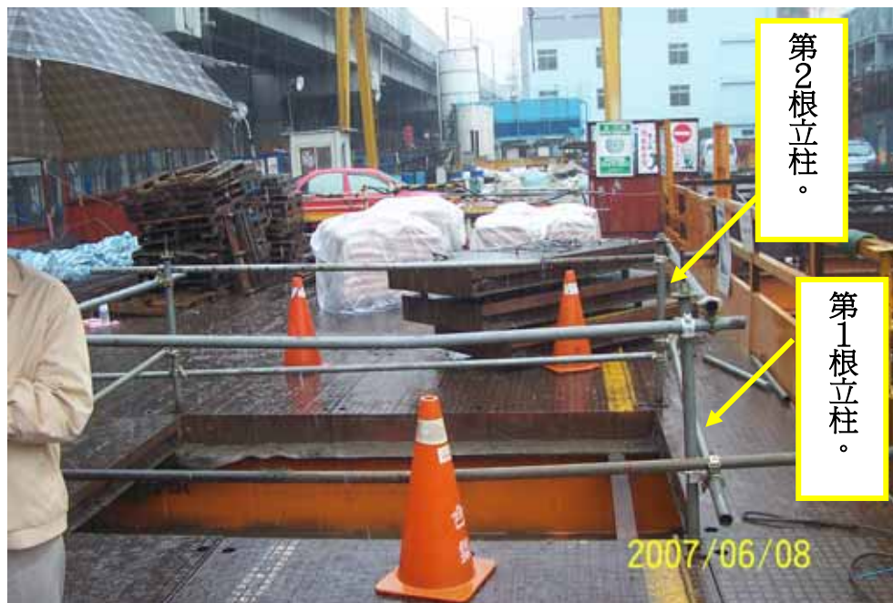
照片 1：於構台上吊運空心磚作業，掀開覆工板後施作護欄， 在固定第 2 根立柱時，因重心不穩，自開口處墜落
