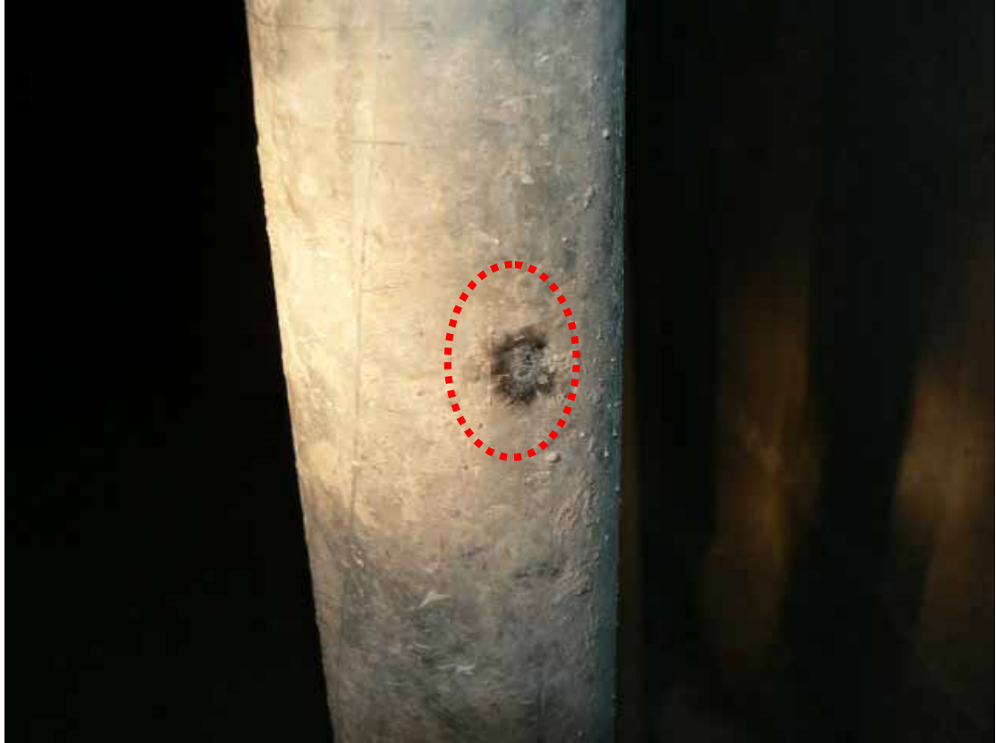
照片 6：災害現場支撐鋼管疑似遭電擊痕跡之二（1）
