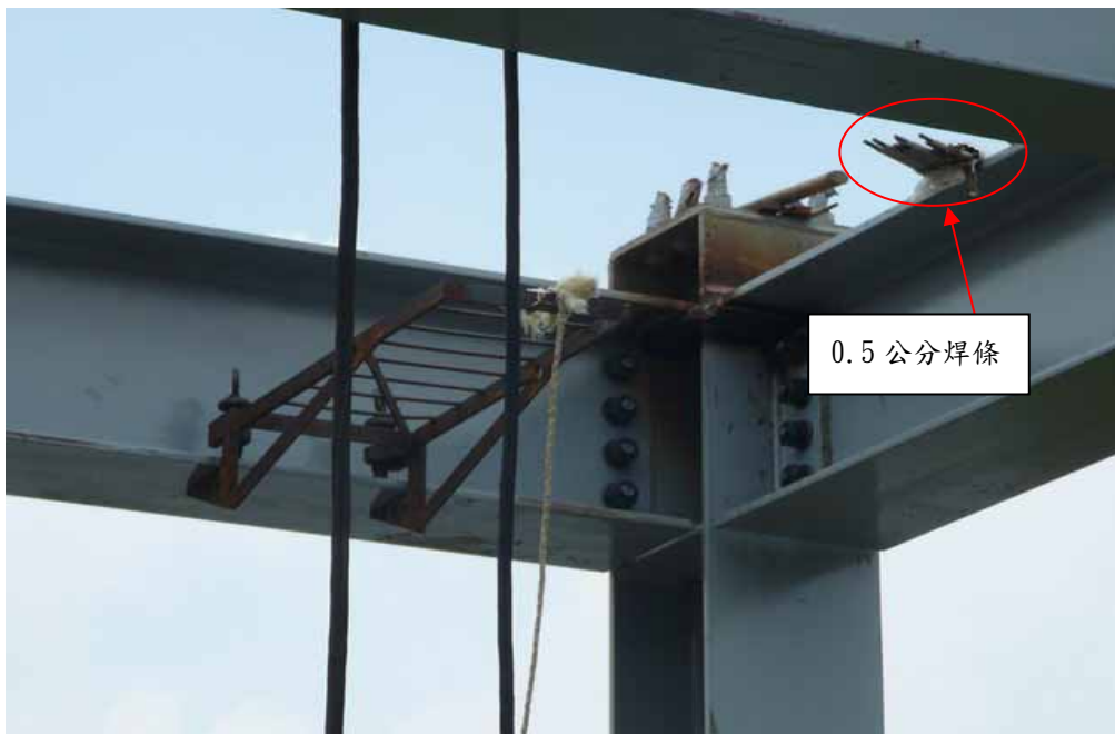
照片 1：災害發生位置
