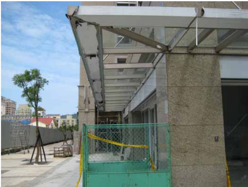
照片 2：災害現場雨庇施作情形
