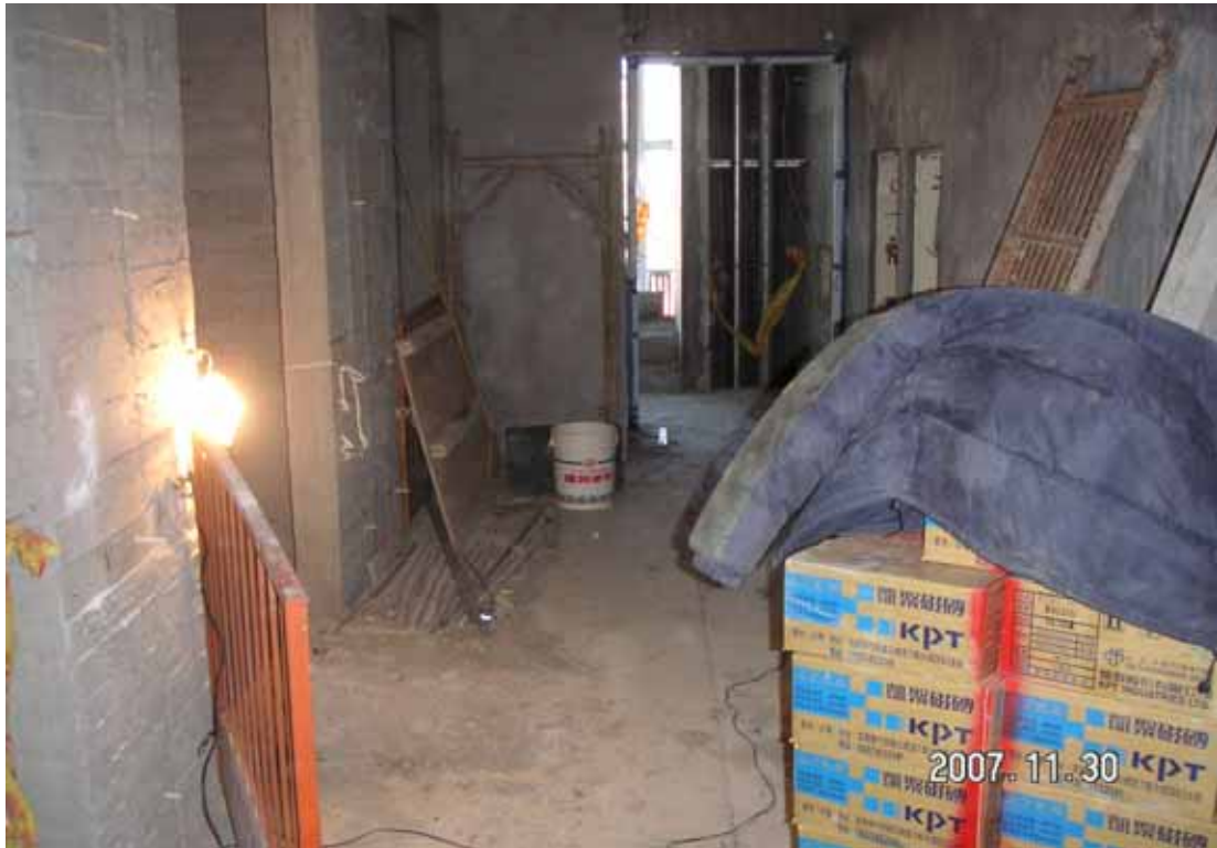
照片 3：事故當時第 18 層時發現左側電梯間之柵門是打開著，該電梯開口左側牆面之安全帶扣環上掛著一只開啟且面向電梯內部照明用之電燈，電梯間並發現有 1 件藍色外套（事後證實是罹災者張慶搖的衣服）、1 條斷裂連結固定於電梯牆面開口之 3 分棉繩、1 個內置模板作業使用之各種手工工具之工具桶及 1 具內置破碎機之箱子，至於第 18 層時右側電梯間之柵門是關閉的
