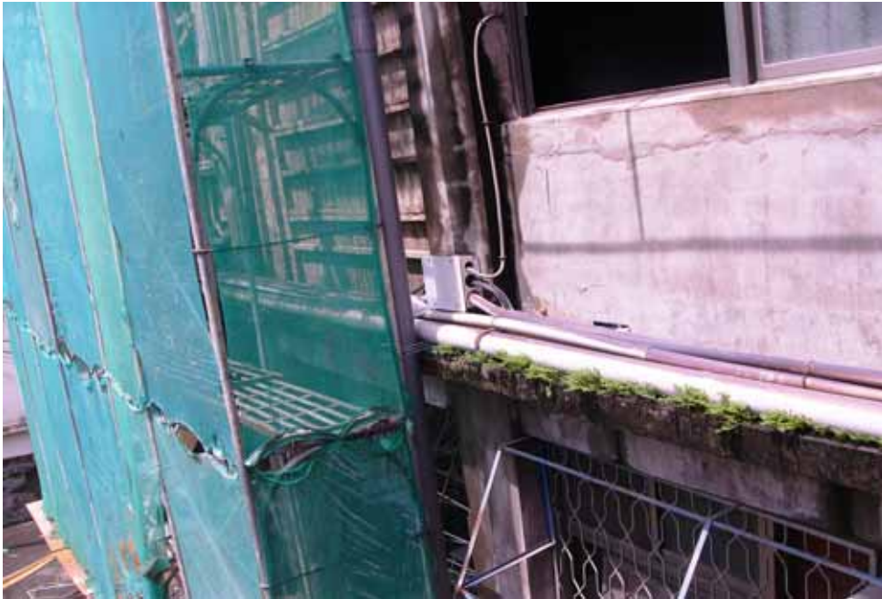
照片 1：罹災者罹災者自牆柱與塑膠管間穿越時墜落
