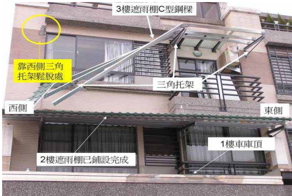
照片 1：災害發生位置
