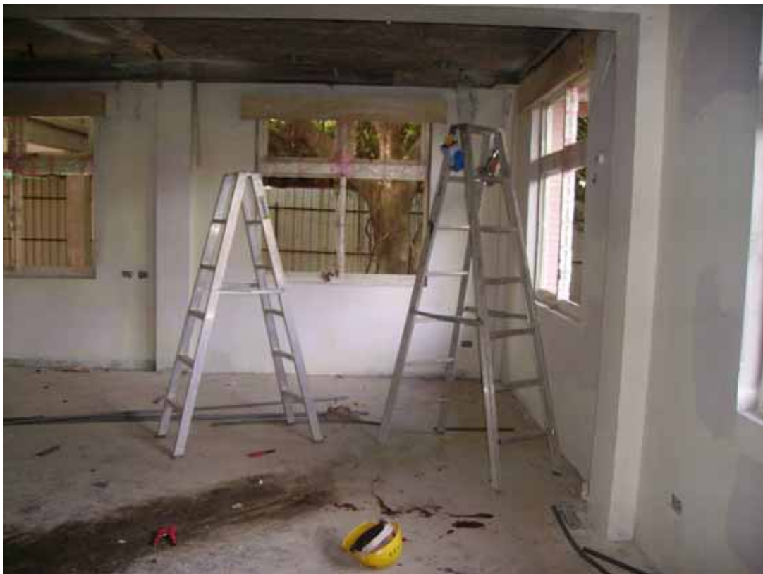
照片 4：災害發生現場全景
