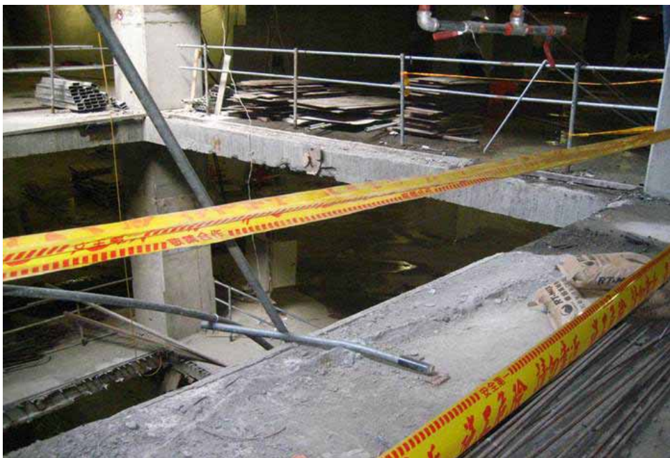
照片 2：現場護欄遭拉扯而斷裂
