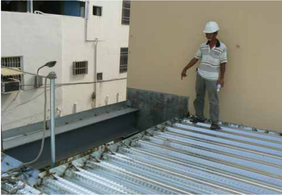
照片 1：罹災者從鋼構樓承板(高約 5.5 公尺) 墜落地面
