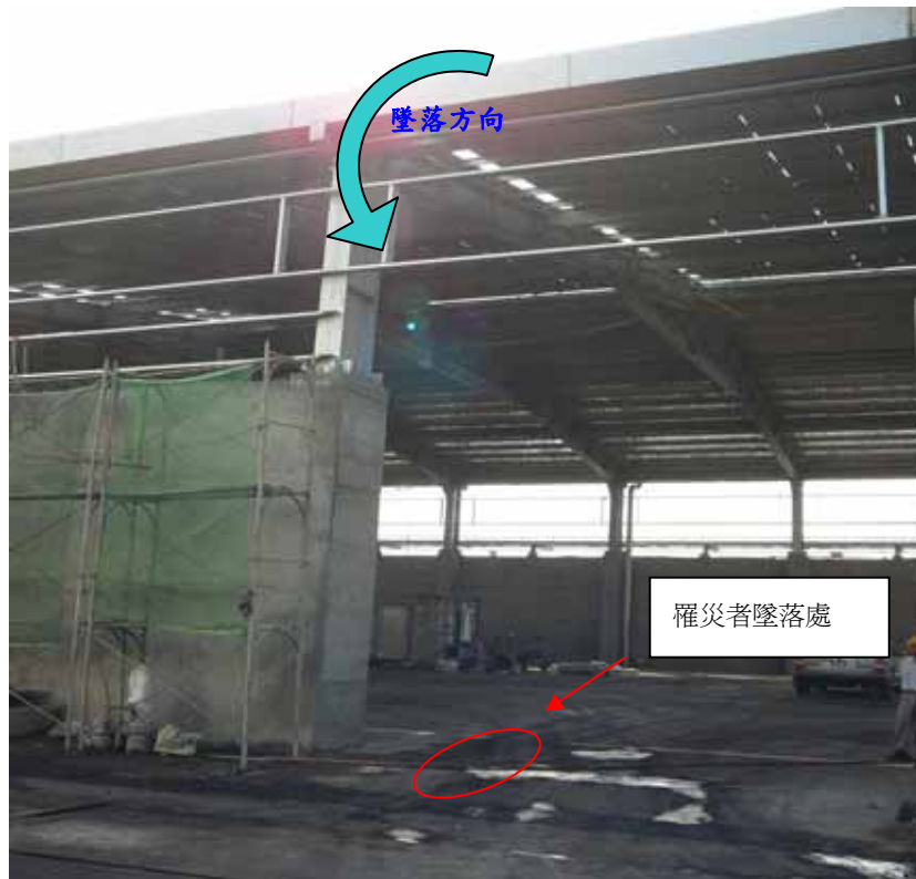
照片 2 罹災者墜落處之近照
