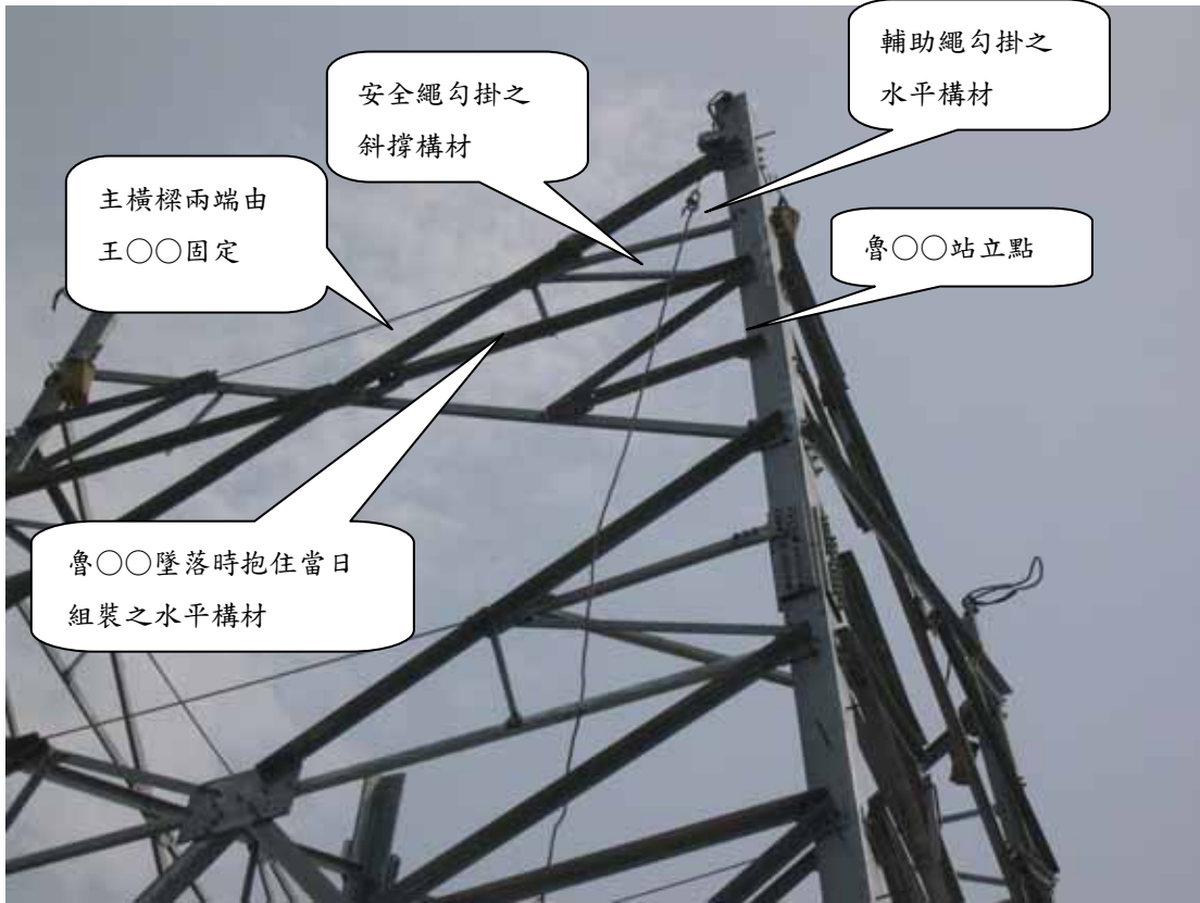
照片 1：災害發生位置
