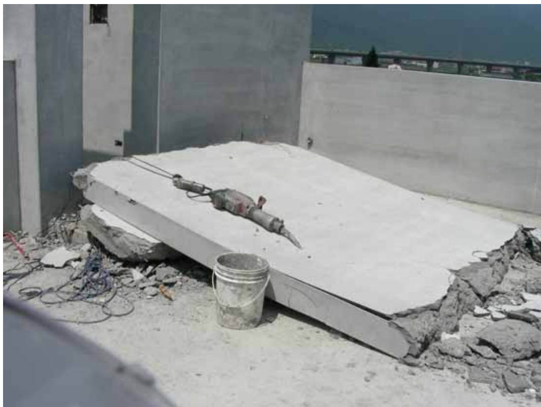
照片 1：混凝土牆作業發生倒塌
