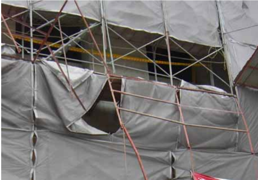
照片 2：罹災者墜落之斜籬破壞情形
