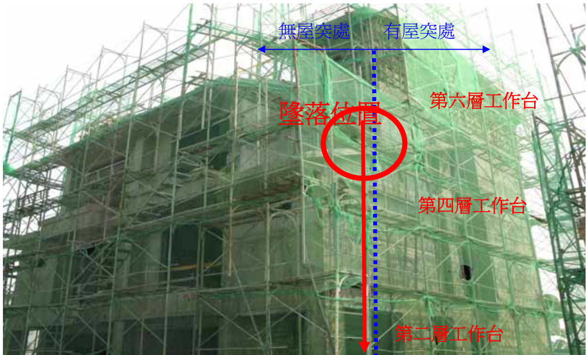
照片 1：災害發生位置
