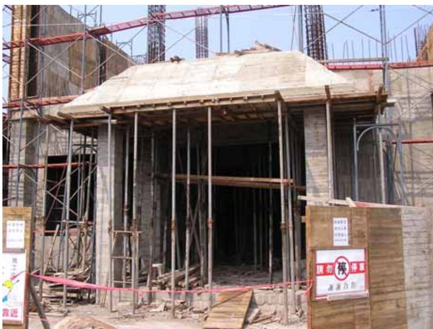
照片 1：災害發生現場
