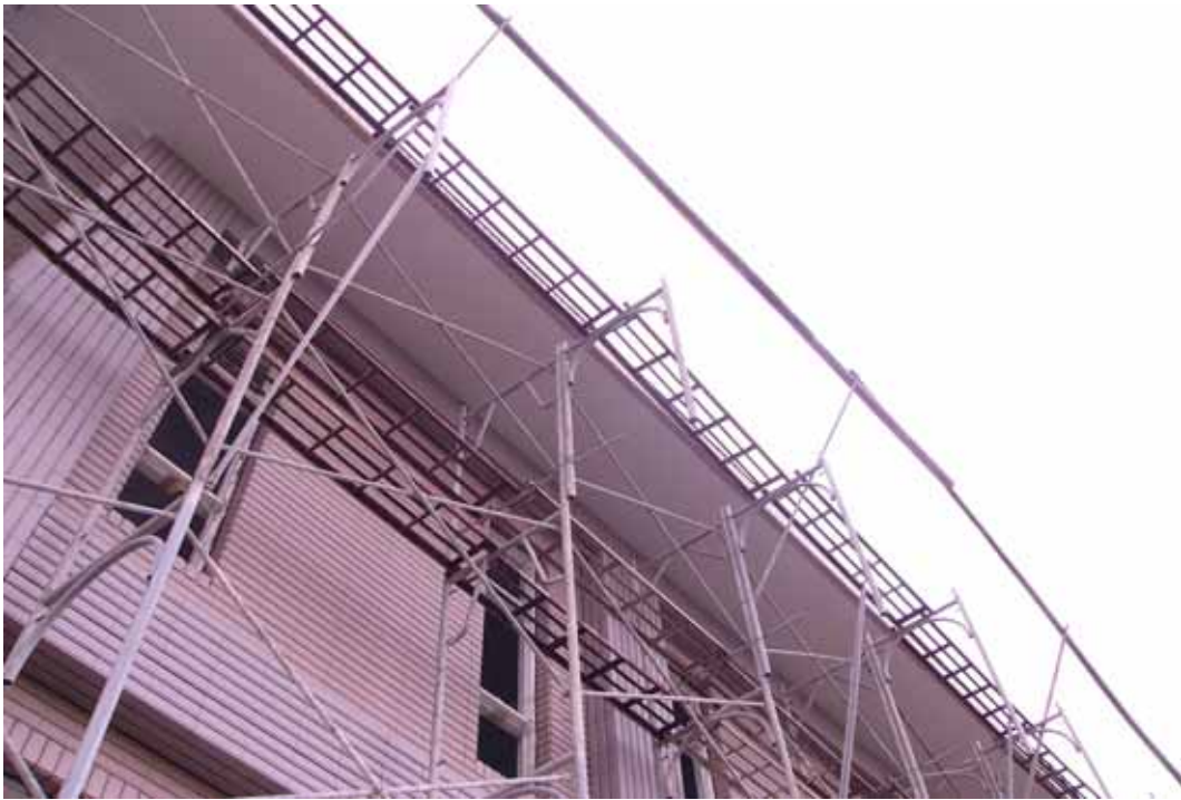
照片 1：東側施工架未設置護欄、安全網或安全母索等防護設備
