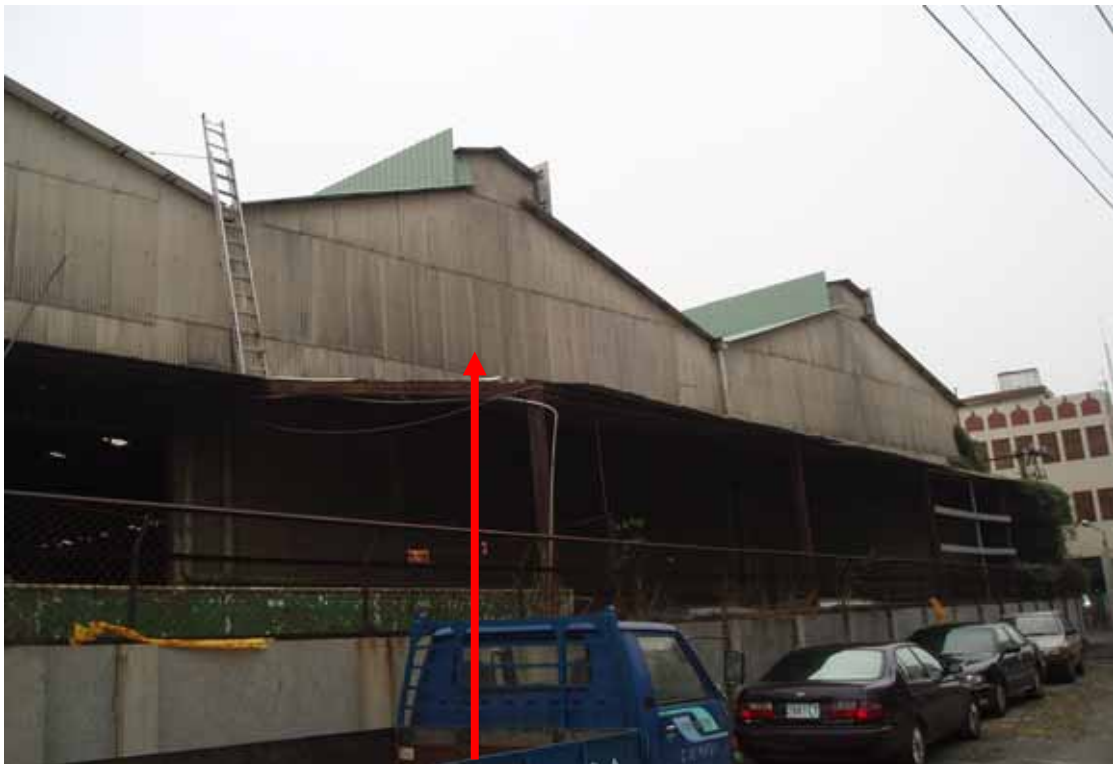
照片 2：一樓屋頂作業場所未設置安全母索，及及鋪設寬度 30 公分以上之踏板
