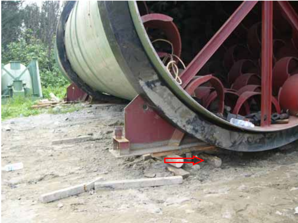
照片 1：乾燥機基礎所墊木材墊料裂開(災害發生後已加強)
