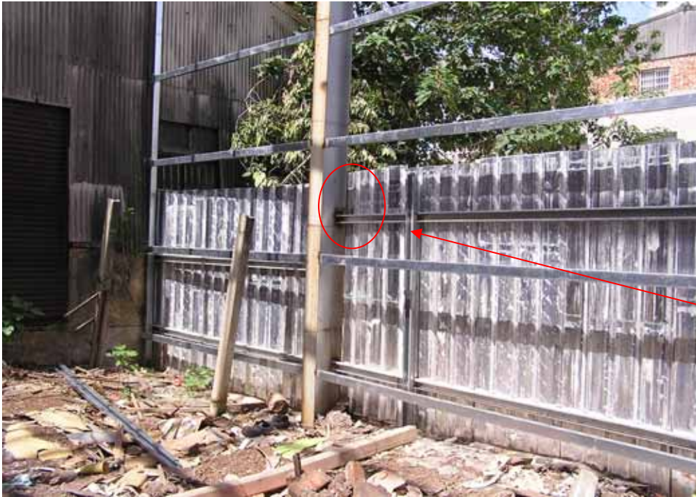
照片 1：災害發生現場位於台南縣永康市○○企業股份有限公司鐵皮屋 改建工程」工區內由南側向北算約 4 公尺及與西側邊交會處
