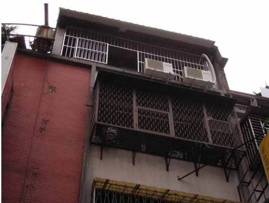
照片 2：罹災者墜落前捲揚機安裝位置
