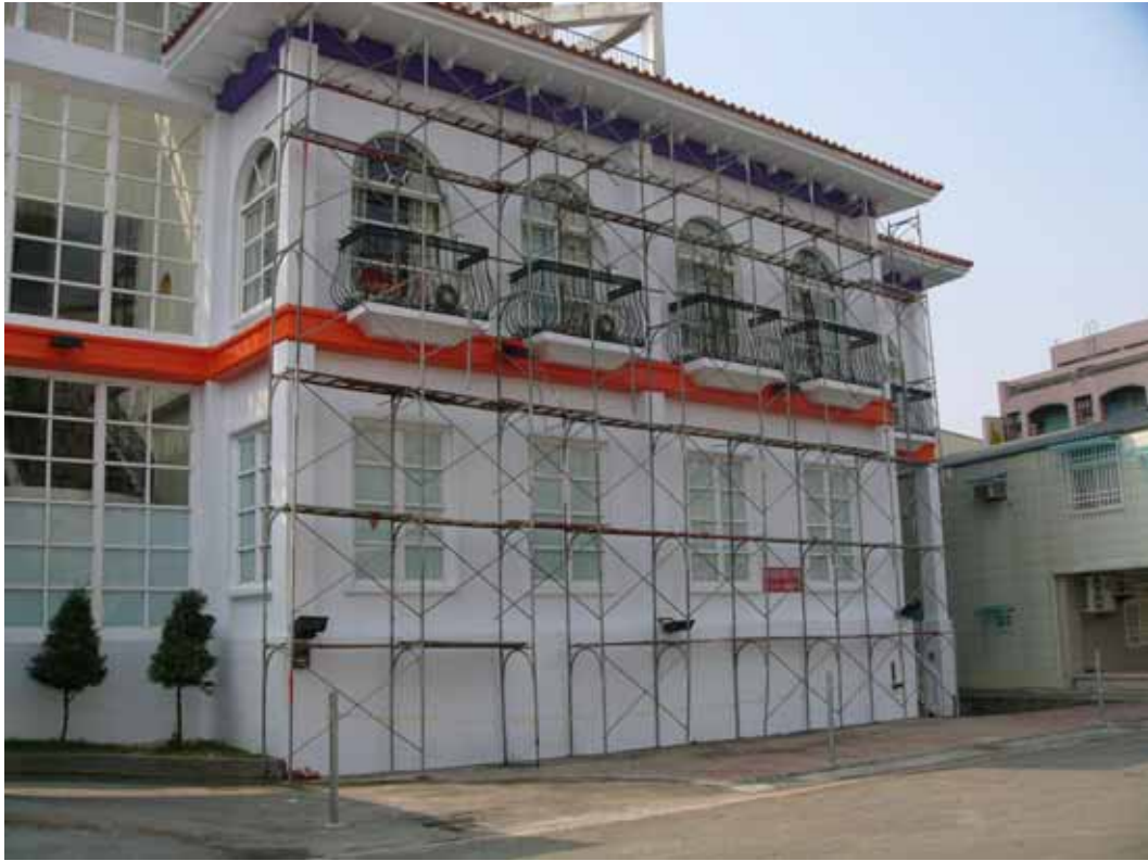
照片 1：災害現場
