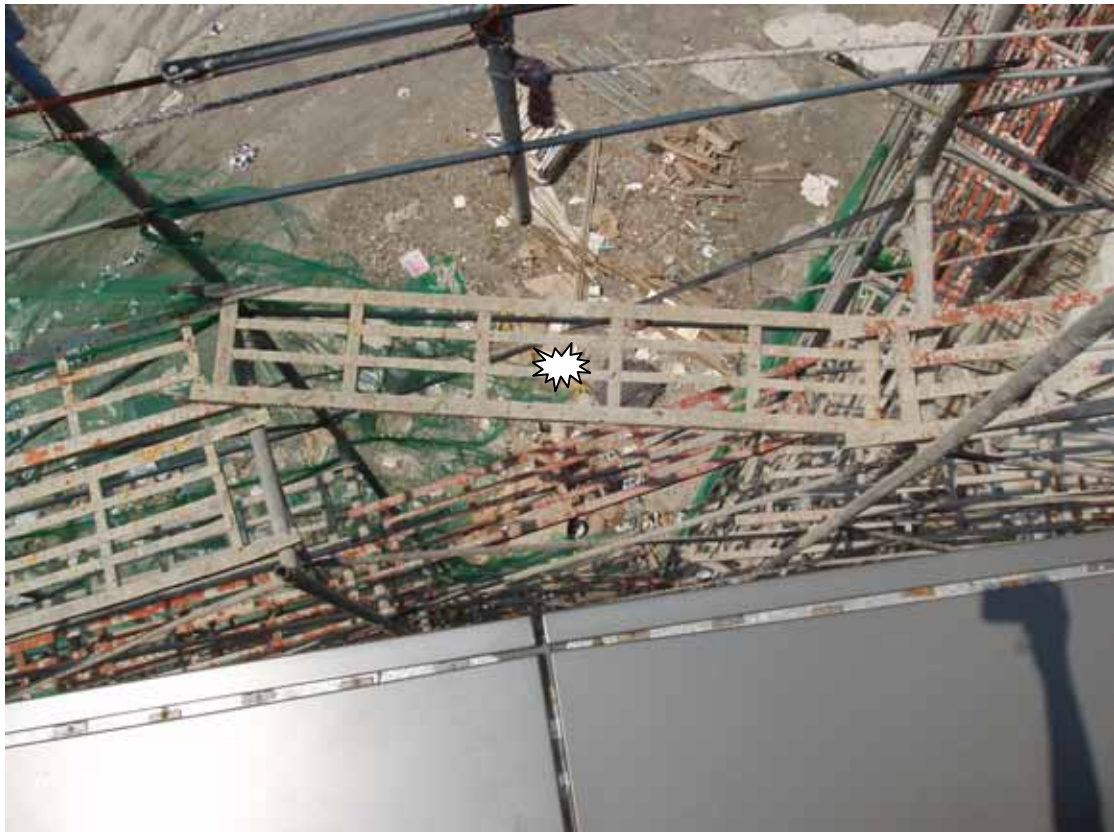
照片 2：四樓外牆施工架近照（白色圖示位置為罹災者墜落起始點，施工架踏板為發生後工地主任與工人共同鋪上）
