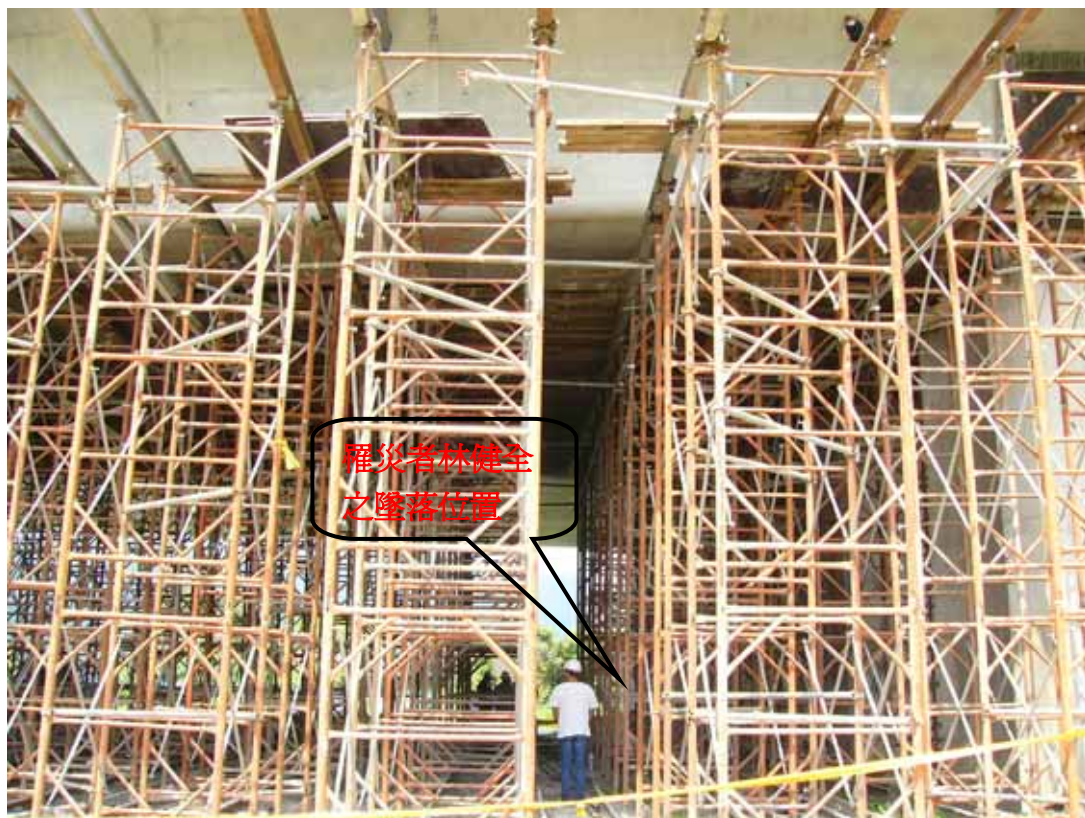
照片 1：罹災者林○○於支撐架上作業時墜落地面之位置
