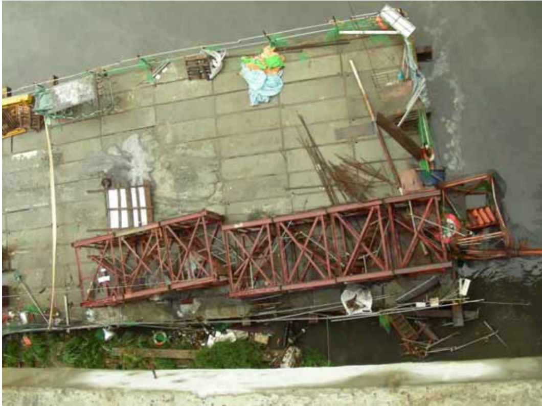
照片 1：本工地 9k+807 (p42 橋墩) 旁之上下樓梯倒塌後情形
