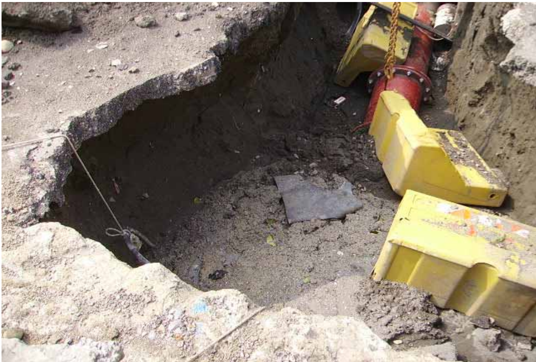
照片1：羅基仁被傾倒之擋土鋼板壓夾於此DIP管上
