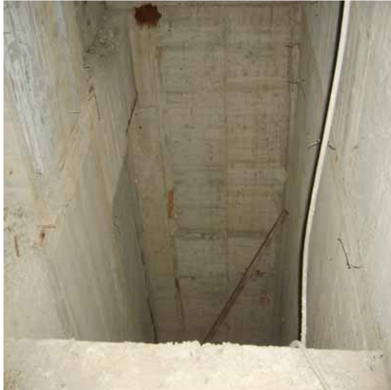
照片 1：墜落開口
