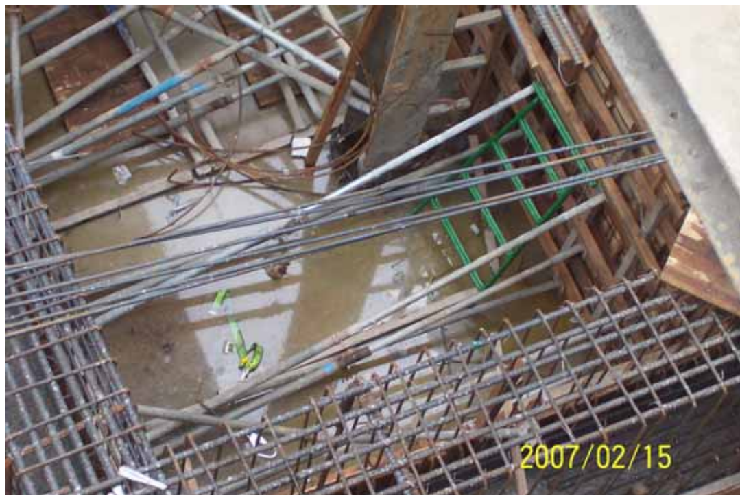
照片 1：罹災者從事鋼筋綁紮作業墜落發生死亡位置
