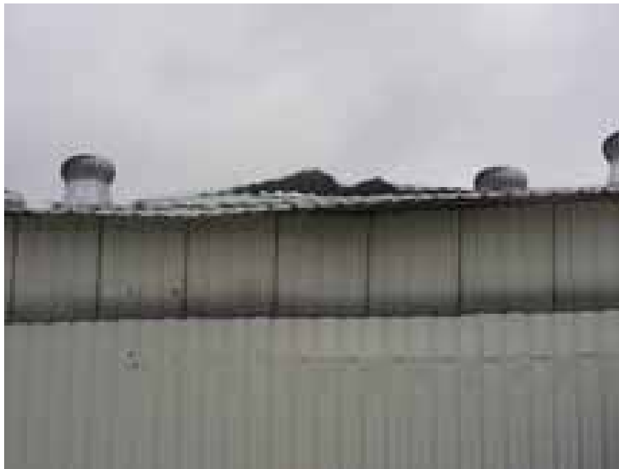
照片 1：災害發生位置
