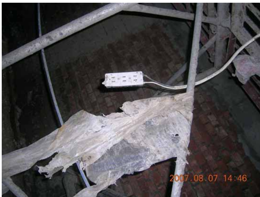
照片 2：罹災者所使用的破碎機以延長線接於臨時配電箱
