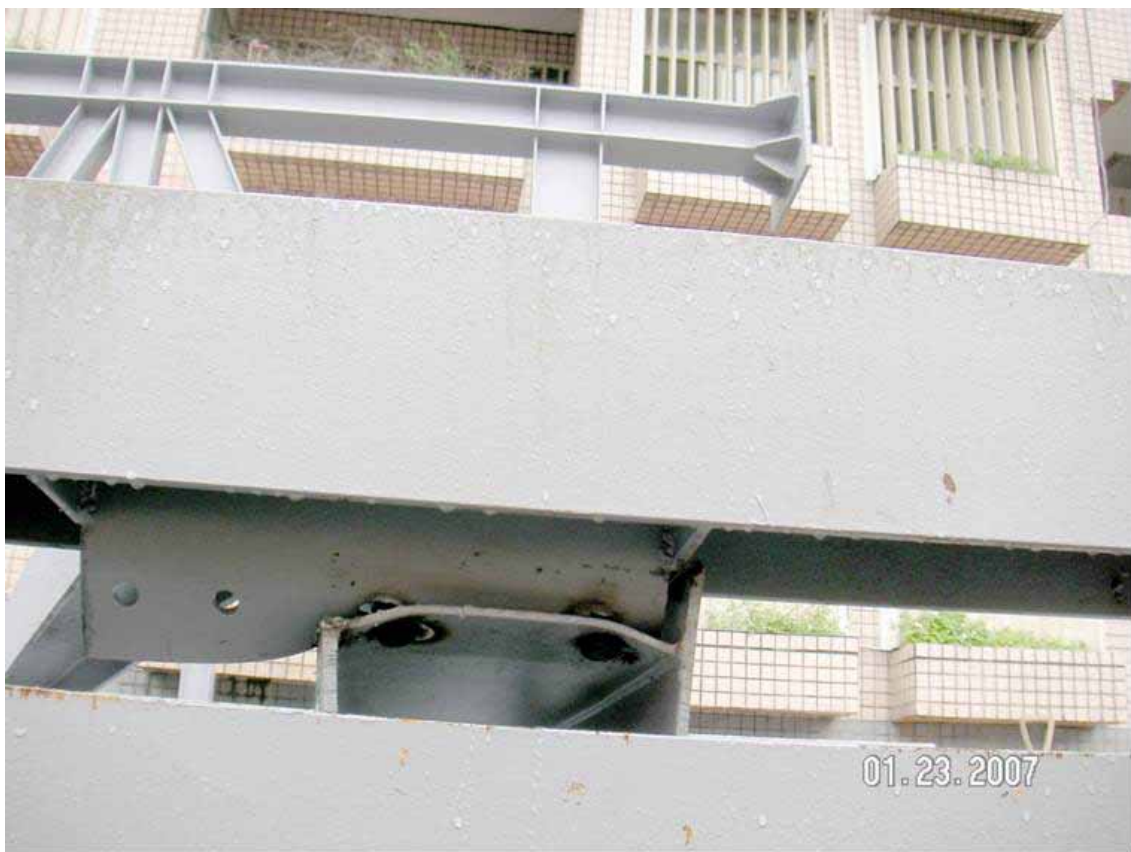
照片 3：第一片鋼架與第一支 H 型鋼間續接板破壞狀況
