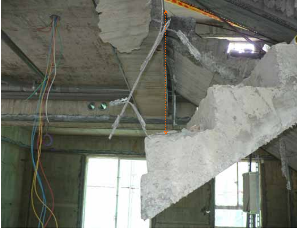
照片 1：三樓通往四樓樓梯脫離三樓
