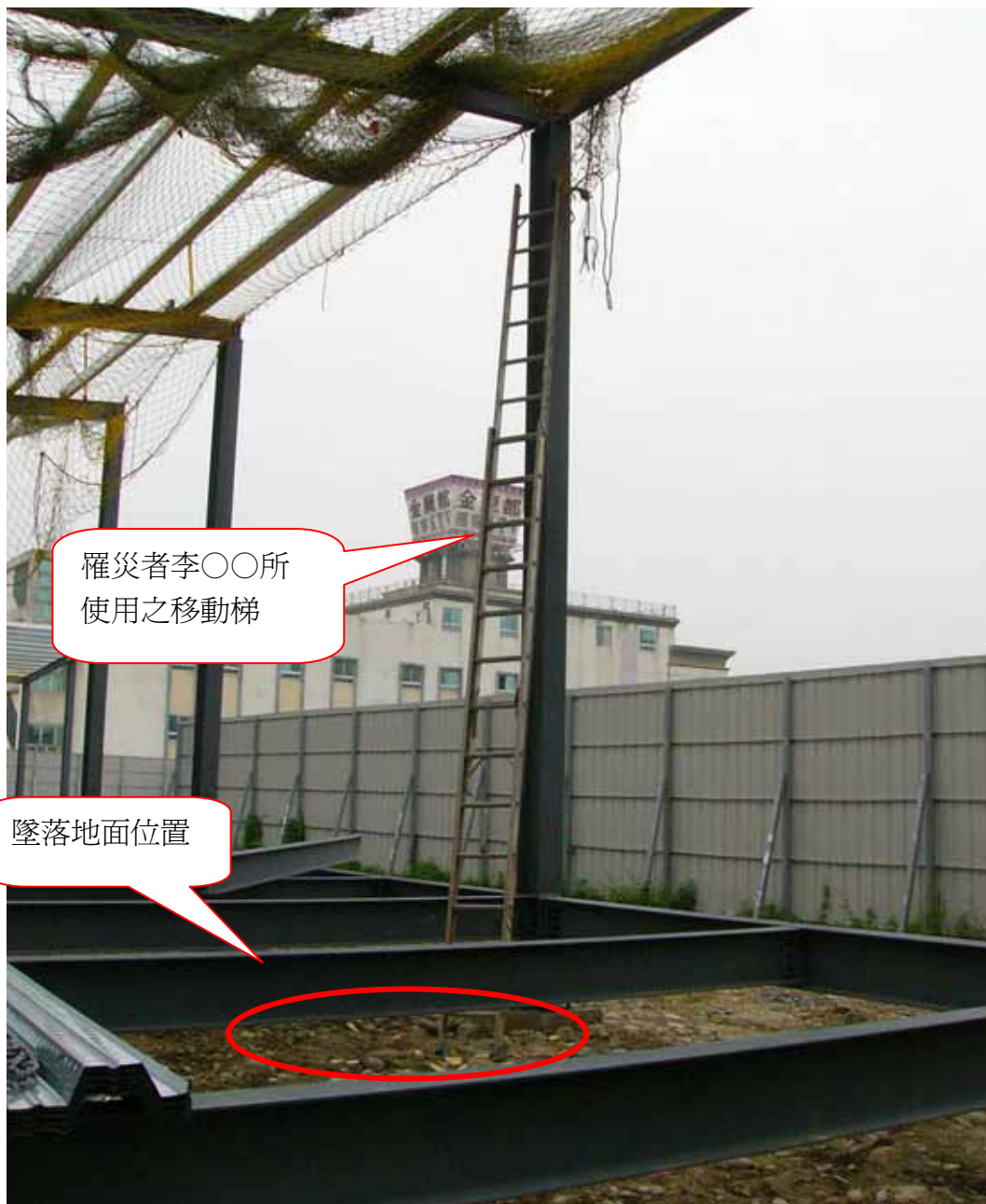
照片 1：災害現場圖示－墜落地點位於「西側棟南邊最後一排中間鋼柱旁」
