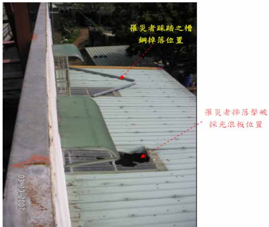
照片 2：罹災者摔落擊破之浪板位置及槽鋼掉落之位置
