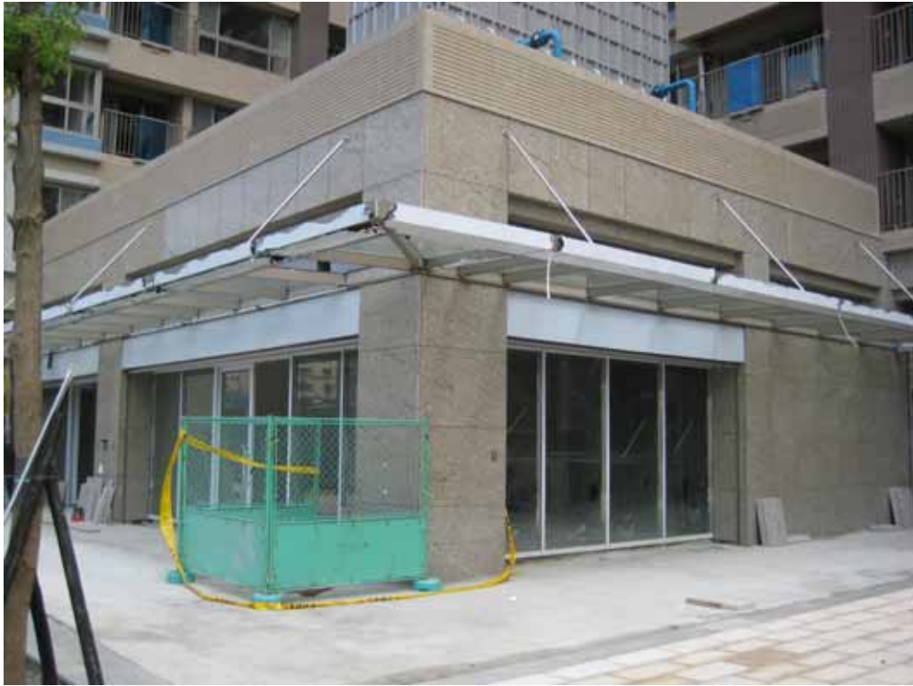
照片 1：災害現場情形
