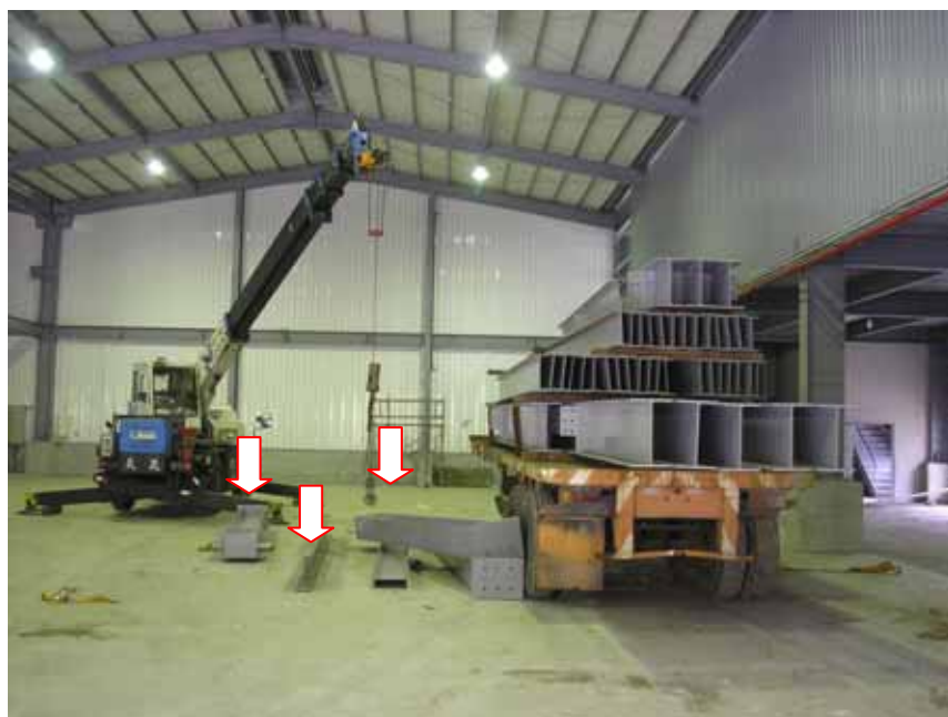
照片 1：罹災者遭鋼骨壓在地面
