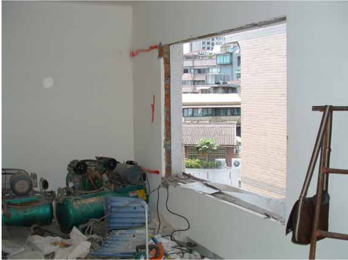
照片 1：職災現場 7 樓室內客廳及窗臺
