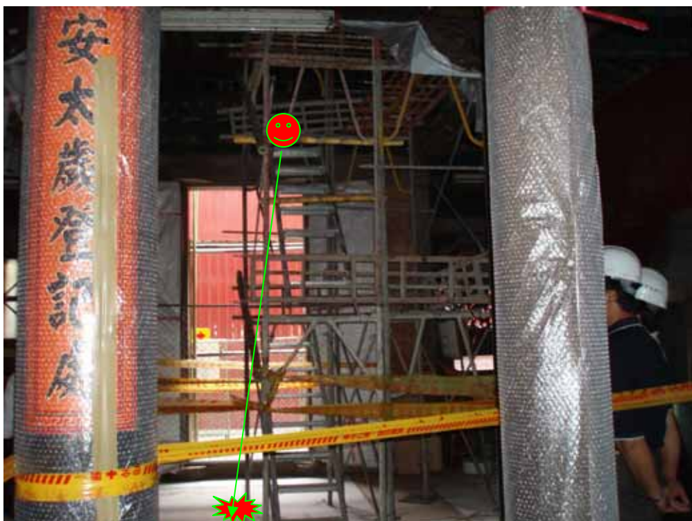
照片 2：災害發生現場位於台南縣北門鄉○○修復工程」龍邊五門處
