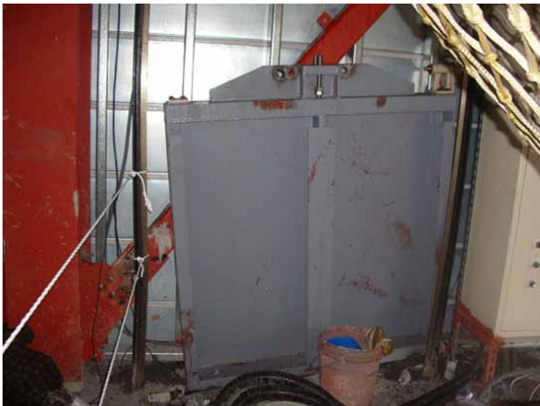
照片 1：停車塔升降機配重盤螺絲斷裂，升降機配重盤因此順著升降機軌道飛落至 1 樓
