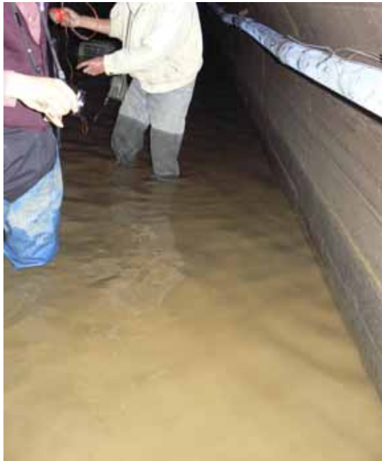
照片 1,2：隧道(引水道)內約 0K+135 公尺之地面有積水，水深度 42 公分
