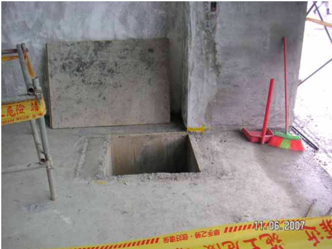
照片 1：墜落之地面開口及模擬罹災時現場之狀況
