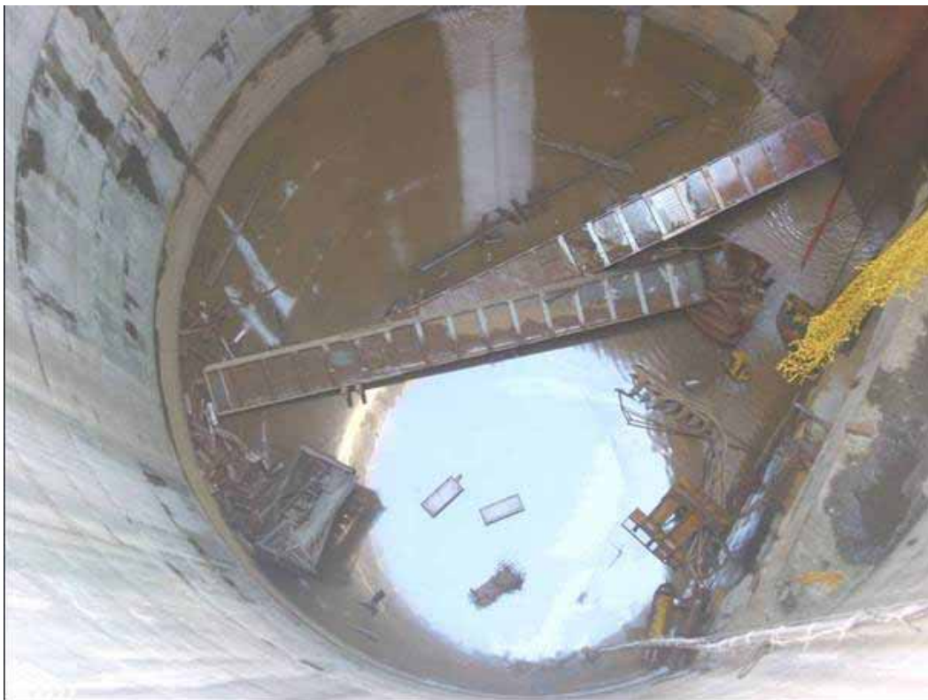
照片 5：事發後部份支撐用型鋼、軌道鋼樑已隨挖土機掉落至井底
