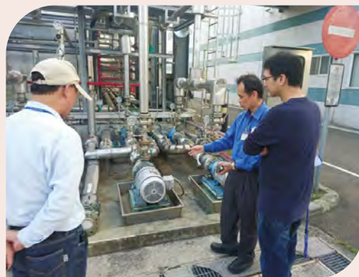
專家至事業單位實施防爆電氣設備輔導
