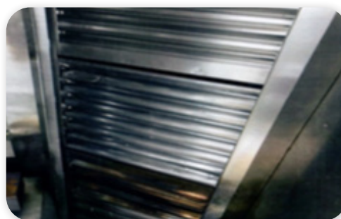
抽風機 (抽風設備)
