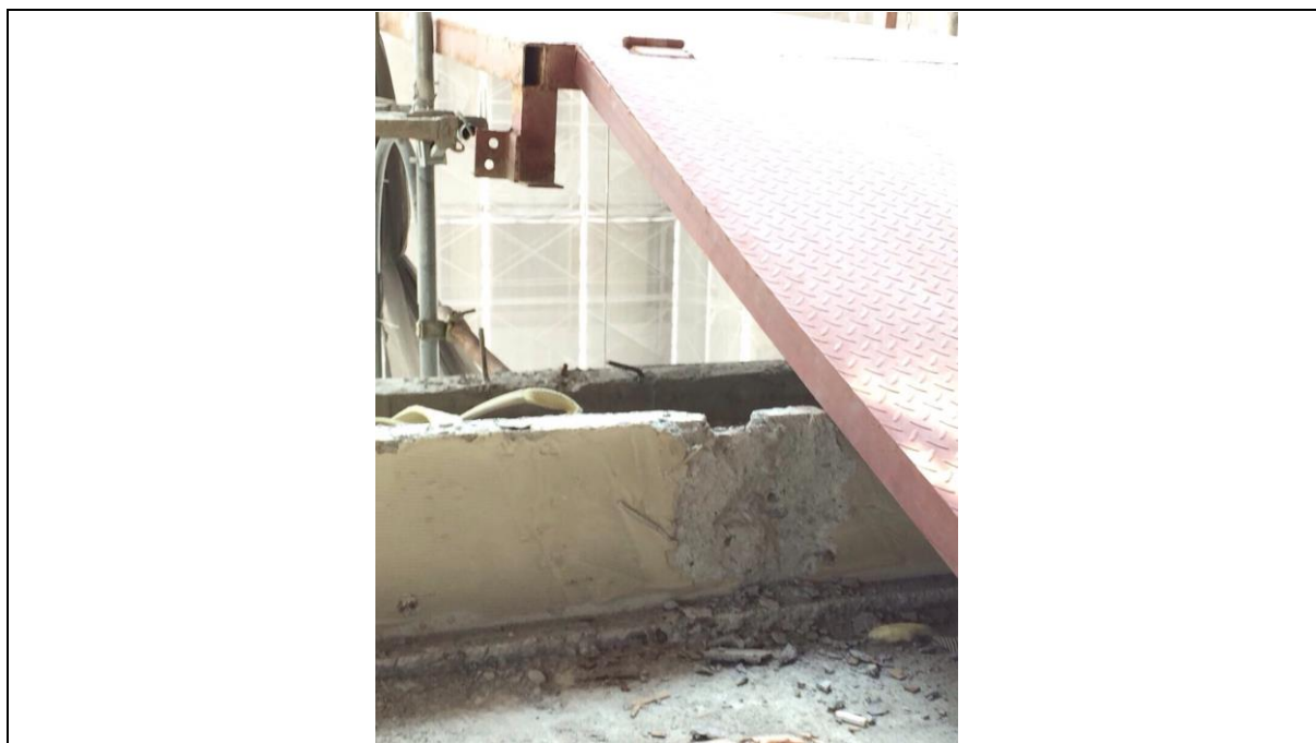
說明 照片二：災害發生當時照片，可見臨時吊料平台固定於窗台基座處已懸空傾斜。
