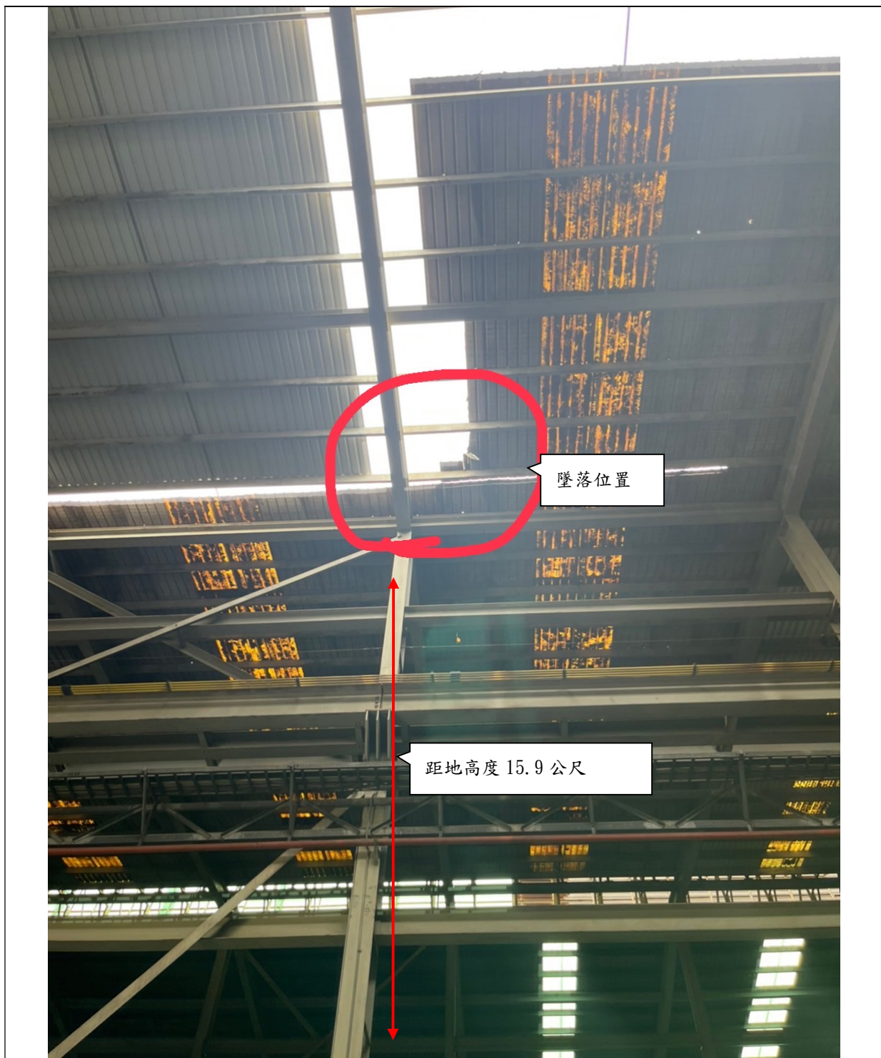
照片 1: 勞工田○○於屏南廠第 8 棟廠房屋頂從事鋼浪板更換作業後，收拾工具準備下班時，不慎踏穿舊有 FRP 材質屋頂浪板，從高度約 15.9 公尺之屋頂墜落至地面，傷重不治。
