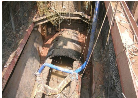
照片 2-3 災害發生時正進行推管作業
