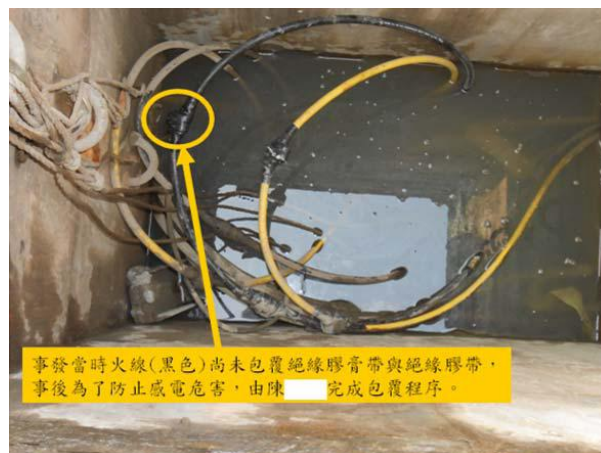
照片 2-8 發生災害之手孔
