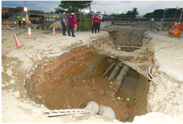
照片 2-10 地下管道改線工程崩塌現場情形
