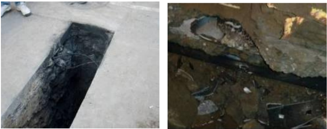
照片 2-5 發生災害之開挖面及鑽破台電高壓線路情形
