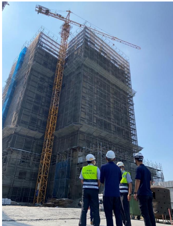
職安署南區職業安全衛生中心林培司副主任率檢查員前往臺南市某建築工地實施勞動檢查。
