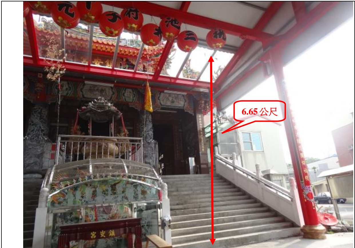
說明 照片三：○○宮前方遮雨棚上方有一排玻璃製之採光罩，距地面高度約 6.65 公尺，李罹災者先墜落於階梯上再滾落至地面。
