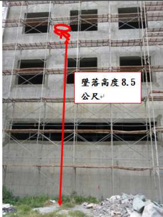
說明 照片二：罹災者潘 00 墜落高度為 8.5 公尺
