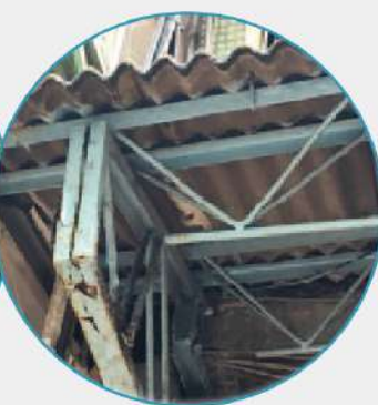
圖：含石綿的屋頂建材
