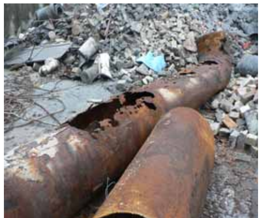
廢氣排氣管外表已嚴重銹蝕
