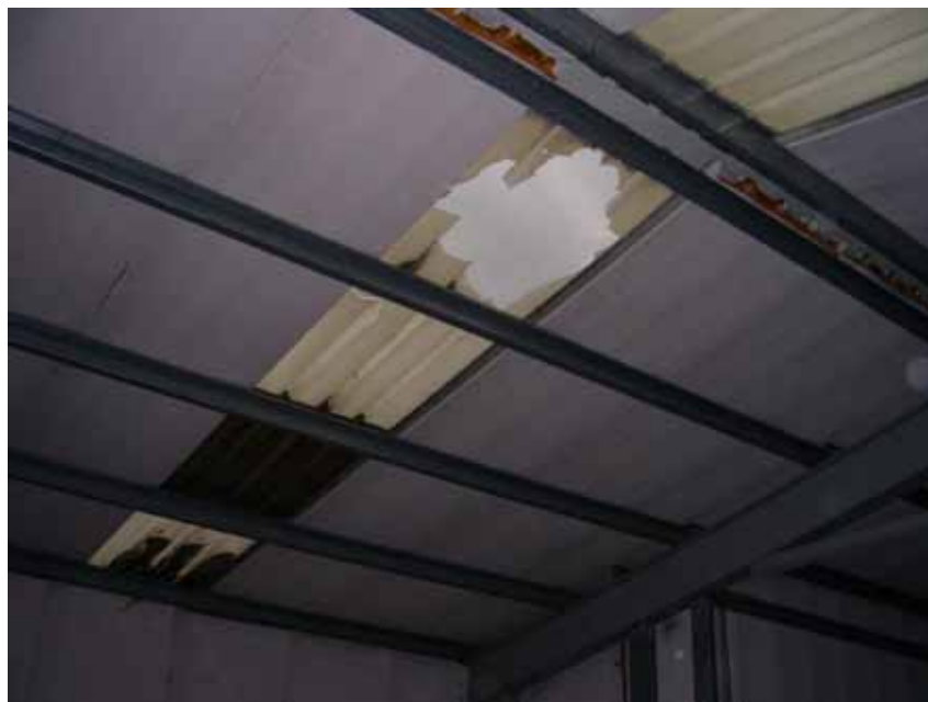
照片 3：自室內觀看屋頂採光罩破裂情形(無安全網)
