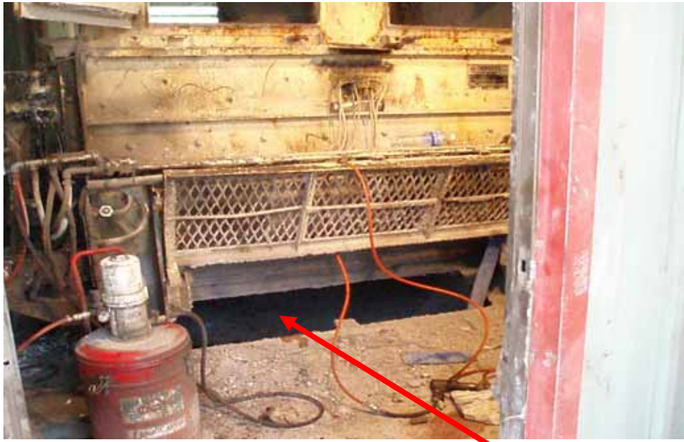
照片 3：發生災害水泥拌合機之集料斗，集料斗為錐形中空，於進入清除時，係以木板鋪成踏板，經量所鋪踏板至卸料閘門高度約 90 公分，研判罹災者係蹲於踏板上從事清除混凝土塊
