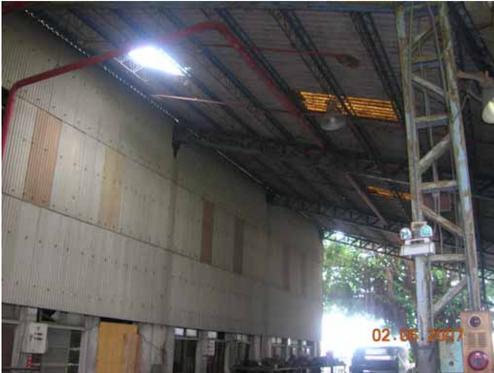
照片 1：罹災者從三夏企業股份有限公司工務課屋頂離地高度 7.2 公尺之石綿浪板踏空墜落，造成 90 公分*75 公分破裂面積
