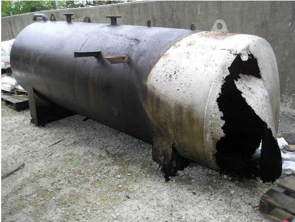
照片 1：爆炸之熱煤油儲存槽
