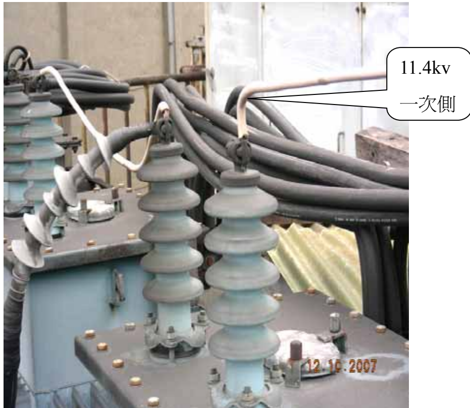
照片 2：高壓變壓器照片
