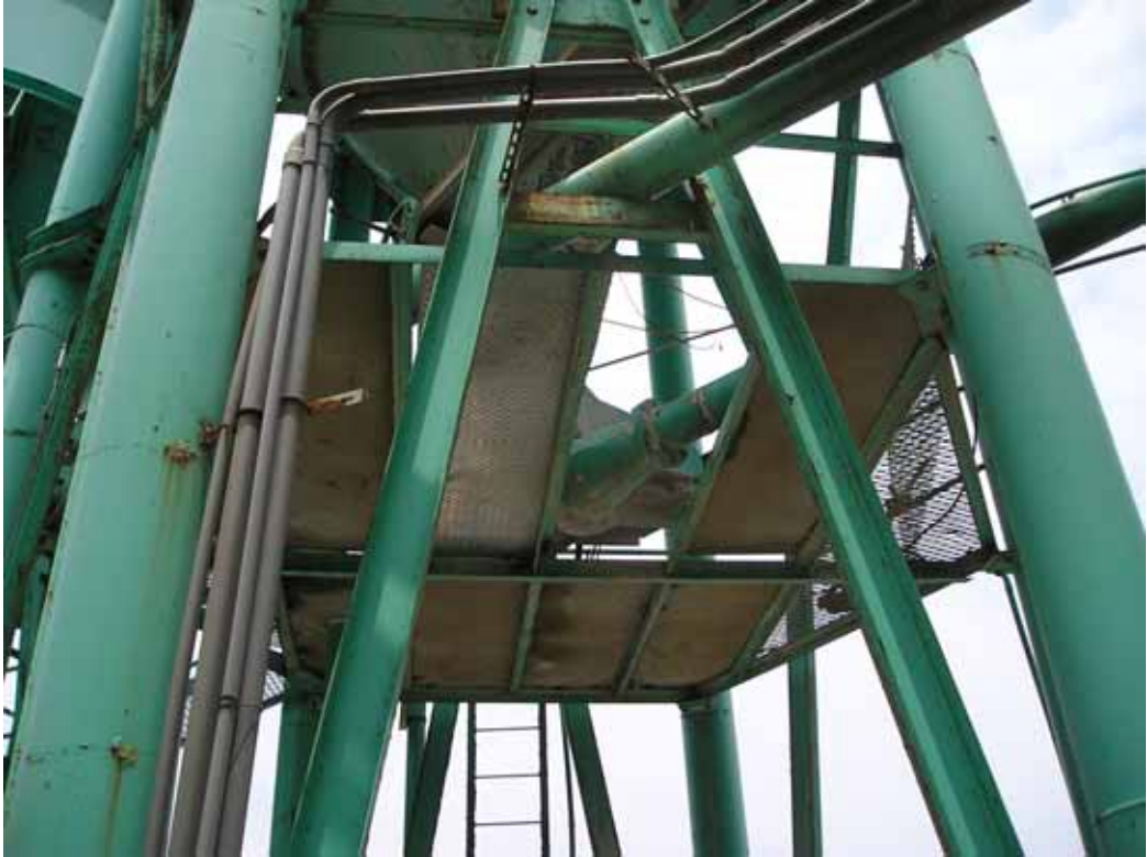
照片 1：肇災處位於爐石槽工作平台
