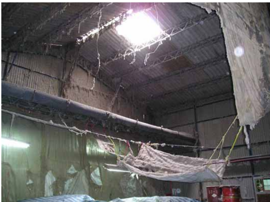
照片 2：罹災者所踏穿之石棉瓦屋頂
