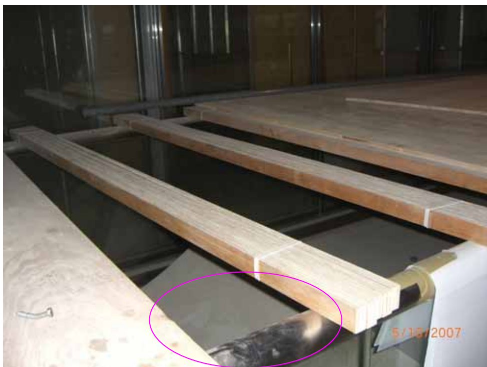
照片 2：2 樓事故現場
