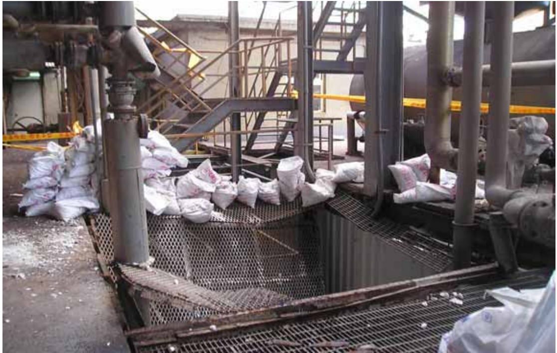
照片 1：垮落的 3 樓作業平台
