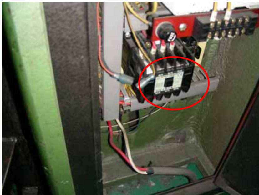
照片 2：機台門之安全連鎖裝置切斷情形
