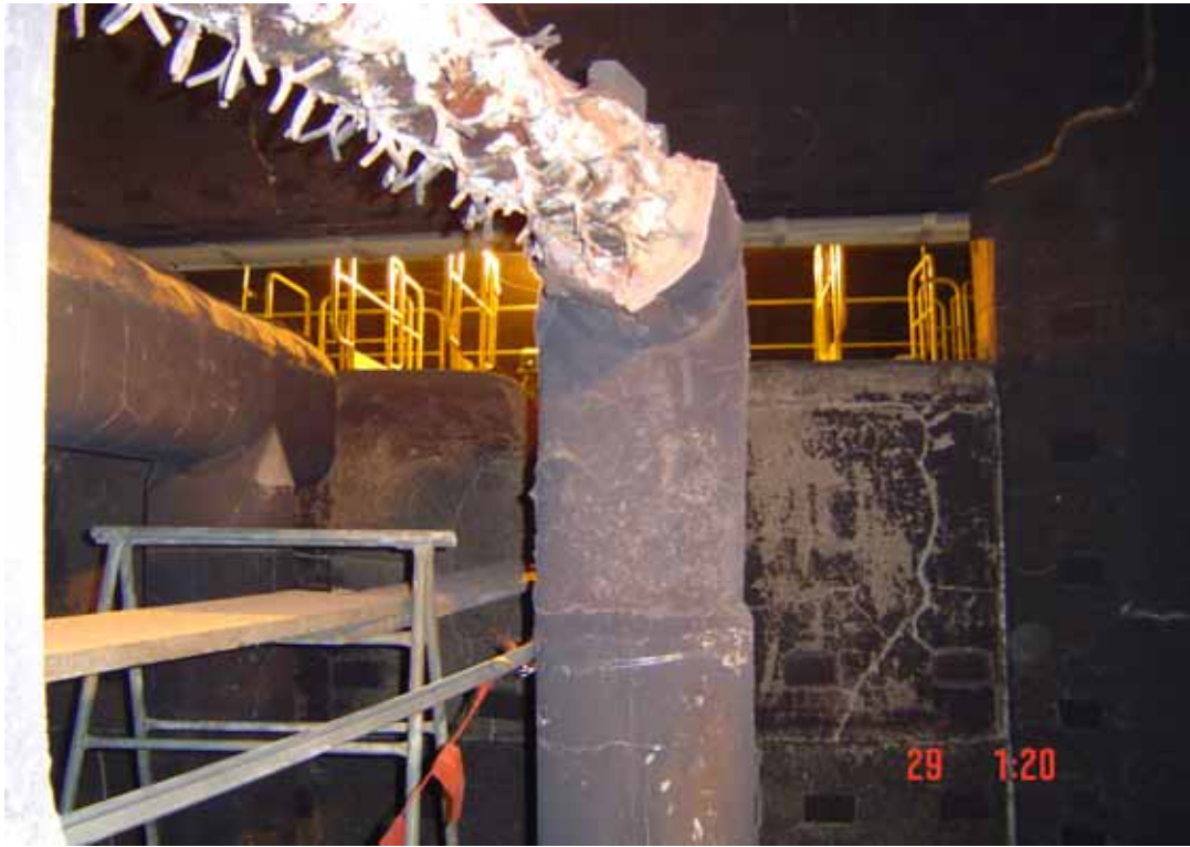
照片 3：欄杆間隙過大（寬 140 公分x高 70 公分），勞工可輕易穿越欄杆，未達防止進入之效果
