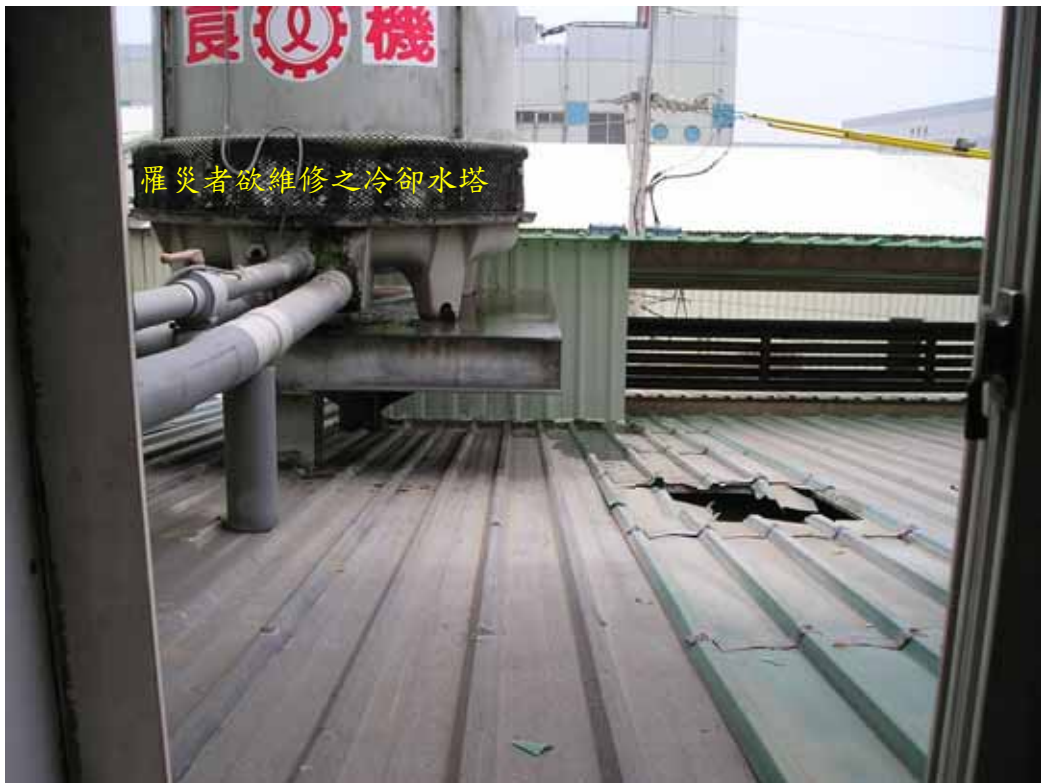
照片 2：肇災位置與維修冷卻水塔之關係
