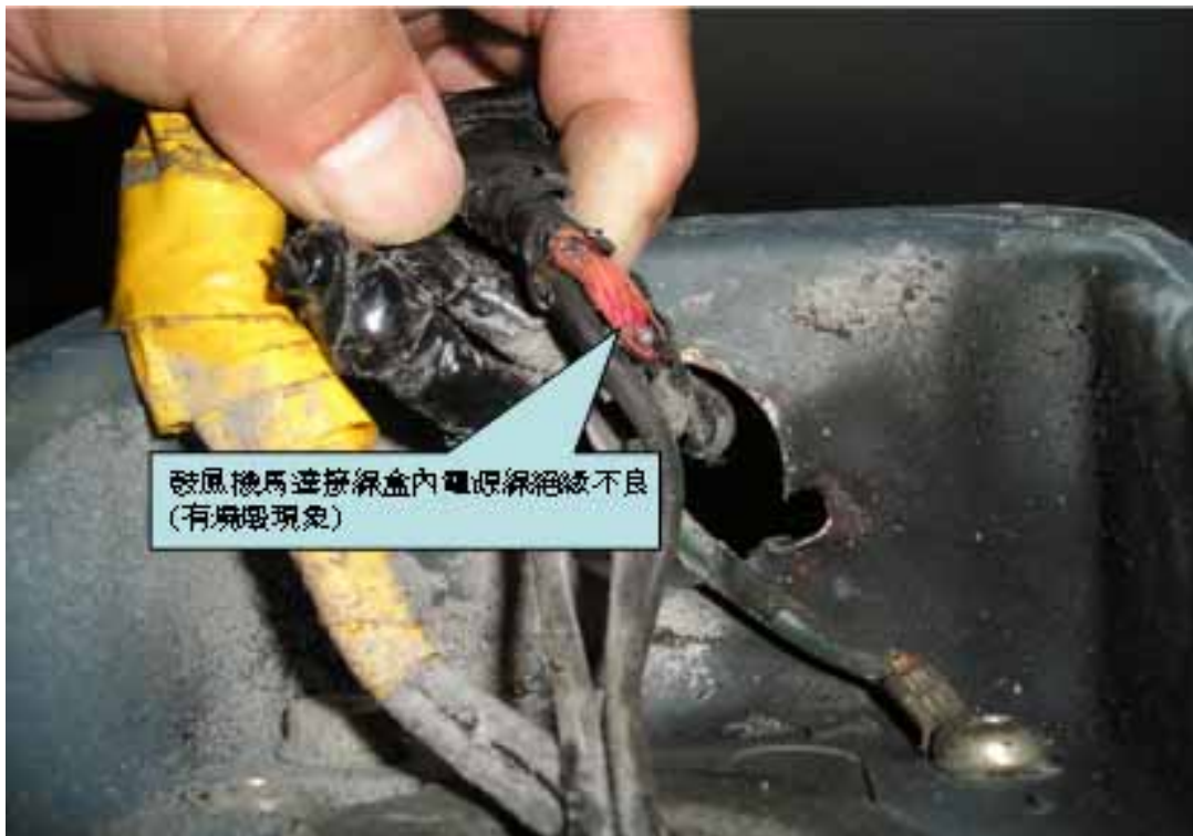
照片 2：電源線燒毀情形
