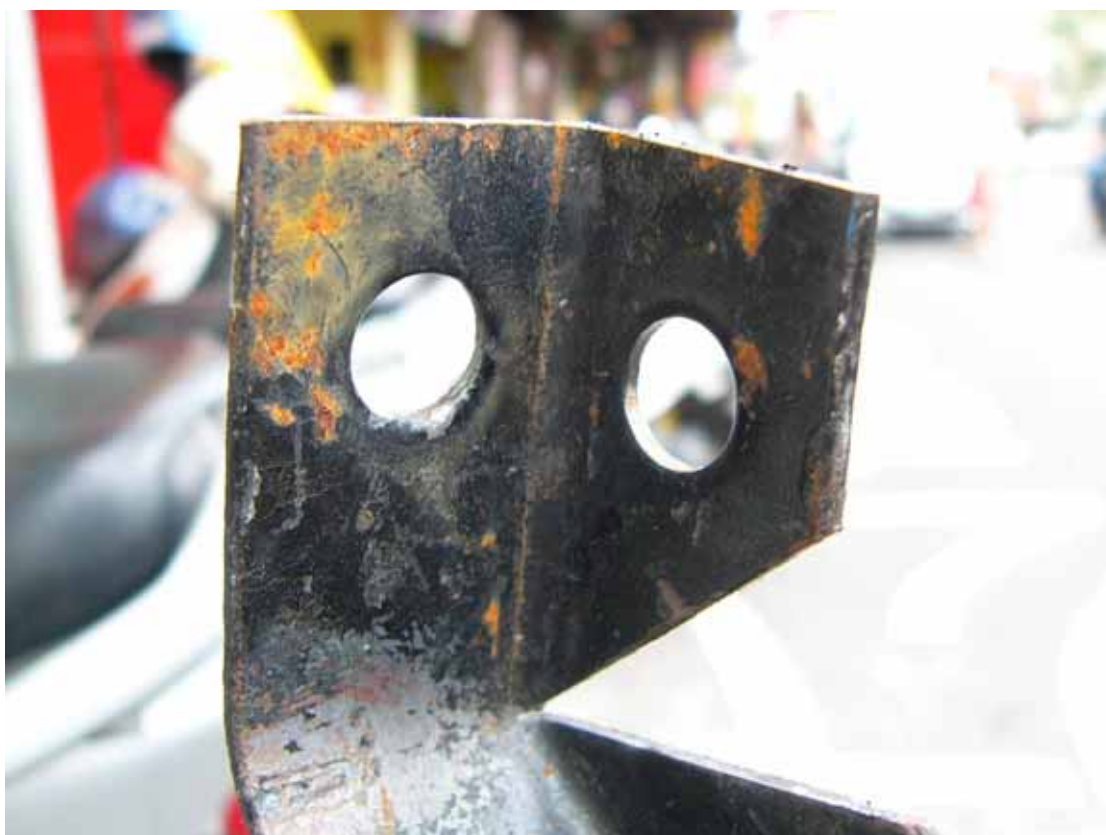
照片 3：脫落之右側投射燈支撐用鐵架錨釘孔刮痕
