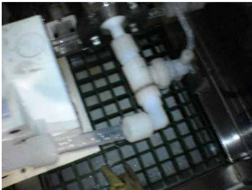
照片 2：泵浦出口端管線之 90 度彎管接頭由令破裂
