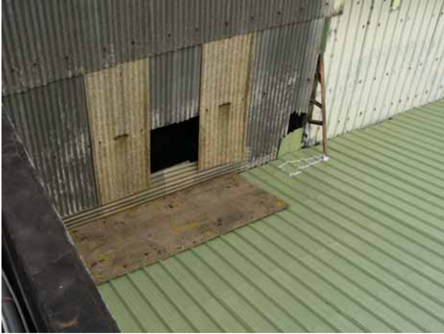
照片 1：勞工重心不穩由壓破牆面墜落死亡
