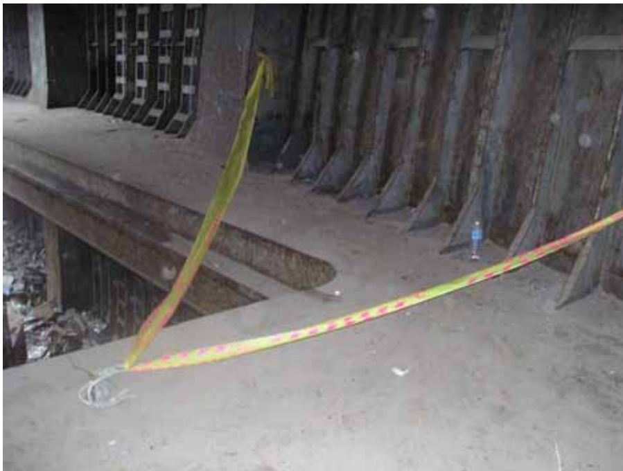
照片 1：災害地點位於台中港第 24 號碼頭恆○輪第 1 艙內罹災者墜落之 2 層艙甲板開口處
