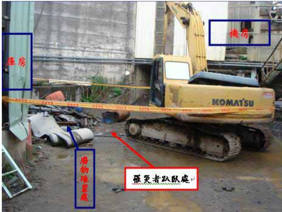
照片 1：罹災者遭挖土機撞擊輾壓致死， 趴臥於機房前空地廢棄物堆置處旁
