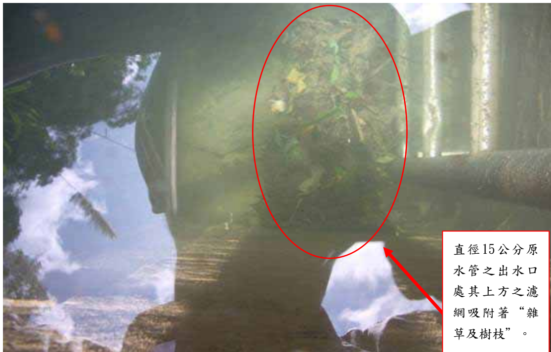
照片 3：事故當日罹災者疑似要清除堵塞住直徑 15 公分原水管之出水口處其上方之濾網吸附著“雜草及樹枝”
