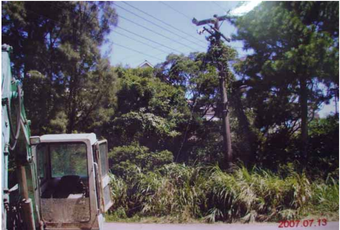
照片 3：掉落電纜電桿之前後兩端電桿（#1）（於挖土機附近）
