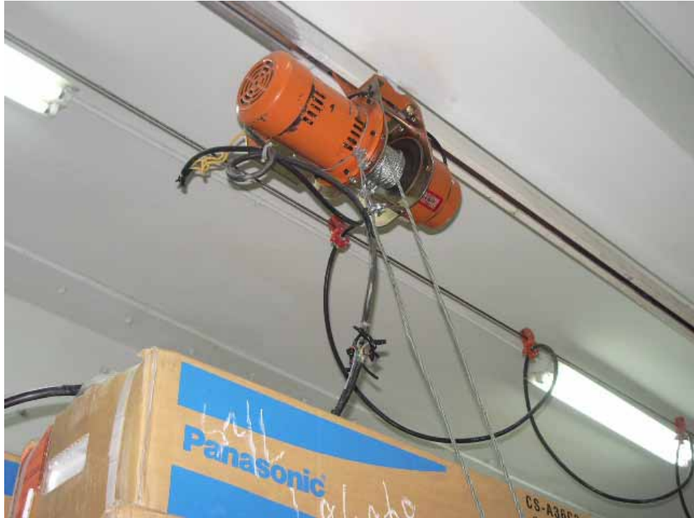
照片 1：捲揚機電源線似有接續跡象
