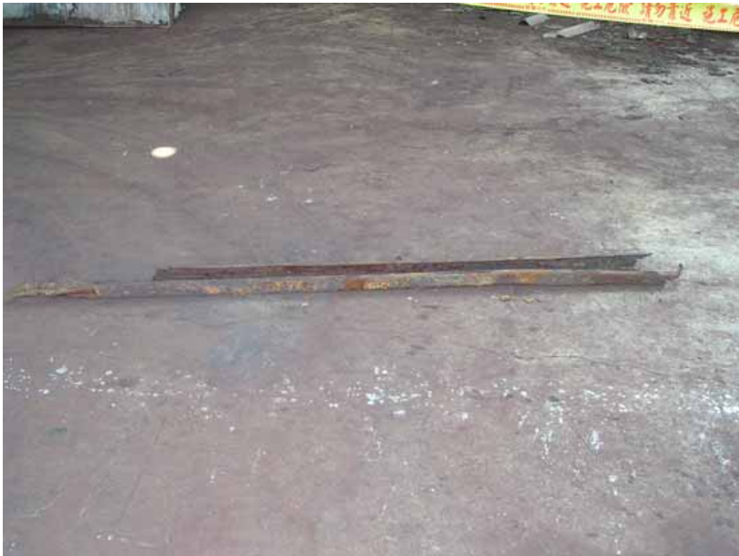
照片 2 現場掉落之石綿瓦支撐 C 型鋼外觀
