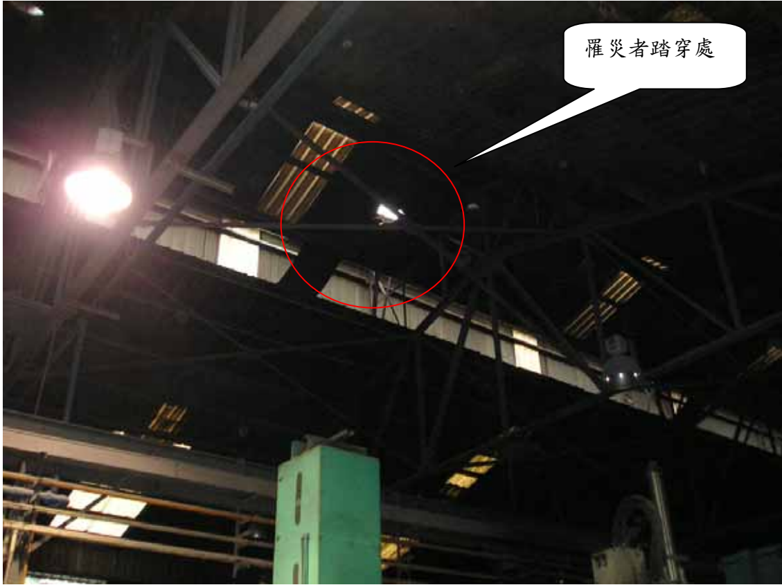
照片 1：災害現場－廠內機加區廠房屋頂
