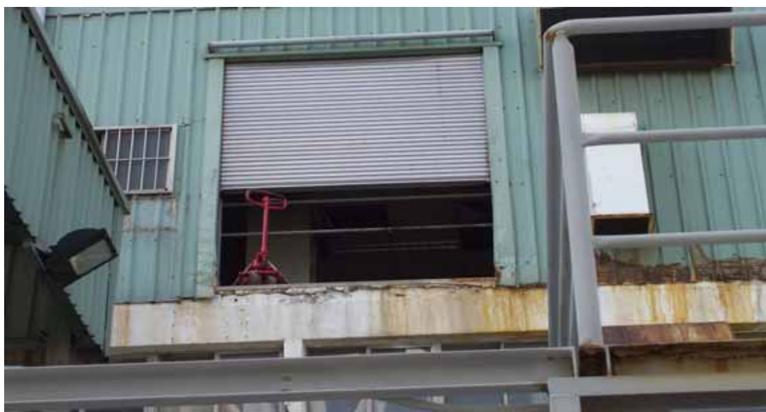
照片 1：罹災勞工於 3 樓機設吊裝口邊緣處墜落
