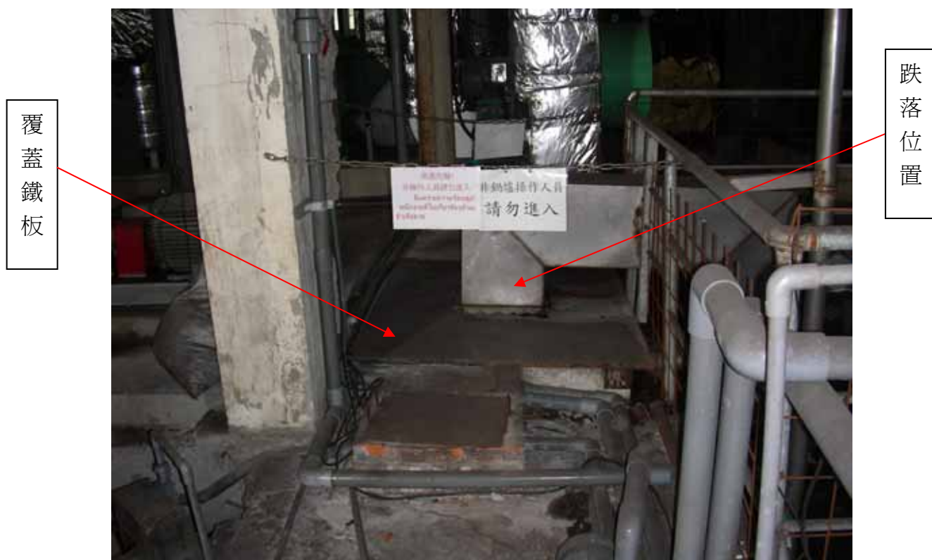
照片 1：外勞跌落位置
