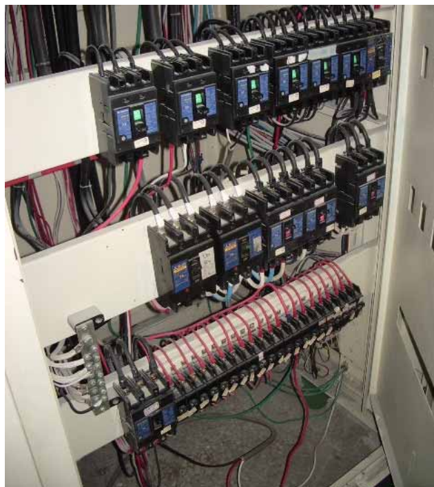
照片 2：捲揚機電源係由位於不同區域內之電源控制箱總開關 2
