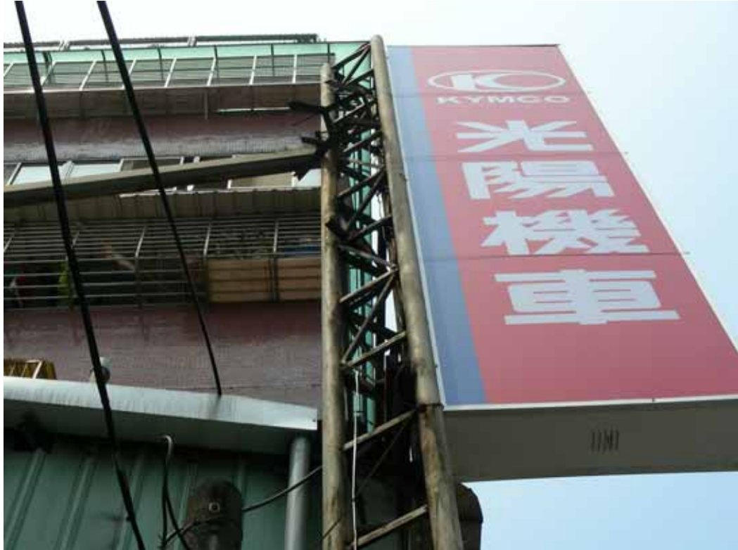
照片 1：罹災者攀登廣告桁架發生墜落職災
