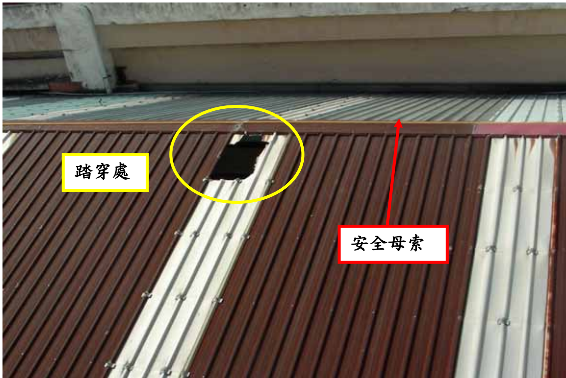
照片 3：菲勞踏穿採光塑膠浪板墜落現場(三)
