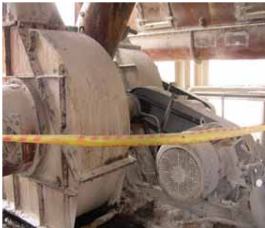
勞工罹災於3號機排氣機馬達上
