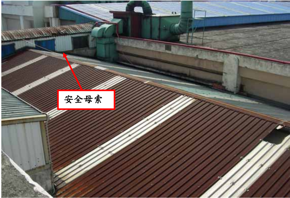
照片 4：菲勞踏穿採光塑膠浪板墜落現場(四)
