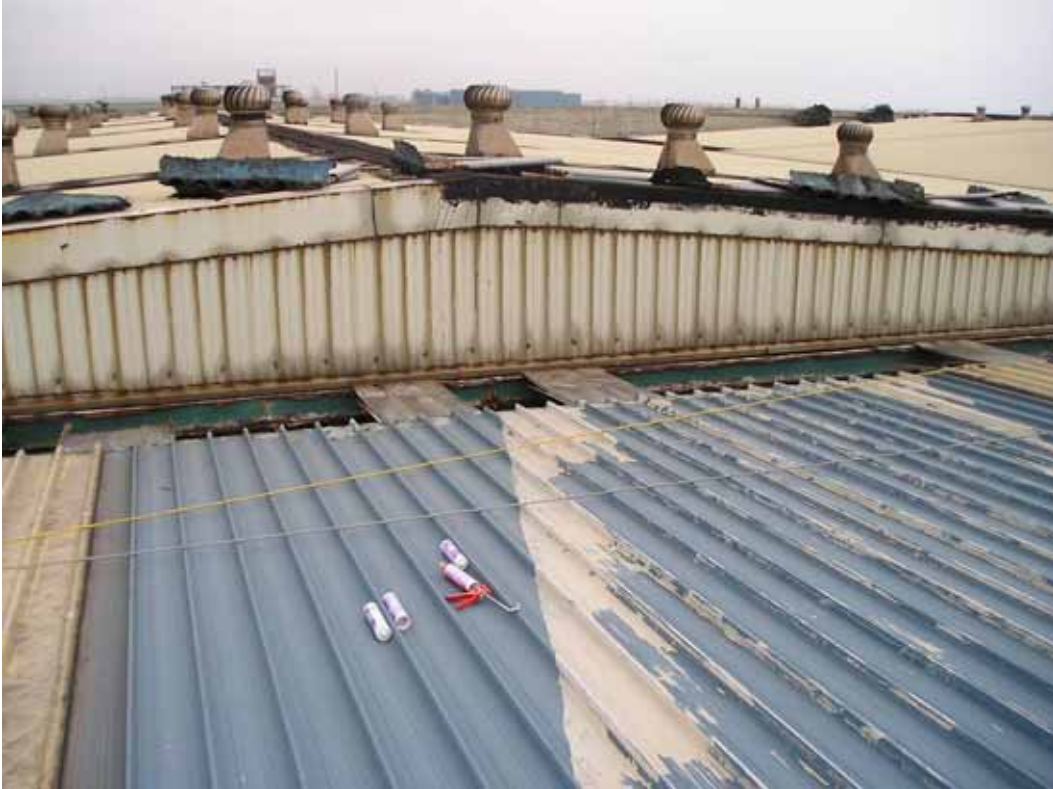
照片 2：本職業災害案工作現場，上方為舊浪板板尾
