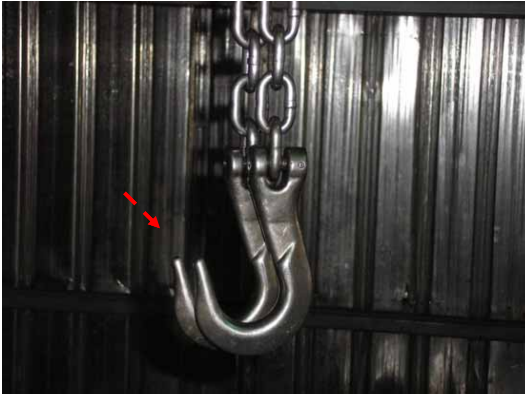
相片 2：大吊鈎下方之小吊鈎無防物體脫落之裝置
