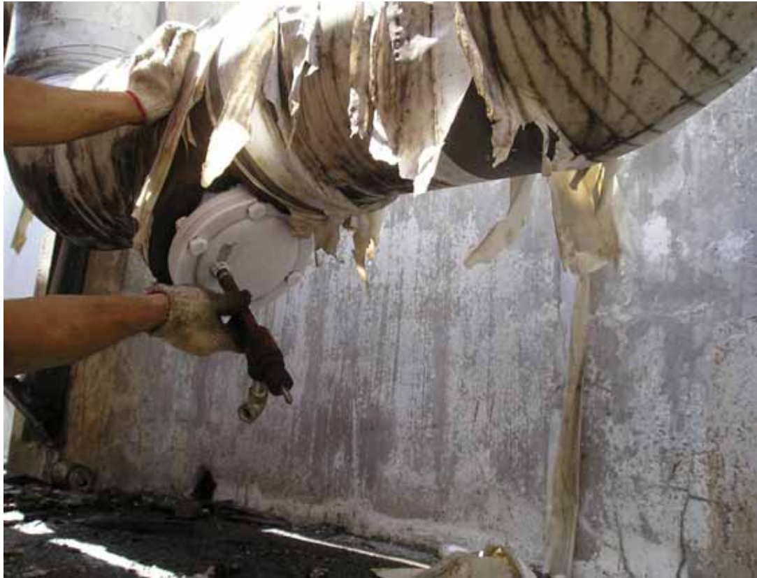
照片 1：由楊○○操作旋鬆螺絲，卓○○站在木梯上，突然間濾網面蓋飛出，造成氨洩漏
