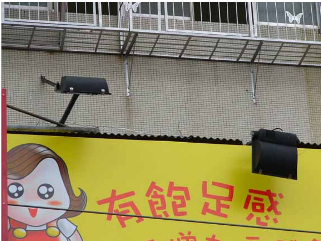
照片 1：高度約 9.6 公尺之 3 樓雨棚上投射燈近照，右側投射燈支撐用鐵架已被拉下
