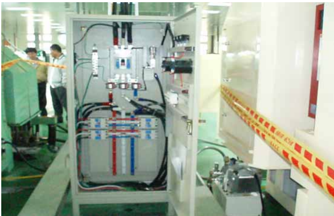
照片 3：配電箱寬度 80 公分高 180 公分，門已打開，中隔板已拆除， 內部銅排裸露，易造成感電
