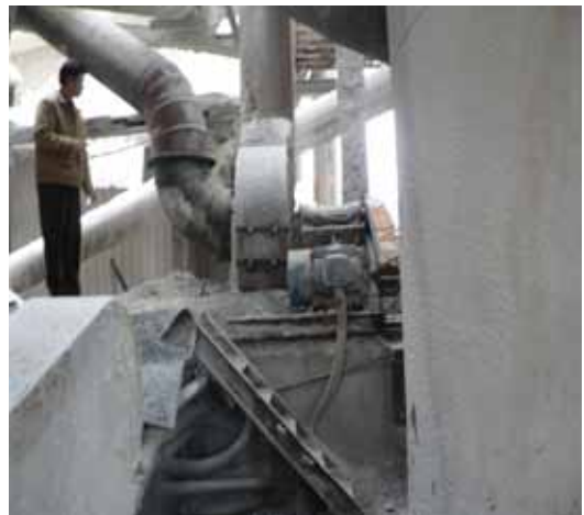
鄰近排氣機馬達軸封不良洩漏廢氣
