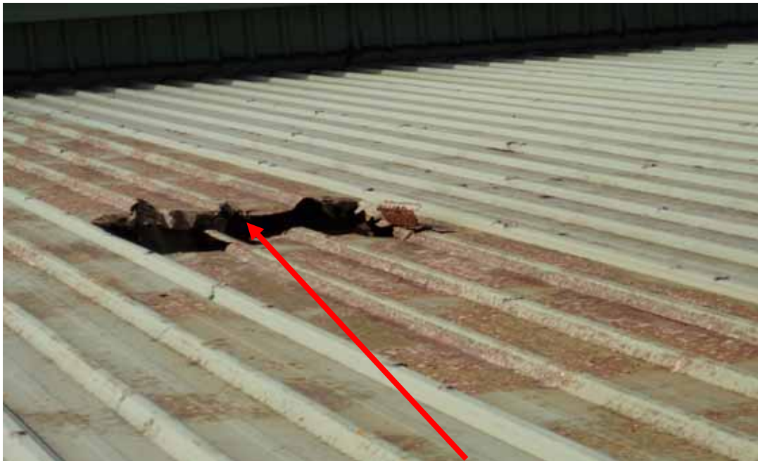
照片 2：該廠房屋頂為鐵皮屋且有銹蝕，踏破之處為長約 30 公分寬約 40 公分，距離地面約 10 公尺，且未設置安全母索，及鋪設寬度 30 公分以上之踏板
