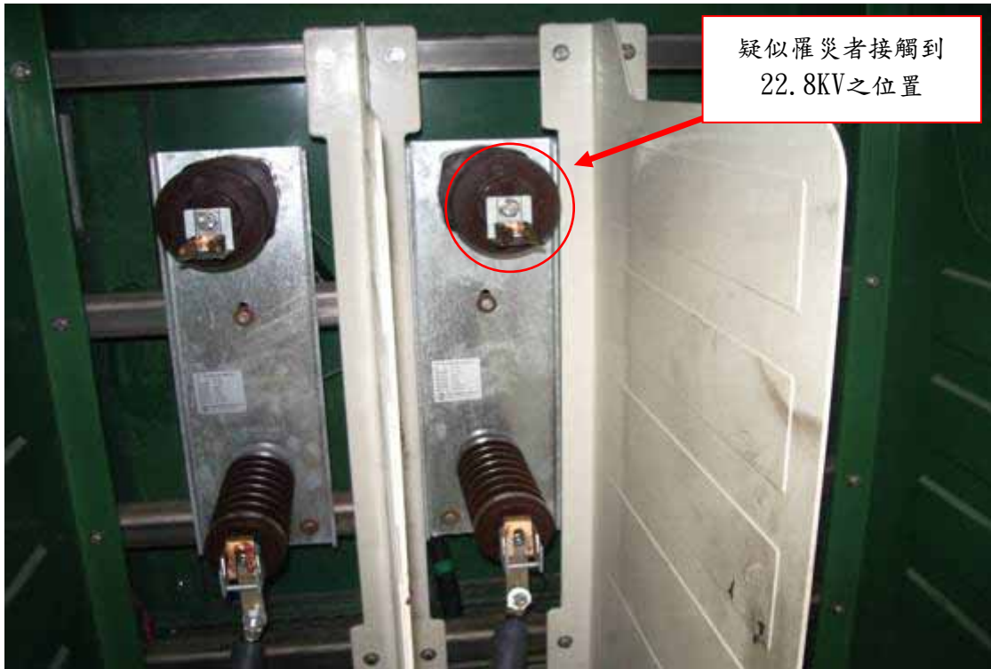
照片 1：事故當日罹災者疑似接觸到 22.8KV 之電源側之位置，上方並有燒焦之痕跡
