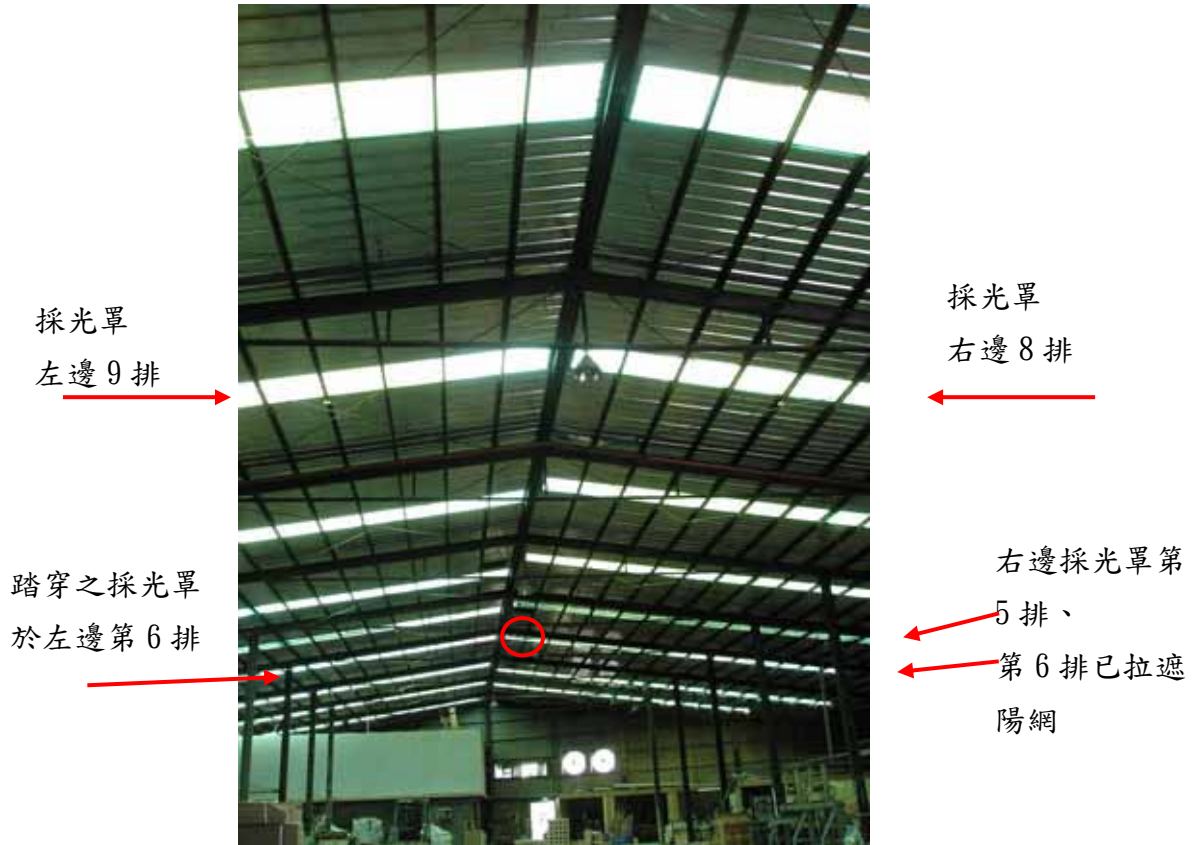
照片 1：該公司廠房屋頂烤漆板之塑膠採光罩從廠房大門算起共計有左邊 9 排，右邊 8 排塑膠採光罩，踏穿之採光罩於左邊第 6 排
