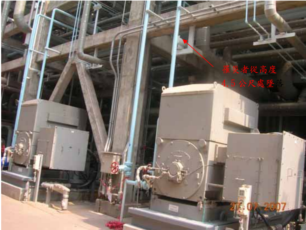
照片 1：災者從鍋爐 P2602A 與 P2602B 之間上方管架墜落，墜落點離地約 4.5 公尺
