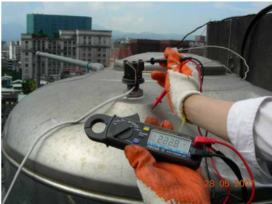
照片 2：9 樓水塔自動開關接點與水塔外殼(接地)之電壓為 220V
