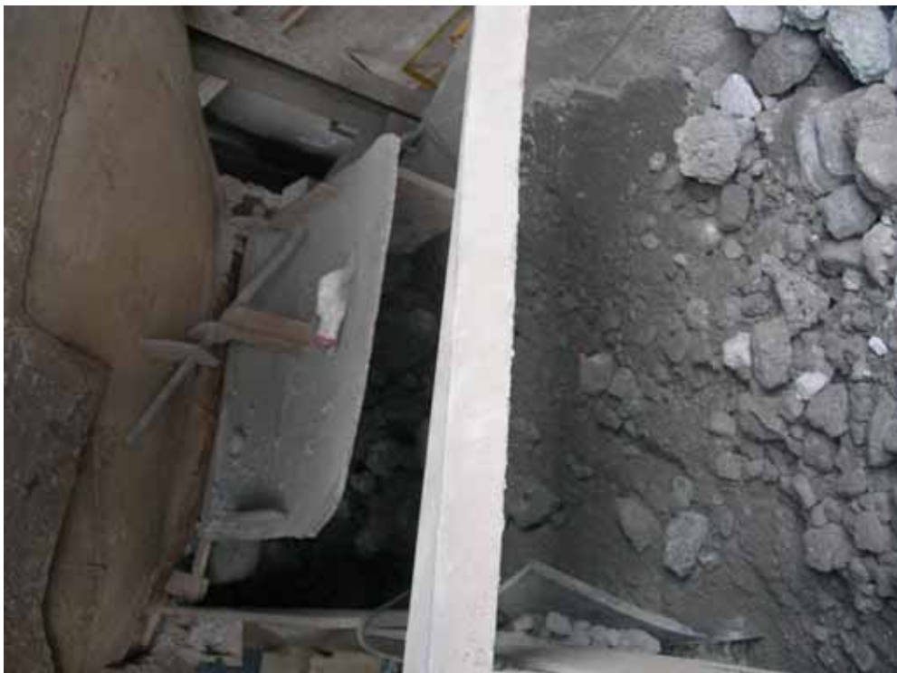
照片 2：罹災者料斗內清除爐石位置及附著於斗壁之爐石
