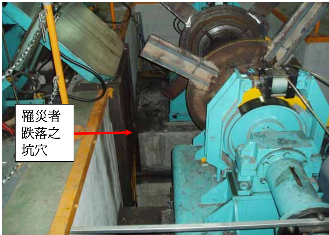
照片 2：坑穴長 140 公分、寬 37 公分、深 60 公分，罹災者跌落於此處，頭部撞擊坑穴上緣而死亡
