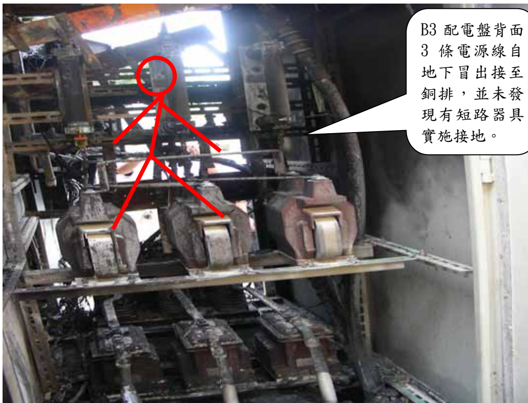
照片 2：傷者△△△於 B3 配電盤背面站在配電盤角鐵上更換礙子
