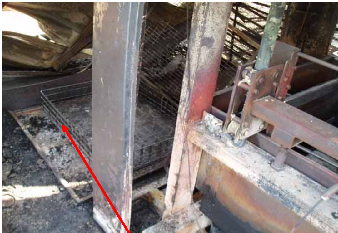
照片 4：2 號超音波清洗機後側板均往外翻，研判其內部曾產生爆炸所引起
