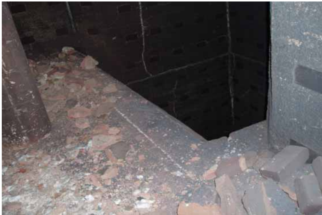
照片 2：欄杆至煙道口過遠(水平距離約 1.4 公尺)，造成勞工誤判可站立此處，煙道口四週並未設置圍欄或覆蓋
