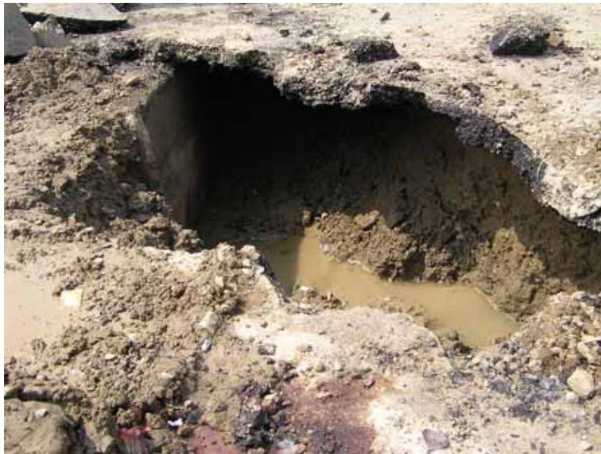
照片 2：災害發生之開挖處
