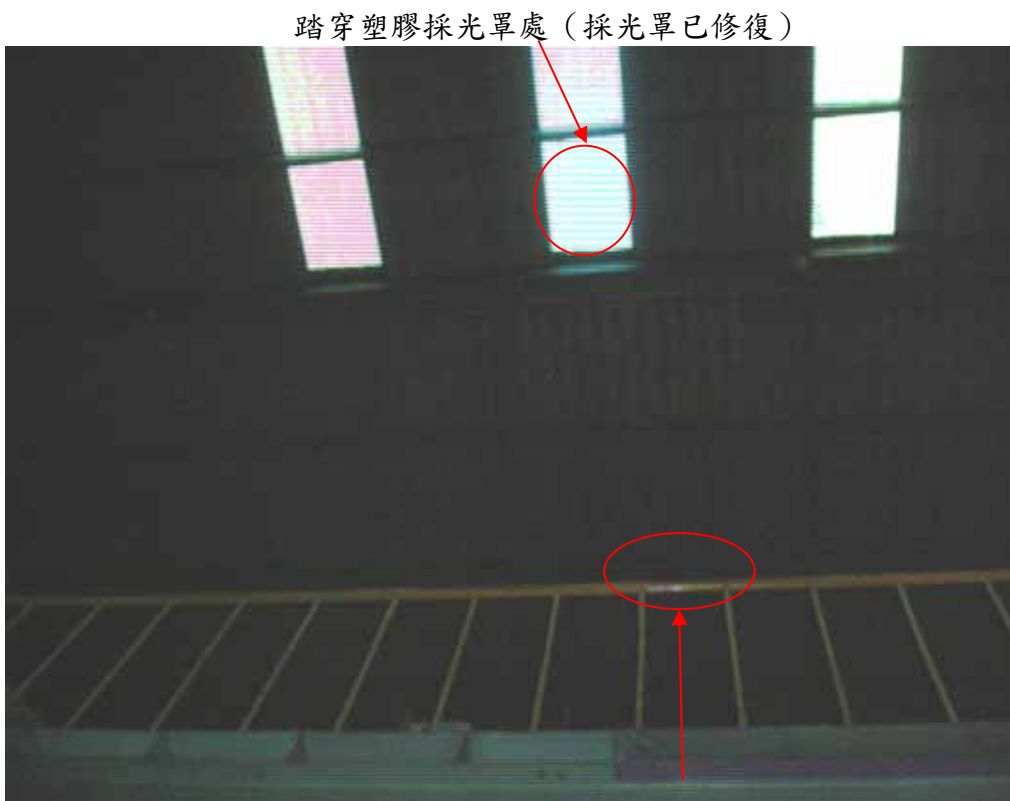
照片 1：二樓欄杆擦撞處
