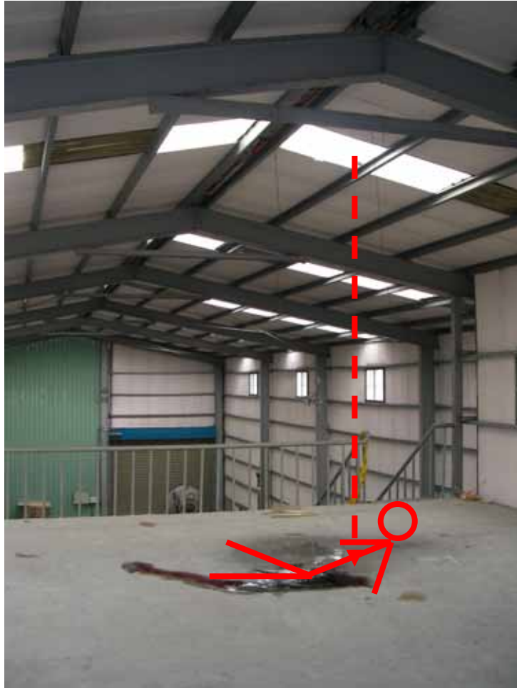
照片 2：研判罹災者自距夾層地面 3.7 公尺高之屋頂踏穿採光罩墜落致死。(周圍散落採光罩碎片)
