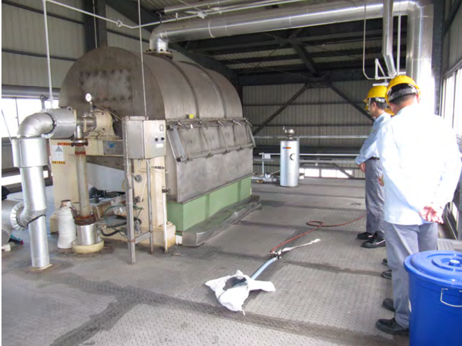
照片 1；3 樓製片機旁樓地板留有罹災者使用接用氮氣之輸氣管頭罩。
