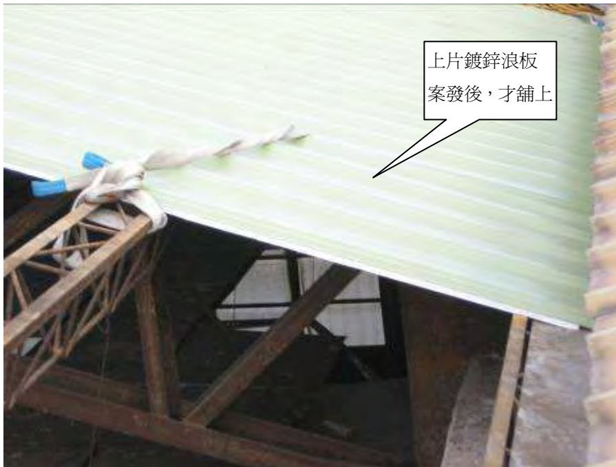
照片 1 李○○從屋緣高 11.97 公尺處經踏穿輕鋼架石膏板處墜落，上方鍍鋅浪板為李○○墜落後才舖上（當時罹災者尚未死亡）
