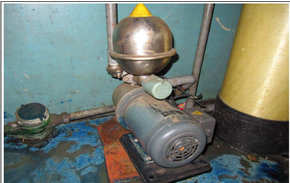
照片 2 瑞源電鍍有限公司廠內通往 2 樓樓梯口地板面之純水機加壓馬達
