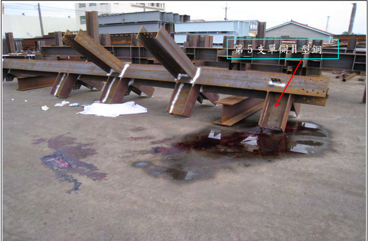
說明 1 鋼構倒塌方向往單側焊接 H 型鋼方向倒下，下側第 5 支 H 型鋼處地面附近有積水，另單側第 5 支 H 型鋼與地面接觸處殘留罹災者血液
