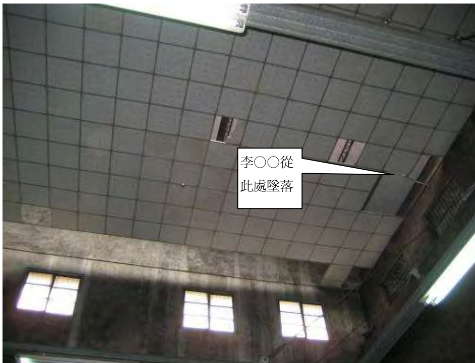
照片 2 災者從屋頂踏穿輕鋼架石膏板之情形
