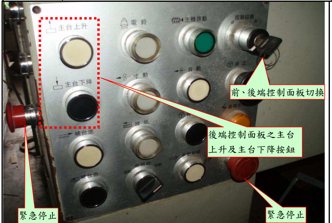
照片 說明 3：肇災平軋機之後端控制面板設於如照片 1 之右側柱上，該面板上鑰匙切換於前端，並設有主台上升、主台下降按鈕及 2 只緊急停止按鈕，肇災當時小組長陳○○並未於後端啟動，而係於平軋機之前端控制啟動。
