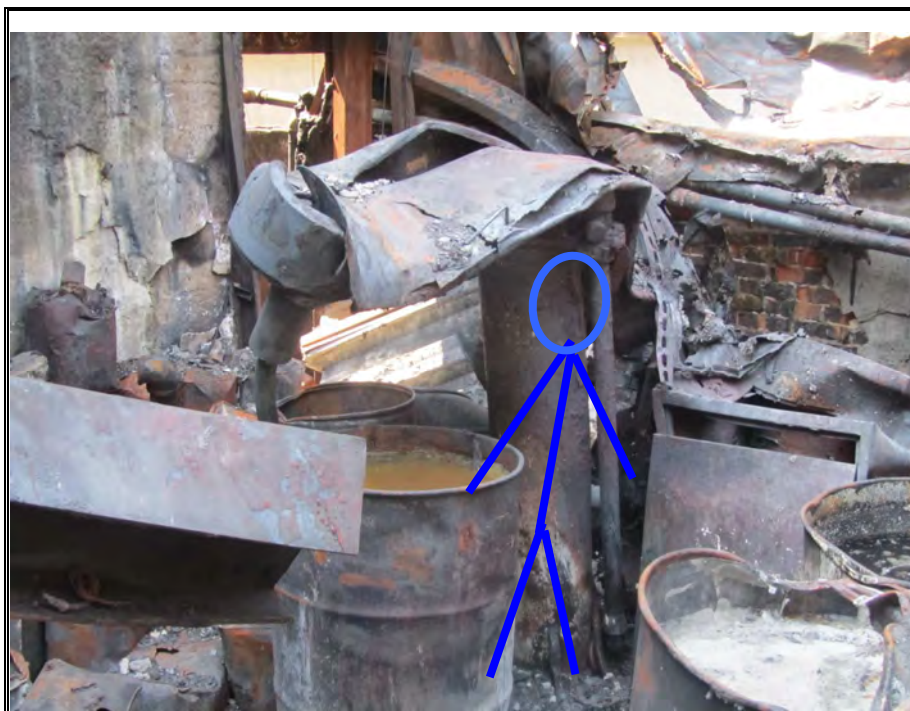
(附照 1) 有 1 部 1 號攪拌機高約 2 公尺、長約 1.5 公尺、寬約 1.2 公尺，由 220 伏特 5 馬力馬達驅動。
