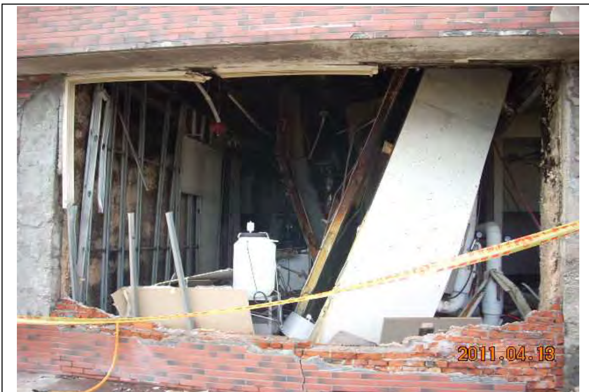
照片說明 災害現場情形
