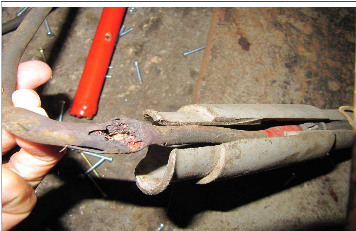
照片 肇災現場電纜線被覆層破裂及導線外露之實際照片
