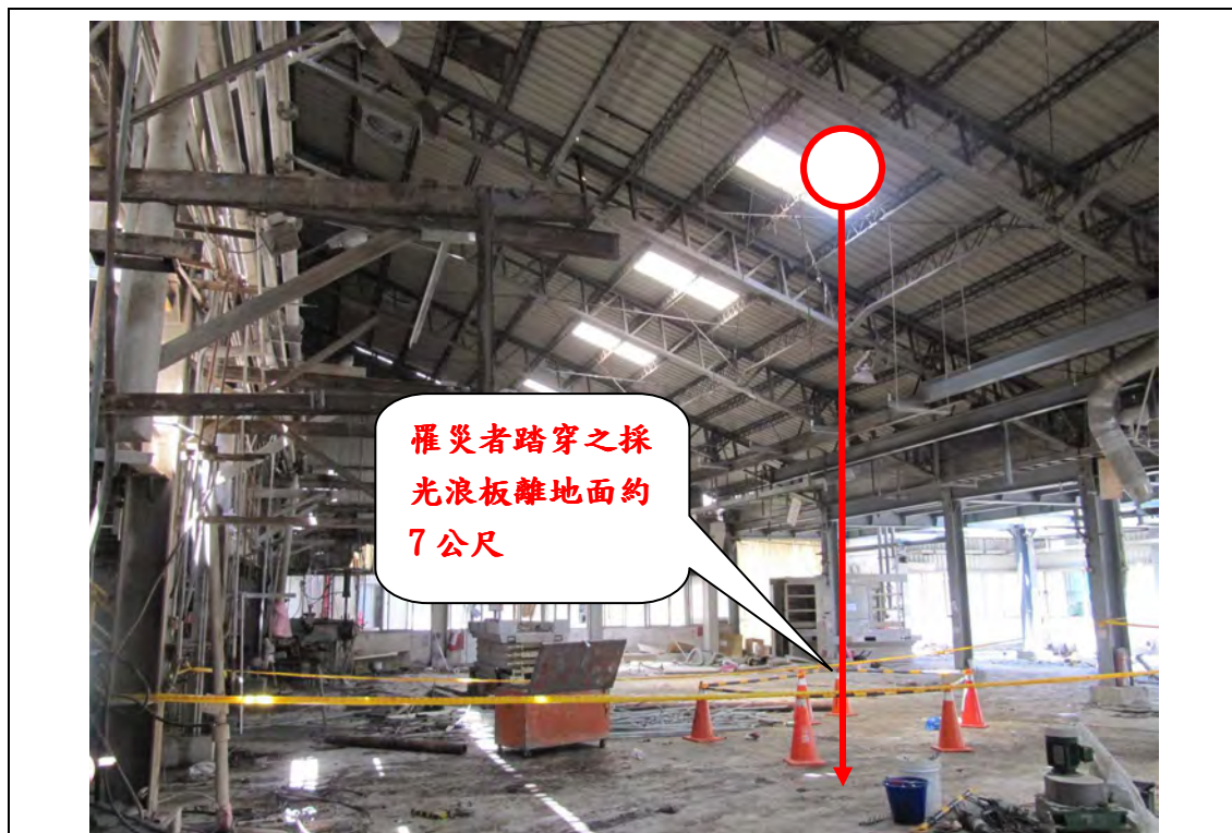
說明 照片 2 罹災者墜落位置離地面高度約 7 公尺。
