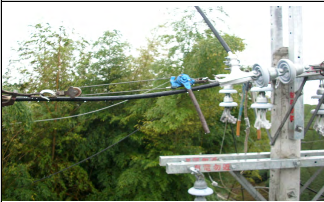
照片 災害現場
