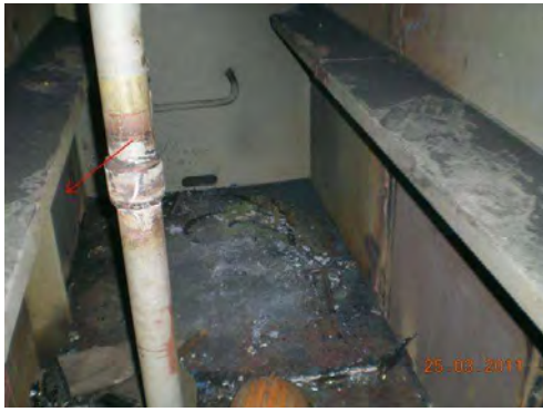
箭頭所指處為事故現場實施電焊作業之處所。
