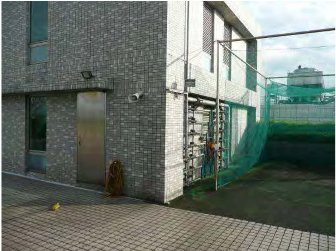
原吊籠安裝位置位於屋突後方，繞過屋突到達移機架設 F 型支架位置
