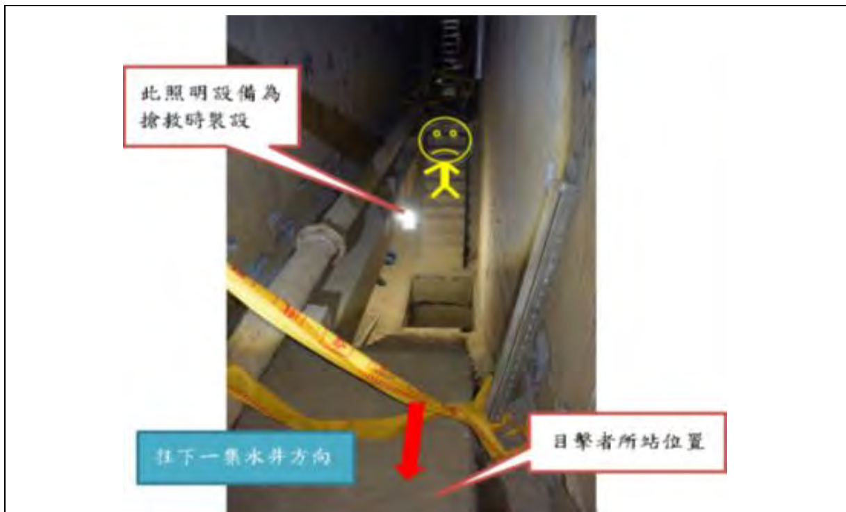
說明三 罹災者王正男當日走下樓梯，因現場照明不足，失足墜落下方集水井。
