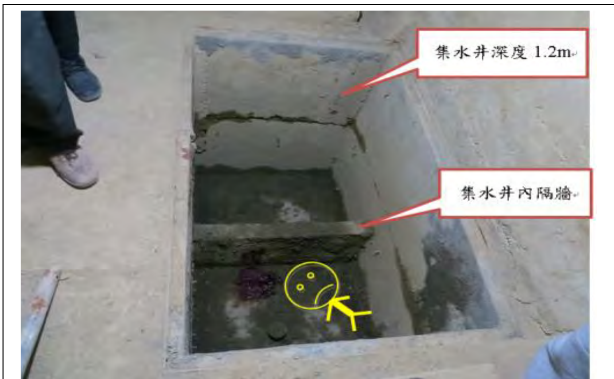
說明四 罹災者王正男當日墜落集水井，後腦撞擊集水井內之隔牆。
