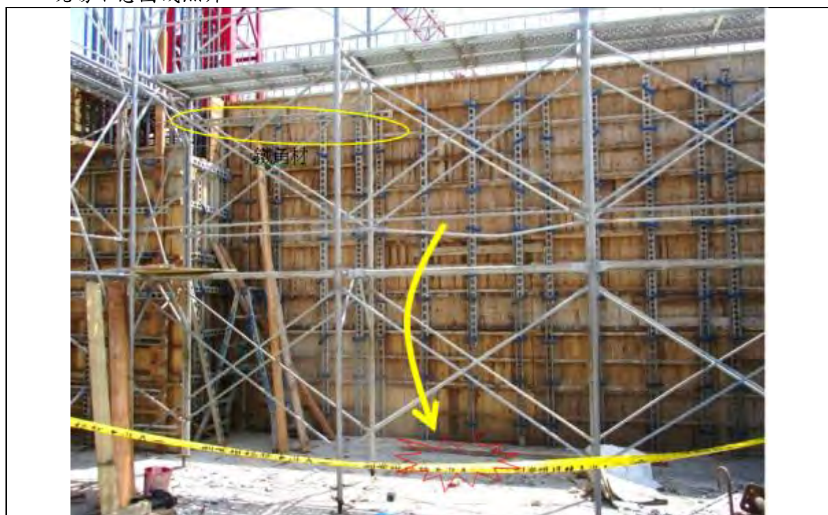
說明一 罹災者於 B 棟地上 2 樓隔間牆施工架墜落地面。
