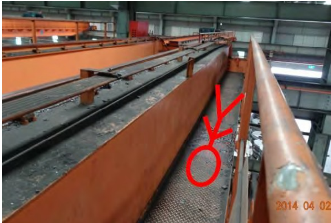
罹災者遭固定式起重機破裂之剎車尾蓋破片擊中倒在固定式起重機維修走道。
