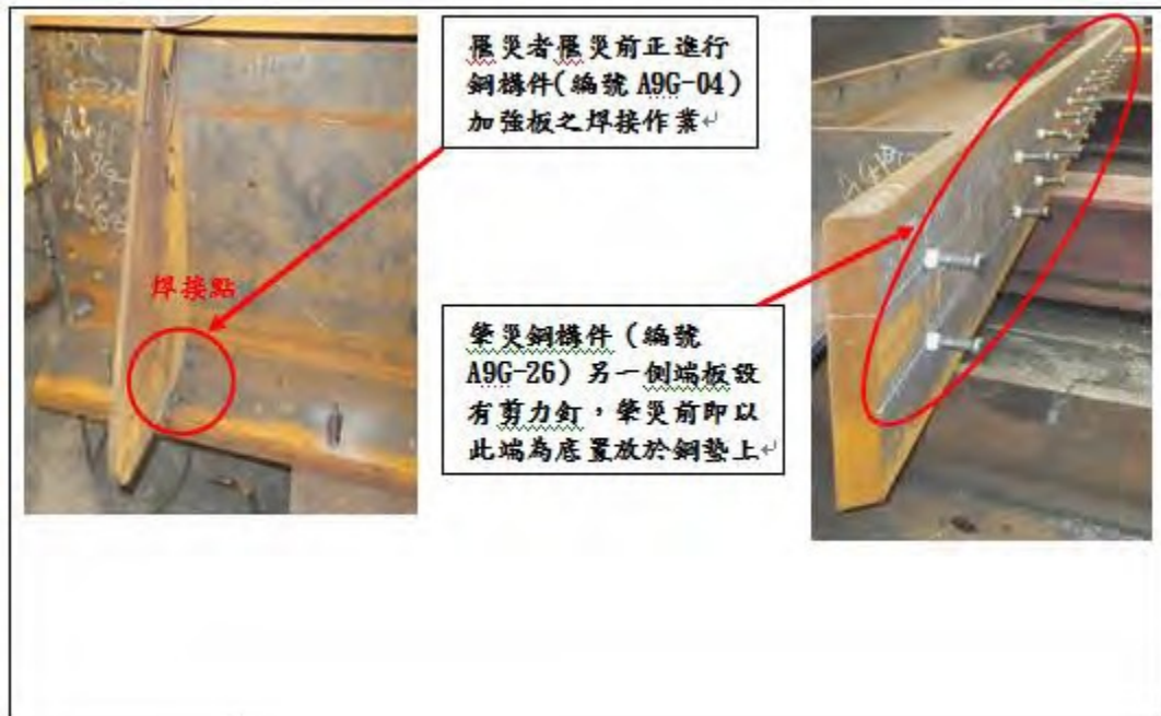
照片 1 鋼構件(編號 A9G-04)加強板焊接點及肇災鋼構件(編號 A9G-26)另一側端板設有剪力釘情形(示意圖)。
