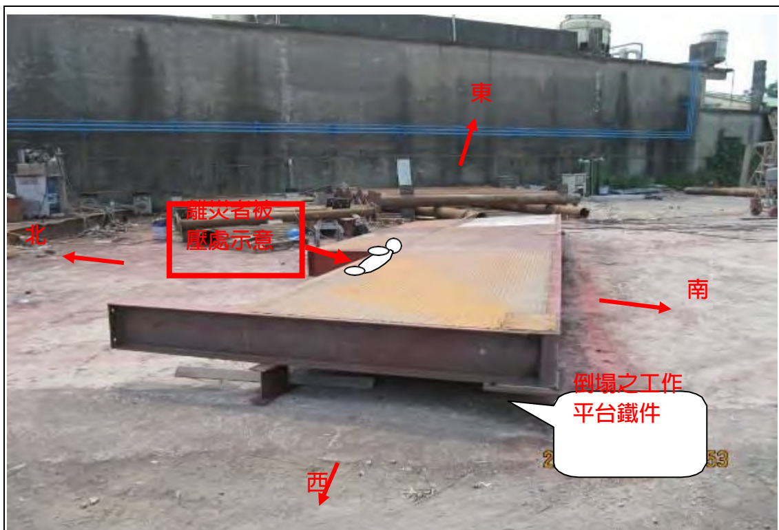
說明 照片1：災害發生後倒塌之鐵件已倒塌於地面概況及罹災者遭被壓於鐵件之位置於照片中以紅色文字加註示意。
